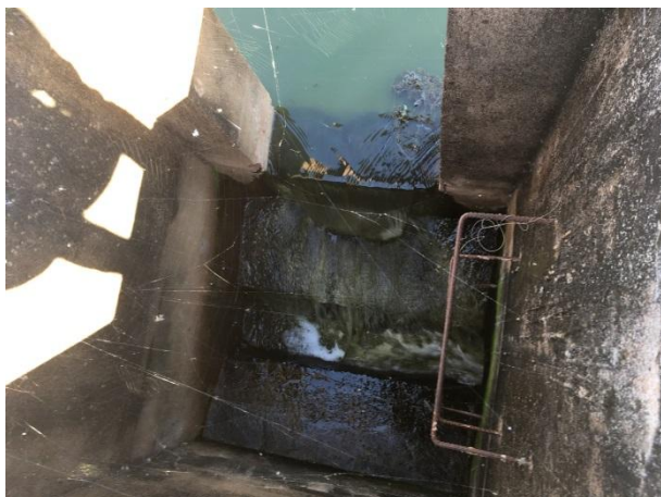
Foto 3.31 – Saída do efluente tratado
