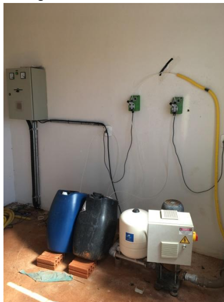
Foto 3.11 – Bombas dosadoras – CDHU 2
