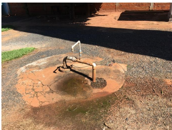
Foto 3.1 – Poço 700 (P2) – DAERP
