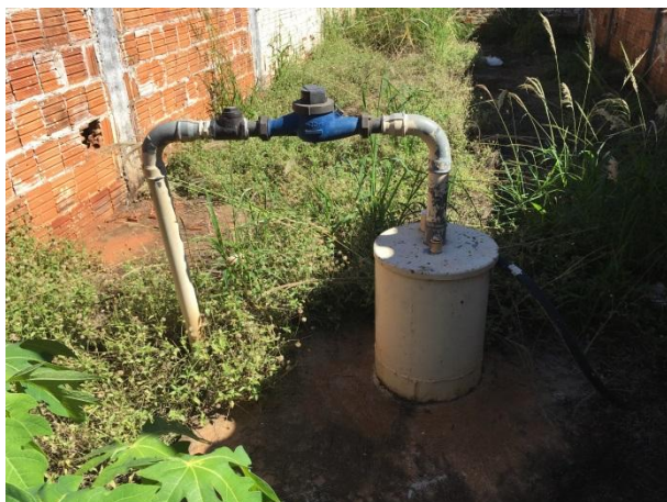
Foto 3.3 – Poço 702 (P3) – Ângelo
