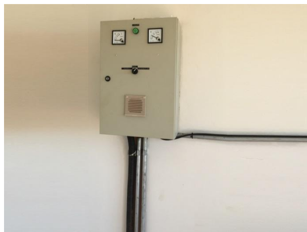
Foto 3.15 – Painel eletrônico de controle – CDHU2
