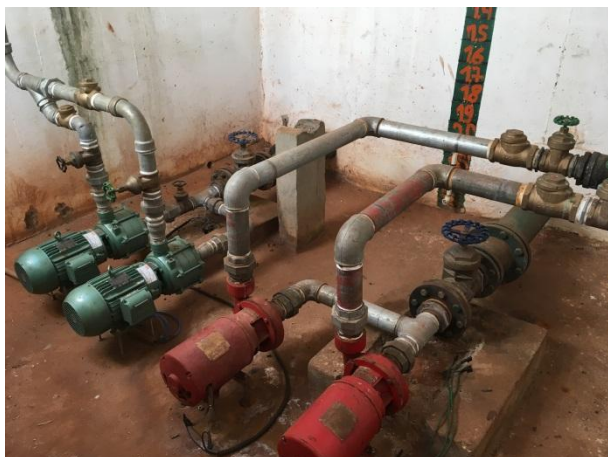
Foto 3.12 – Conjuntos motor-bomba de recalque
