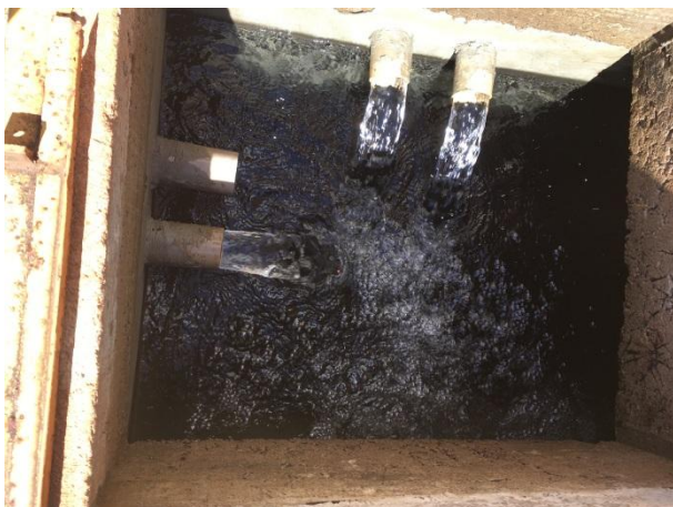
Foto 3.7 – Caixa de areia recebendo a contribuição dos poços - DEARP
