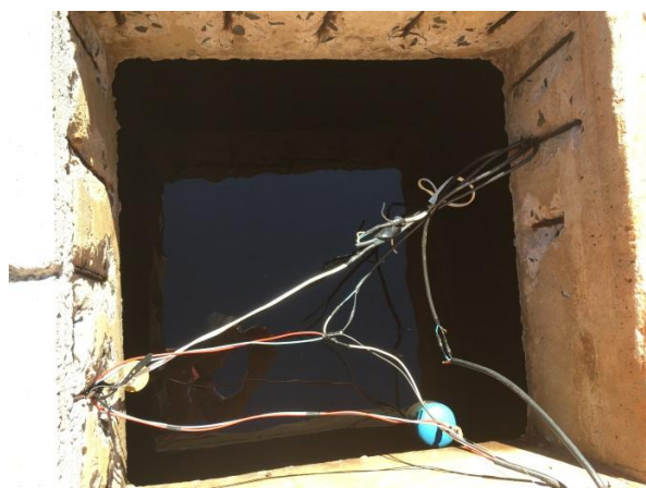
Foto 3.17 – Boia de nível do reservatório
