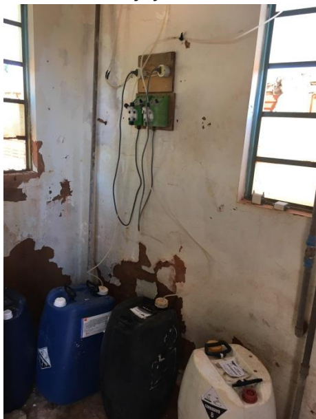
Foto 3.10 – Bombas dosadoras - DEARP
