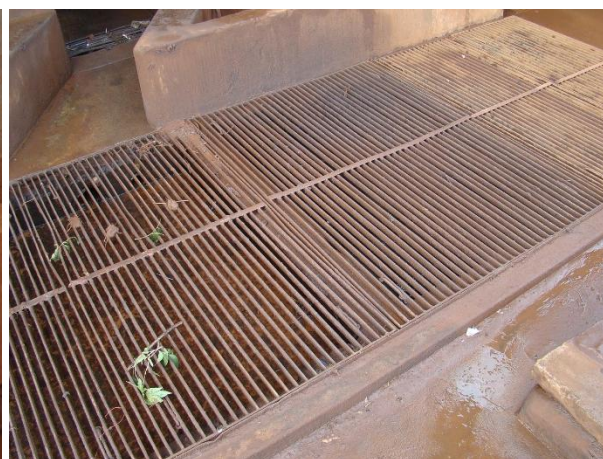
Foto 72. Decantador de óleo da Garagem Municipal.
