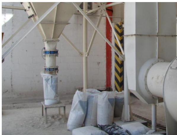
Foto 59. Sistema de limpeza de exaustores e armazenamento do pó coletado.
