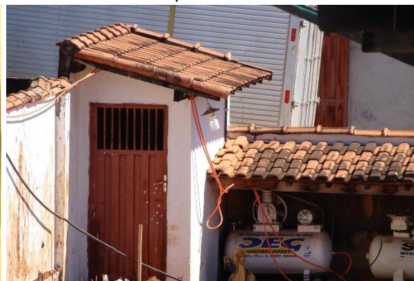
Foto 34. Transbordo dos resíduos da saúde no U.B.S. Centro (porta inadequada).
