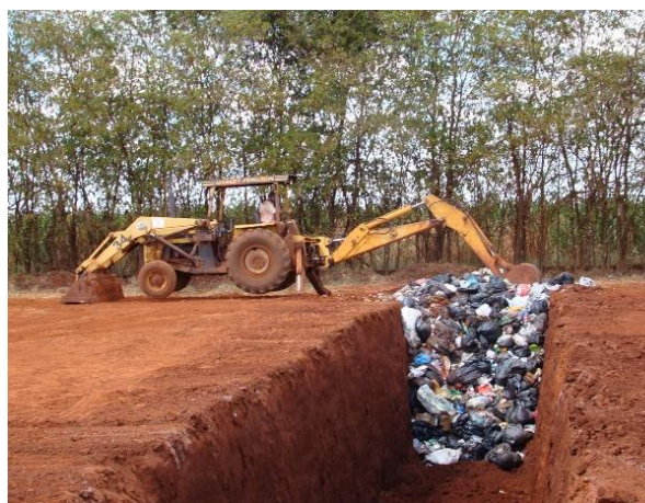
Foto 11. Resíduos acomodados e sendo comprimidos pela retroescavadeira.
