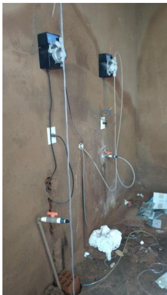
Foto 3.21 – Vista das bombas dosadoras de Cloro e Flúor do poço P10
