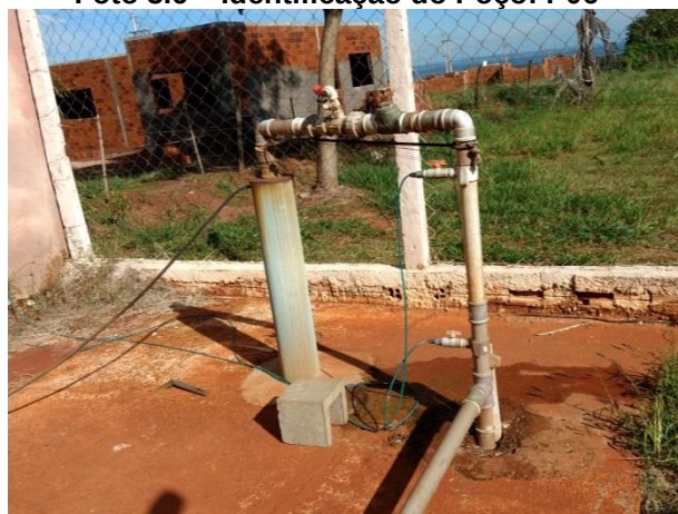
Foto 3.8 – Identificação do Poço: P08
