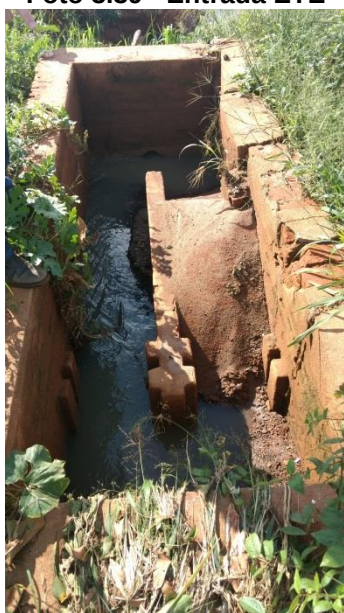
Foto 3.41 - Caixa de Areia
