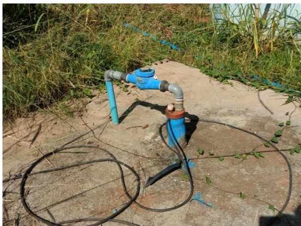
Foto 3.13 – Identificação do Poço: P12
