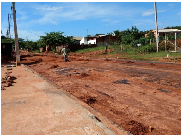
Foto 3.61 – Avenida Engenheiro Abraão Leite (após uma chuva forte)
