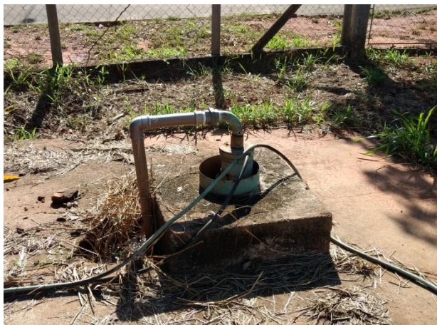
Foto 3.5 – Identificação do Poço: P05
