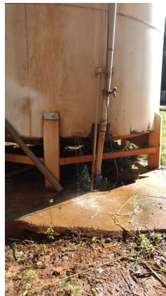
Foto 3.27 – RAP-05: Detalhe do vazamento
