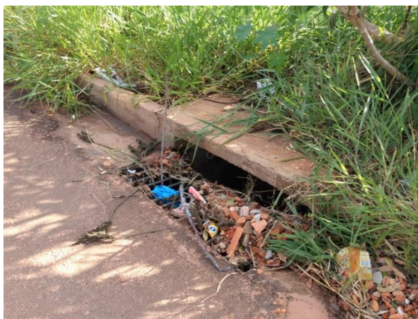
Foto 3.82 – Rua sem denominação (boca de lobo obstruída)
