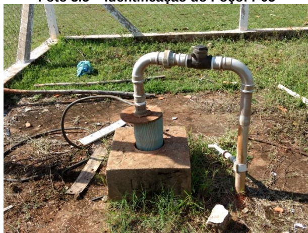
Foto 3.7 – Identificação do Poço: P07
