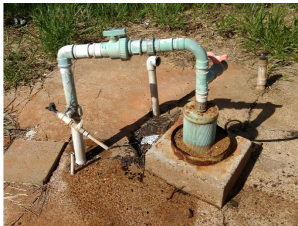
Foto 3.6 – Identificação do Poço: P06
