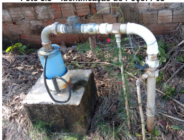
Foto 3.10 – Identificação do Poço: P10
