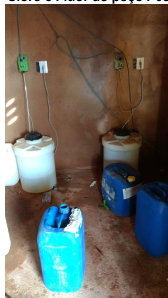
Foto 3.20 – Vista das bombas dosadoras de Cloro e Flúor do poço P08
