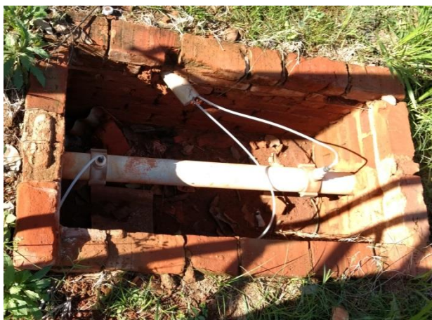
Foto 3.17 – Local da adição de Cloro e Flúor dos poços P01 e P02
