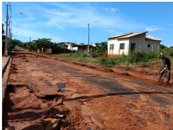
Foto 3.62 – Avenida Engenheiro Abraão Leite (após uma chuva forte)
