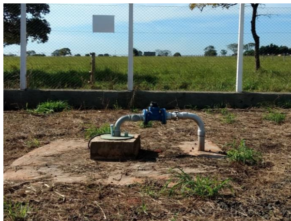
Foto 3.14 – Identificação do Poço: P13
