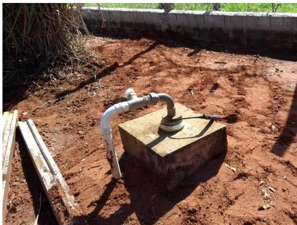
Foto 3.11 – Identificação do Poço: P11
