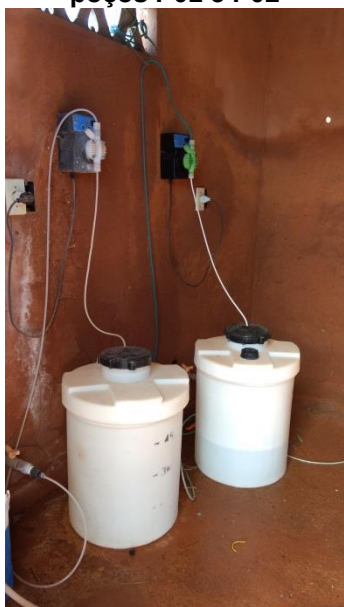
Foto 3.19 – Vista das bombas dosadoras de Cloro e Flúor do poço P07
