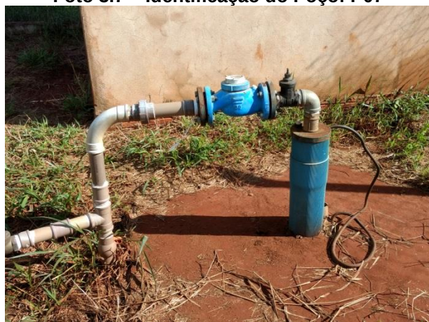
Foto 3.9 – Identificação do Poço: P09
