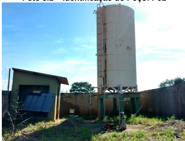
Foto 3.3 – Identificação do Poço: P03
