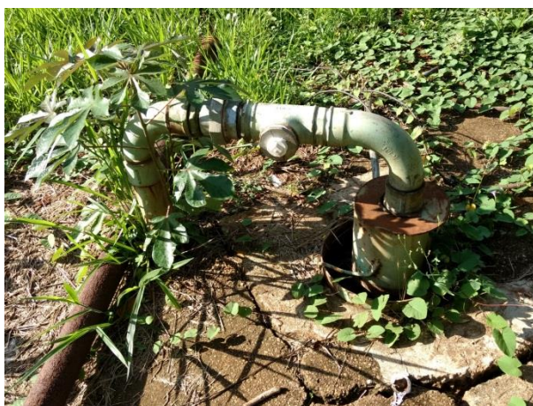
Foto 3.1 – Identificação do Poço: P01
