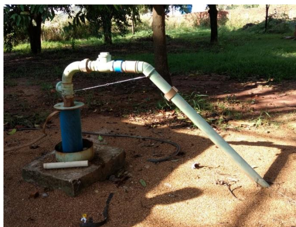
Foto 3.2 – Identificação do Poço: P02
