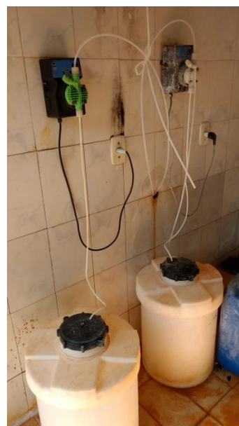
Foto 3.18 – Vista das bombas dosadoras de Cloro e Flúor do poço P05
