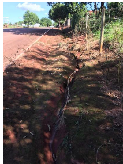
Foto 3.4 – Início de erosão próxima ao córrego
