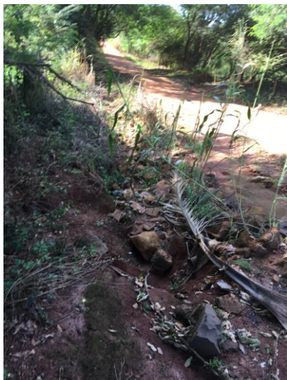
Foto 3.3 – Início de erosão próxima ao córrego
