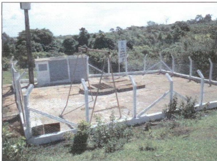
Foto 25 - Estação elevatória 03 (EEE 03)
