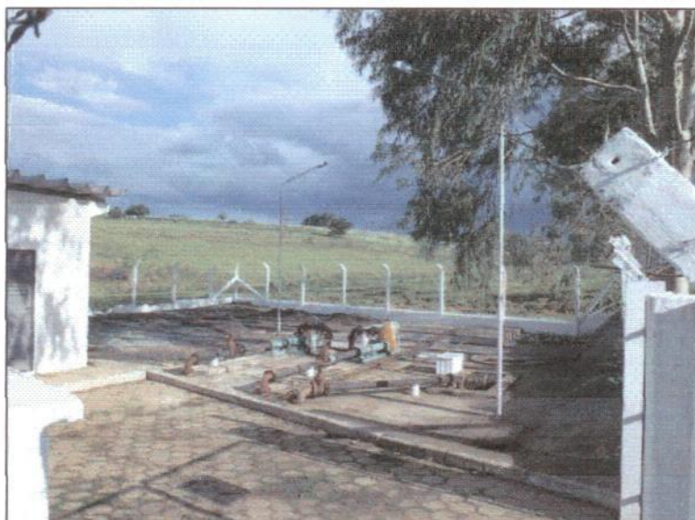
Foto 26 – Estação elevatória 04 (EEE04)
