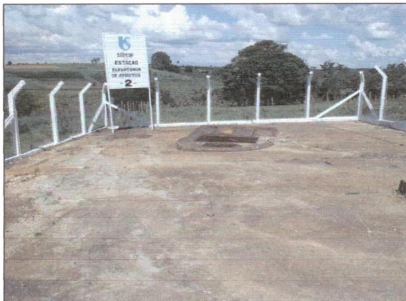
Foto 24 - Estação elevatória 02 (EEE 02)
