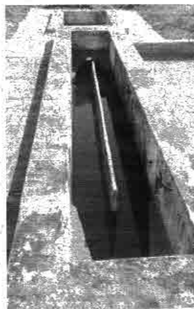
Foto 3.10 – Caixa de Areia
