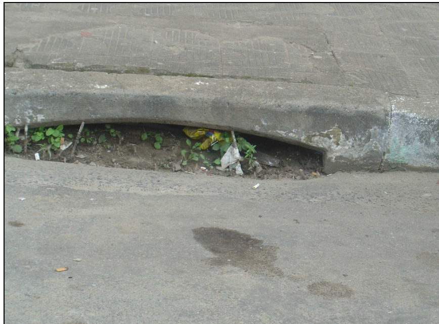
Foto 2 - Boca de Lobo Entupida e Sem Manutenção
