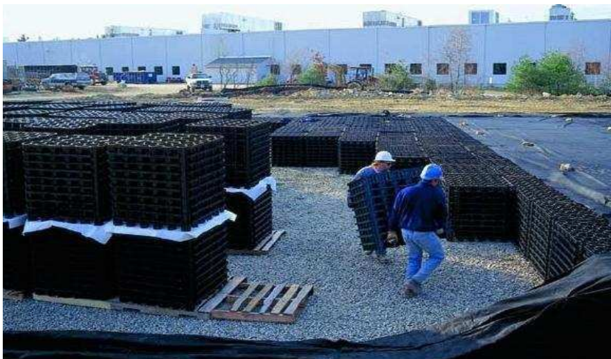
Figura 14. Reservatório de detenção enterrado.
