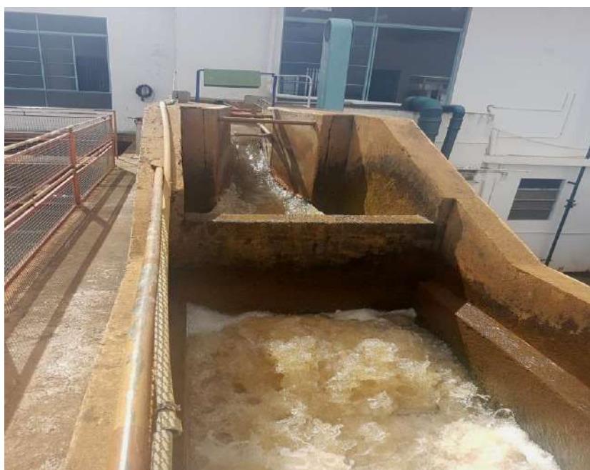
Figura 25 - Mistura Rápida - Calha Parshall na chegada da ETA
