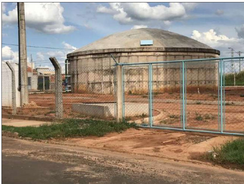
Figura 47 - Reservatório semi enterrado do Lago – 1.000 m 3
