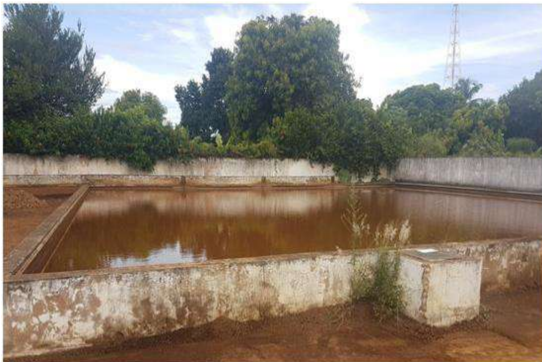
Figura 29 - Módulo para decantação das águas de serviço da ETA
