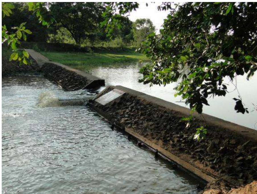
Figura 16 - Regulador de Nível da Captação
