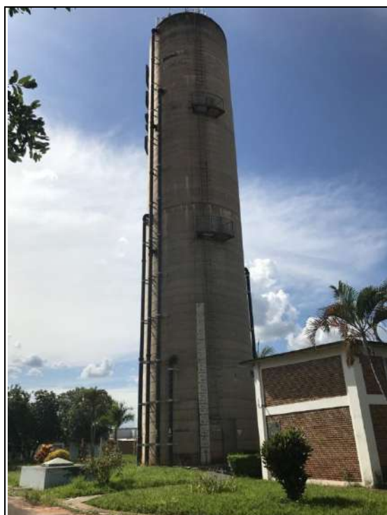
Figura 40 - Reservatório elevado do Jd. Pevi – 600 m 3
