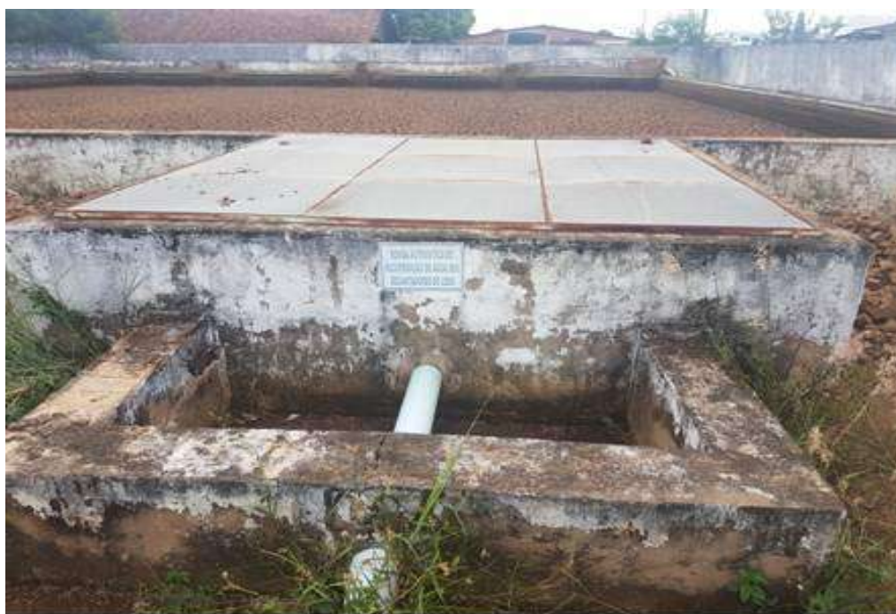
Figura 30 - Estação elevatória do efluente percolado
