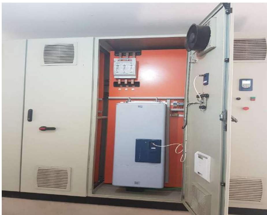
Figura 24 - Painéis Elétricos da Elevatória
