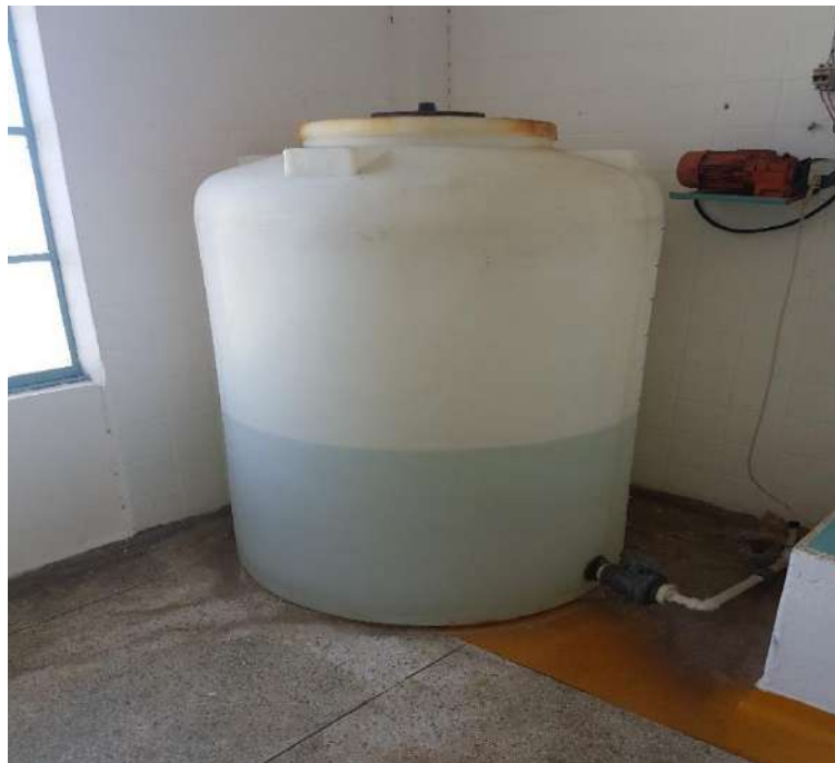
Figura 33 - Armazenamento de Produtos Químicos
