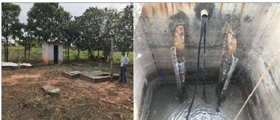
Figura 50 - Estação Elevatória de Esgotos Silvia Covas
