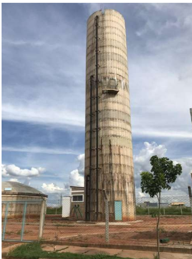
Figura 46 - Reservatório elevado do Jd. do Lago – 600 m 3
