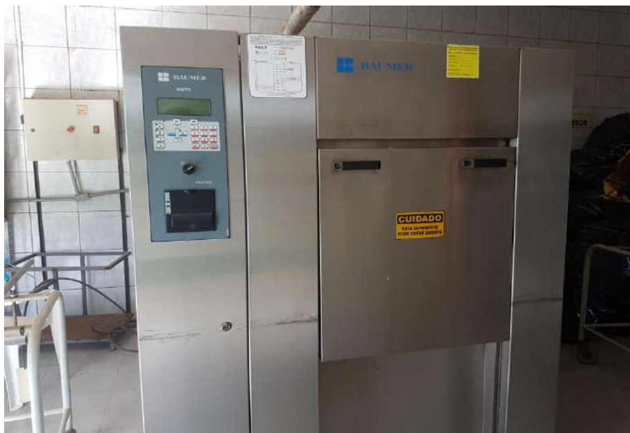
Figura 71 - Autoclave da Central de Tratamento de Resíduos
