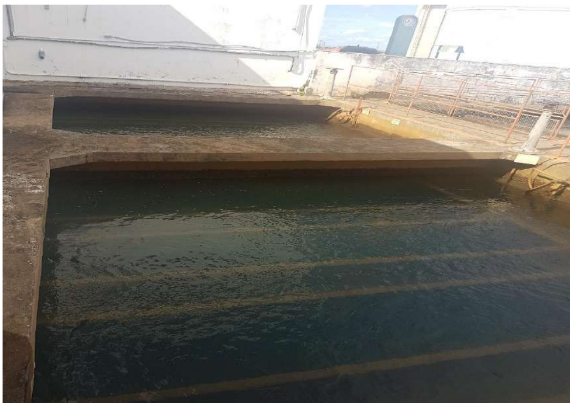
Figura 28 - Filtros da ETA
