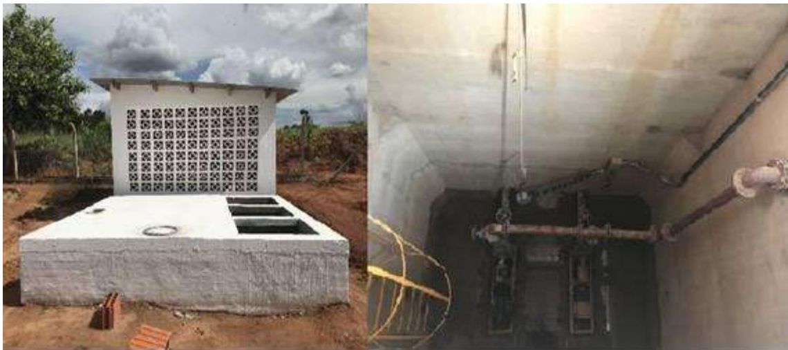
Figura 49 - Estação Elevatória de Esgotos Res. Flávia
