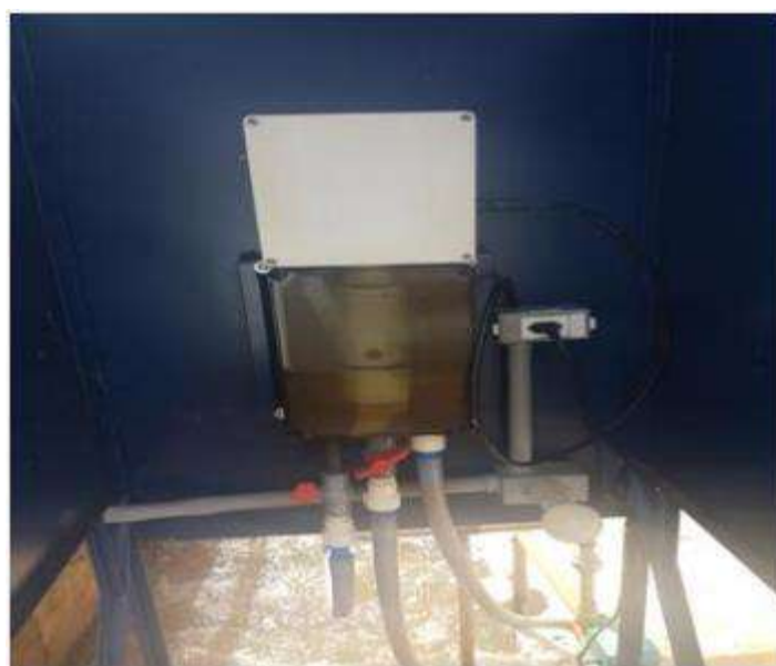
Figura 34 - Dosagem de produtos químicos.
