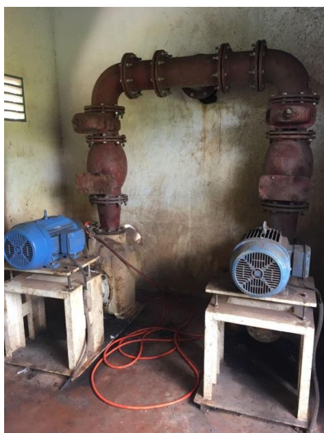
Foto 3.52 – Vista dos conjuntos motor-bombas
