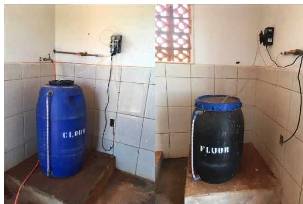
Foto 3.23 - Tratamento da água no Sistema 13
