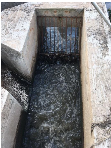
Foto 3.53 – Vista do gradeamento
