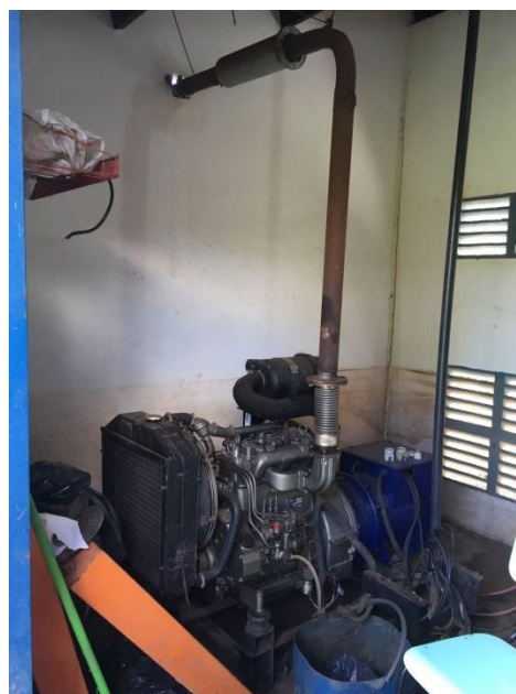
Foto 3.51 – Vista do gerador
