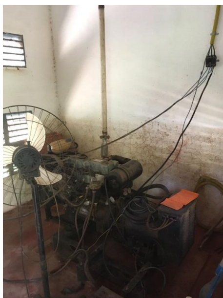
Foto 3.45 – Vista do gerador
