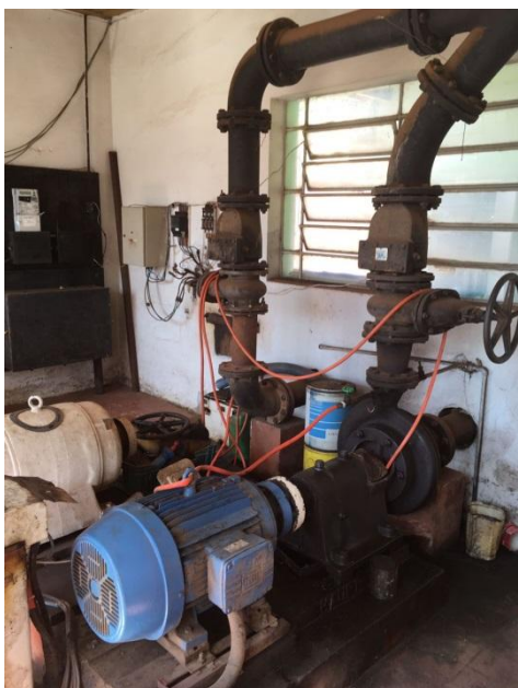
Foto 3.24 - Conjunto motor-bombas da EEA
