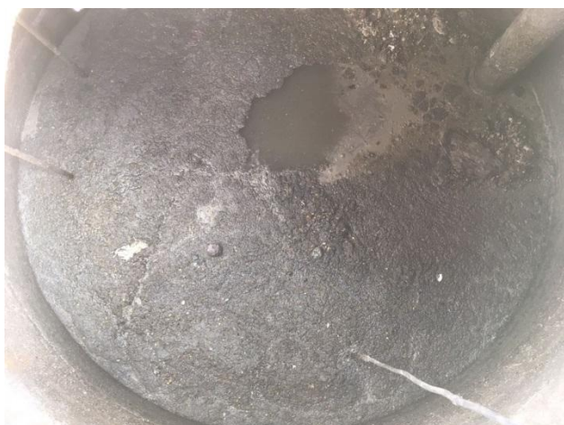
Foto 3.50 – Vista do Poço de Sucção
