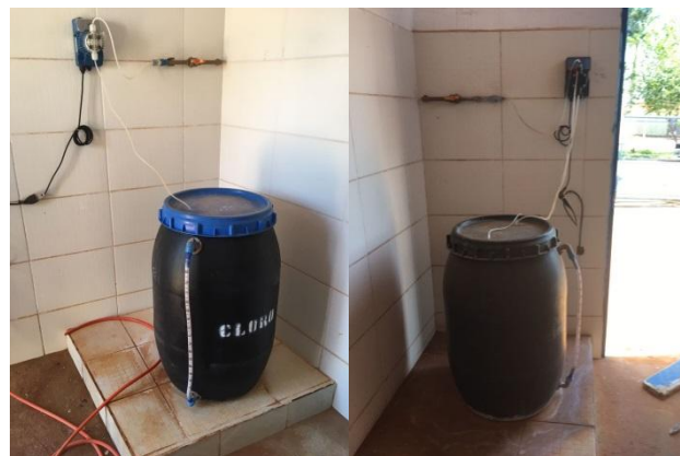
Foto 3.19 - Tratamento da água no Sistema 6
