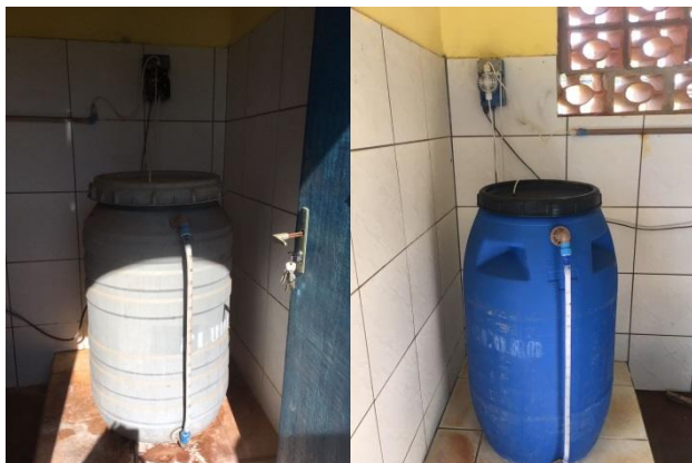
Foto 3.16 - Tratamento da água no Sistema 1
