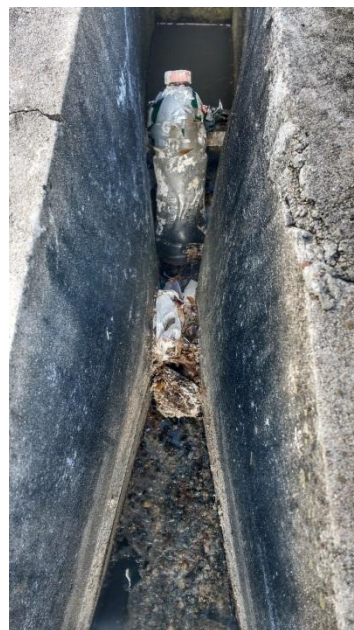
Foto 3.62 – Vista da calha Parshall com material obstruindo a passagem do esgoto
