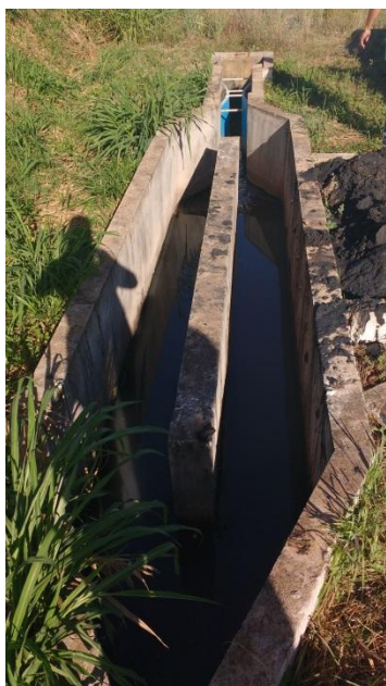
Foto 3.58 – Vista do Tratamento Preliminar
