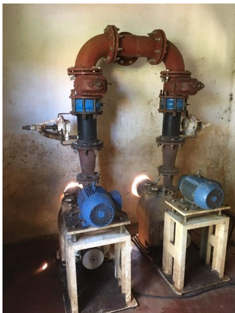
Foto 3.47 – Vista dos conjuntos motor-bombas
