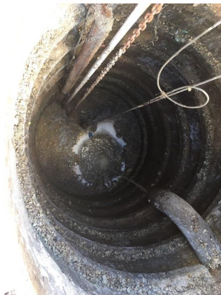
Foto 3.44 – Vista do Poço de Sucção
