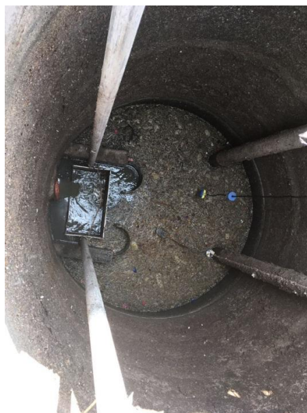
Foto 3.40 – Vista do Poço de Sucção
