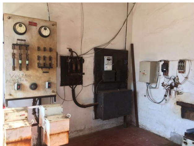
Foto 3.25 - Painelelétrico das bombas da EEA
