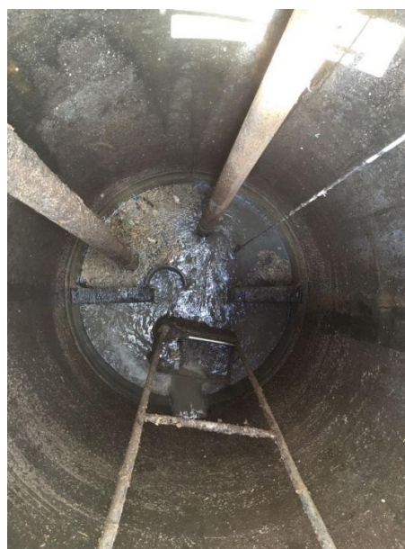
Foto 3.46 – Vista do Poço de Sucção
