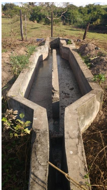
Foto 3.61 – Vista do Tratamento Preliminar
