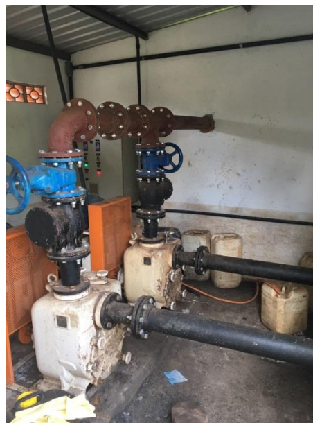
Foto 3.42 – Vista dos conjuntos motor-bombas
