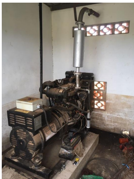
Foto 3.41 – Vista do gerador
