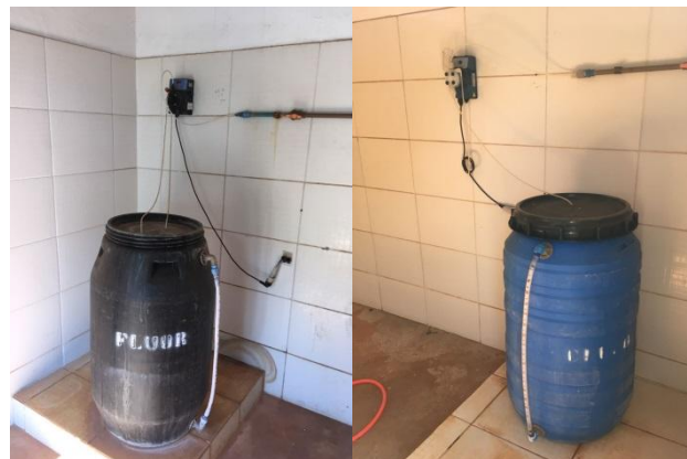
Foto 3.17 - Tratamento da água no Sistema 2
