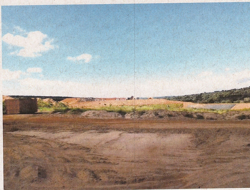
Aterro da empresa CGR Guatapar
