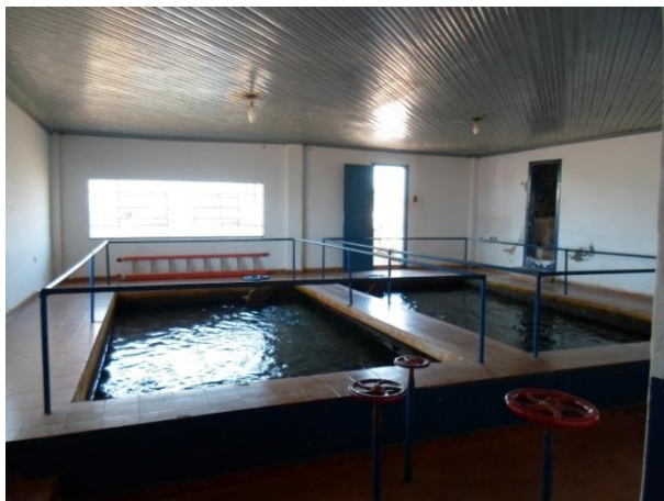
Foto 4.13 – Vista dos decantadores da ETA
