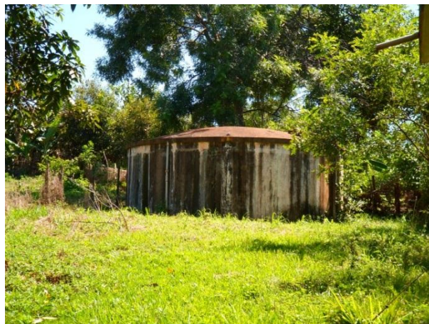
Foto 4.29 – Reservatório Semienterrado do Poço da Av. Saudade
