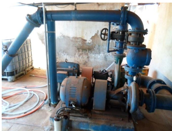
Foto 4.24 – Vista do Booster 1 (40 cv)
