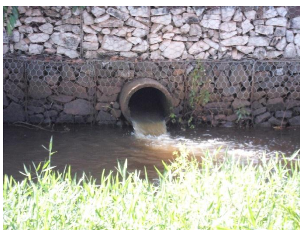
Foto 4.32 - Contribuição de esgoto no córrego Pitangueiras
