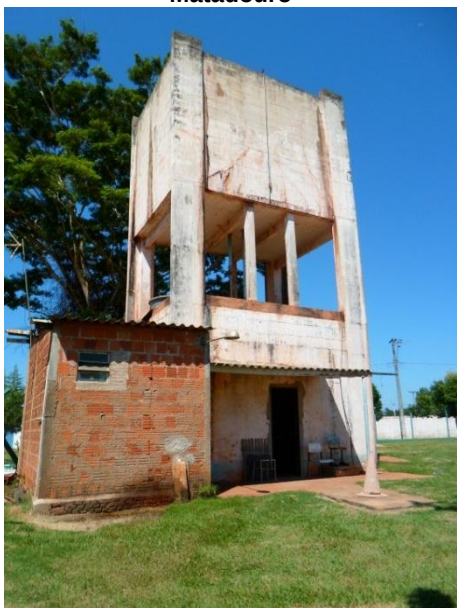
Foto 4.30 – Reservatório Elevado do Poço da Av. Saudade
