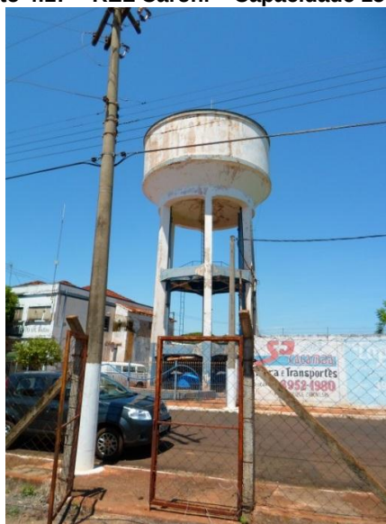
Foto 4.19 – REL Centro – Capacidade 250 m³
