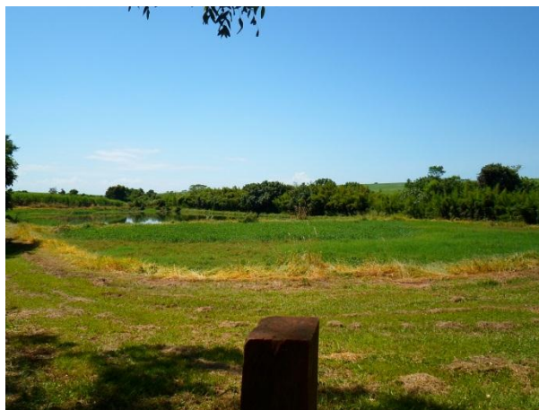
Foto 4.33 - Lagoas anaeróbias da ETE de Ibitiúva
