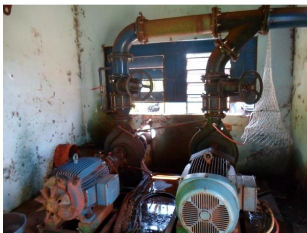
Foto 4.10 – Conjuntos Motobombas da EEAB
