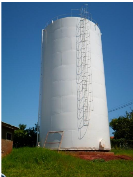
Foto 4.22 – RAP Jardim Leone – Capacidade 500 m³
