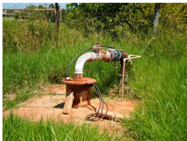
Foto 4.8 – Poço Jardim Leone
