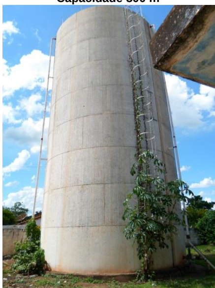
Foto 4.20 – RAP Santa Vitória – Capacidade 500 m³
