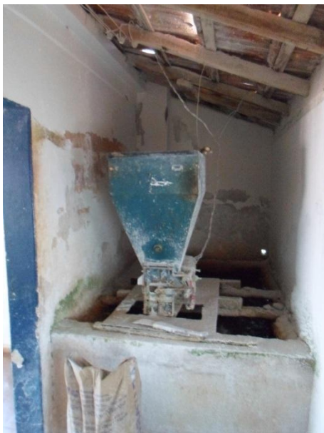
Foto 4.11 – Vista da casa de química (adição de cal e coagulantes)
