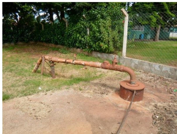
Foto 4.4 – Poço Santa Vitória
