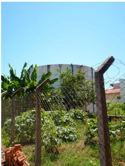
Foto 4.16 – RAP Caroni – Capacidade 500 m³
