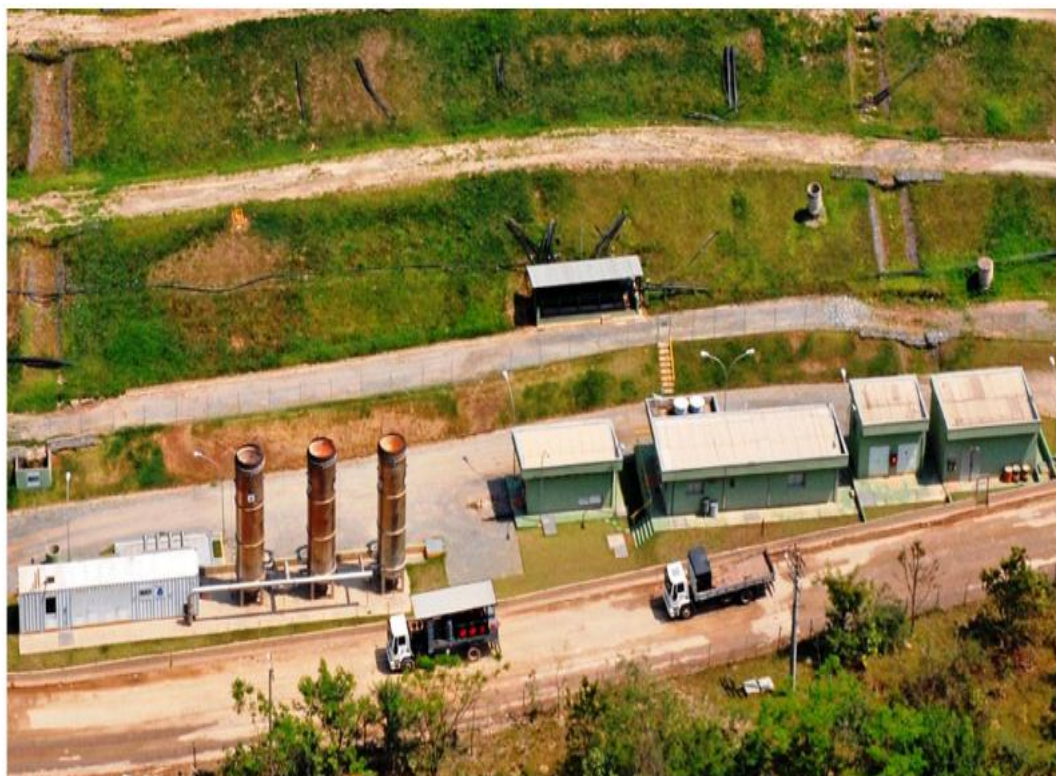
Figura 20 - Central de Biogás. Fonte: Arquivo CDR Pedreira.
