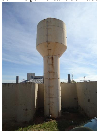
Foto 3.41 – Reservatório apoiado – Chácaras Aurora
