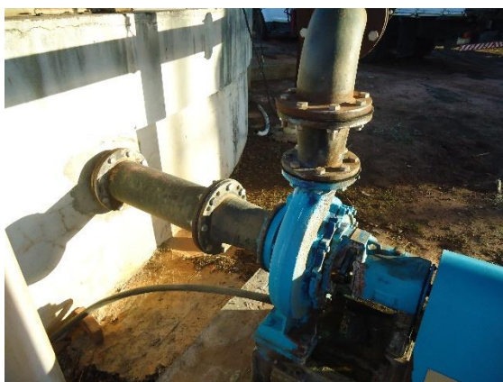
Foto 3.48 – Detalhe bomba EAT - Central
