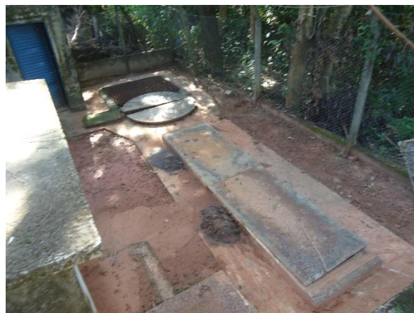
Foto 3.74 – Trat. preliminar – EEE Flamboyant
