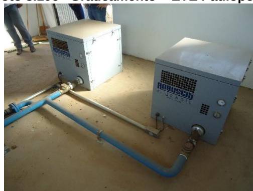
Foto 3.108 –Sopradores – ETE Paulópolis
