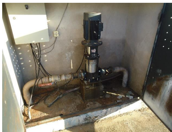
Foto 3.49 – Detalhe bomba EAT – JK I
