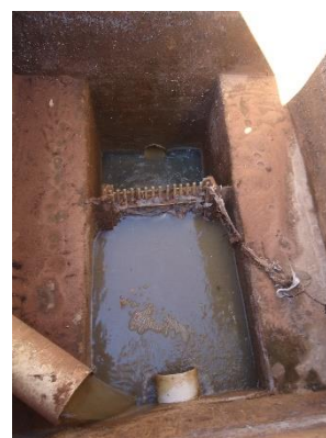
Foto 3.106 –Gradeamento – ETE Paulópolis
