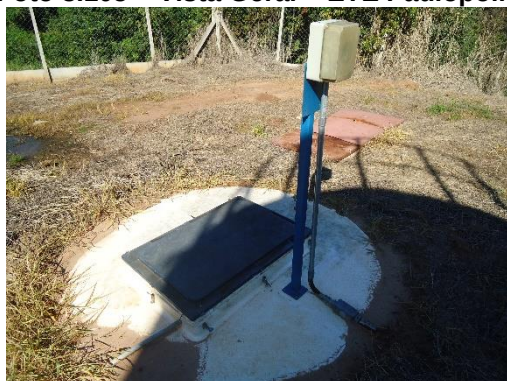
Foto 3.107 – Sistema de cloração – ETE Paulópolis
