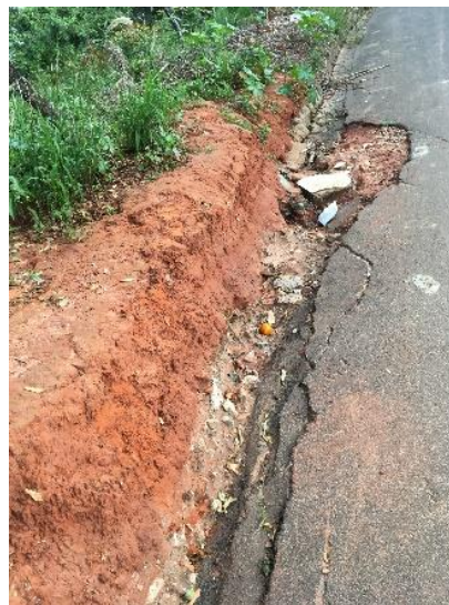
Foto 3.134 – Danos na via provocados pelo escoamento superficial – Rua Pirajá
