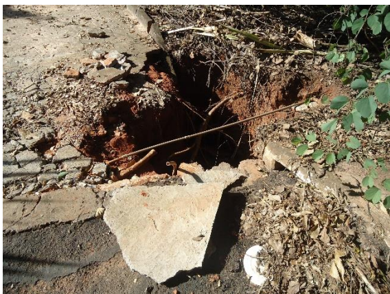
Foto 3.138 – Danos estruturais causados microdrenagem insuficiente
