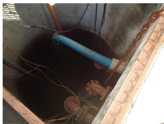
Foto 3.59 – Detalhe – Poço de Sucção – EEE 2 – Dist. Industrial III
