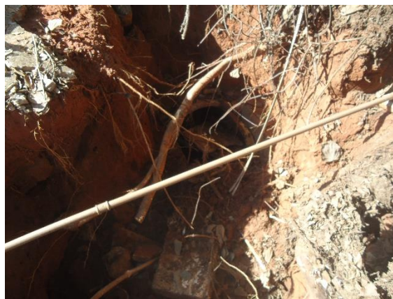
Foto 3.139 – Danos estruturais causados microdrenagem insuficiente
