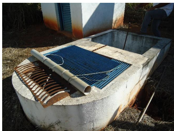
Foto 3.58 – Vista Geral – Poço de Sucção – EEE 2 – Dist. Industrial III
