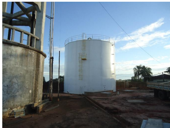
Foto 3.4 – Reservatório apoiado - Sede
