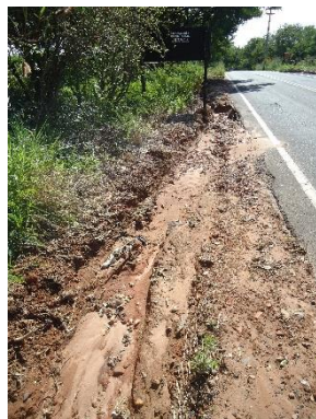
Foto 3.109 – Falta de drenagem - Rua José Jordão
