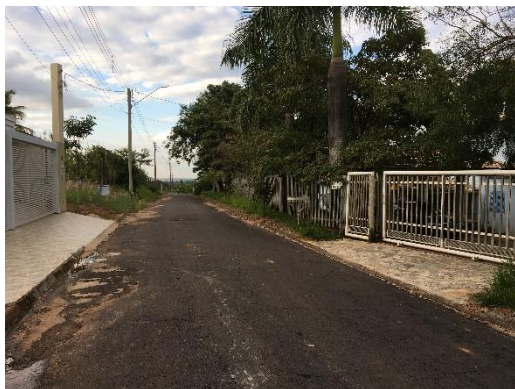
Foto 3.128 – Microdrenagem insuficiente – R. Prof. Matilde
