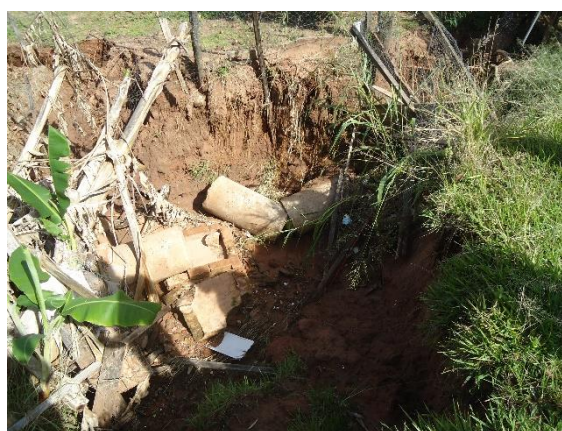
Foto 3.145 –Processo erosivo – Chácara Aurora
