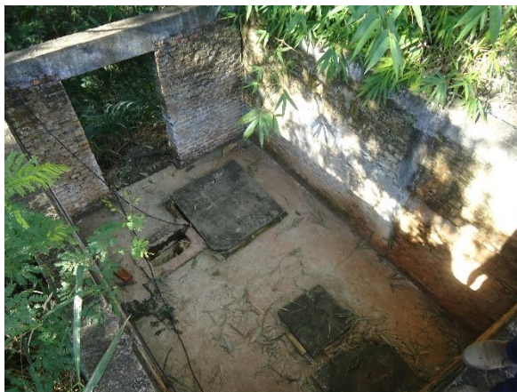
Foto 3.81 – Vista Geral – EEE Florentino Favoreto
