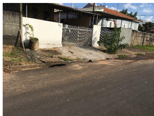
Foto 3.123 – Insuficiência de drenagem – Rua Zanguetin
