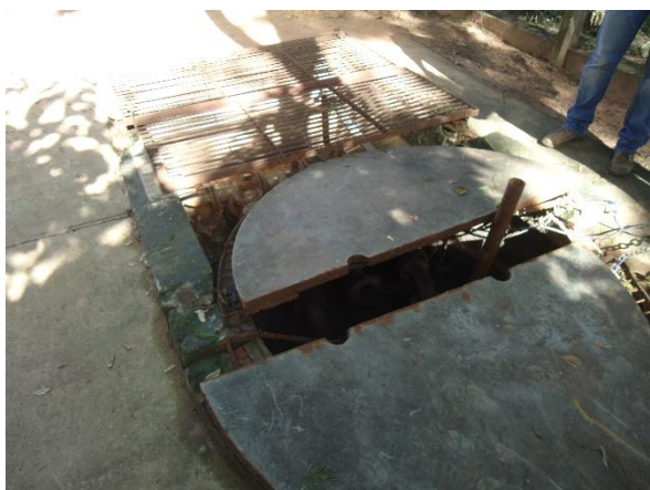
Foto 3.68 – Poço de Sucção – EEE 2 – Vila Paulínea
