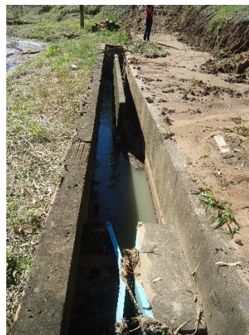
Foto 3.86 – Tratamento Preliminar – Caixa de Areia e Calha Parshall
