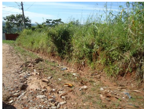
Foto 3.110 – Falta de drenagem – Chácaras Aurora
