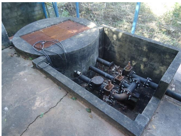
Foto 3.82 – Poço de sucção – EEE Boa Vista
