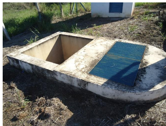
Foto 3.57 – Poço de sucção – EEE 1 – Dist. Industrial III
