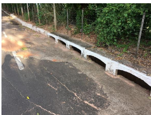
Foto 3.131 – Microdrenagem insuficiente – R. Prof. Bonifácio Martins - Paulópolis
