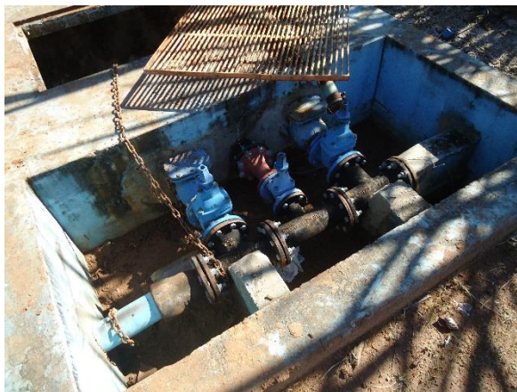
Foto 3.84 – Poço de sucção – EEE Boa Vista
