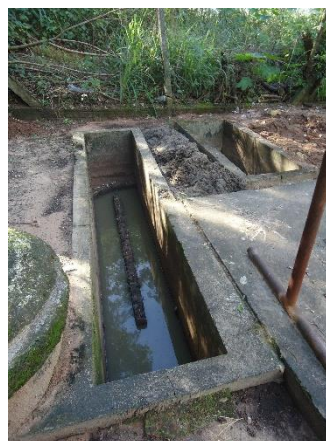
Foto 3.53 – Caixa de Areia – EEE Pirajá
