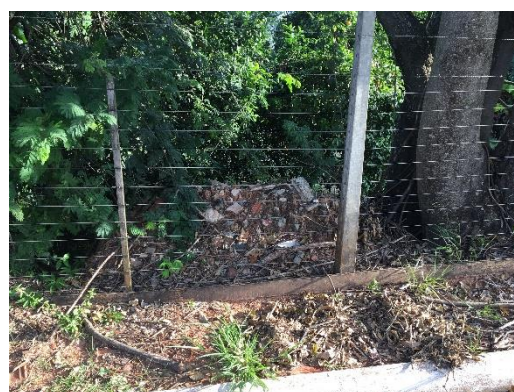
Foto 3.132 –Material carreado para propriedade devido ao escoamento superficial
