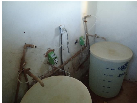
Foto 3.51 – Bombas dosadoras de cloro e flúor – Sist. Lacombe
