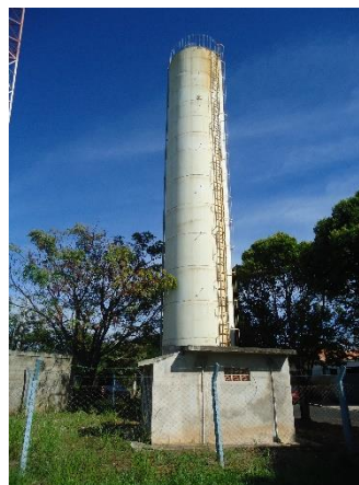
Foto 3.43 – Reservatório apoiado – Rua Brasília
