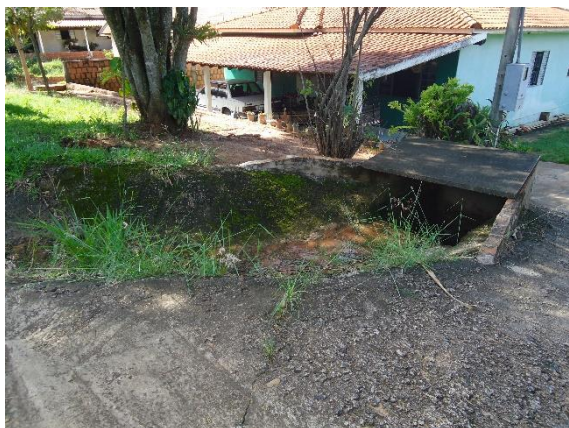
Foto 3.142 –Tubulação que contribui para erosão
