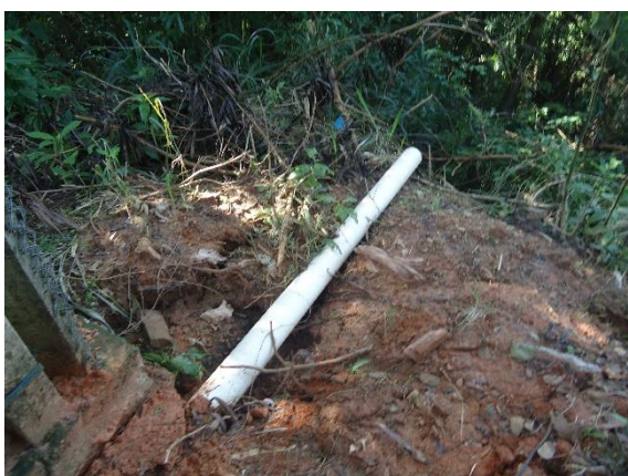
Foto 3.140 – Final da galeria que contribui para o processo erosivo
