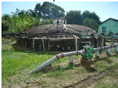
Foto 3.16 – Reservatório semienterrado (R-05) – Morro Azul
