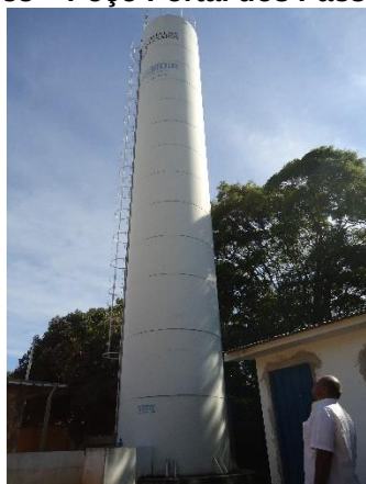
Foto 3.40 – Reservatório apoiado Portal dos Pássaros
