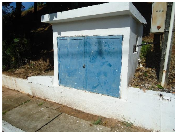
Foto 3.80 – Painel de Comando – EEE R. Brasília
