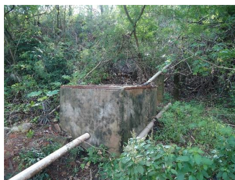
Foto 3.98 – Caixa de Areia – ETE F. Favoreto
