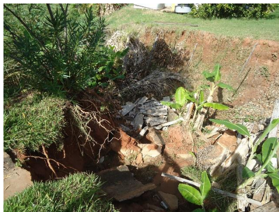
Foto 3.143 –Processo erosivo – Chácara Aurora
