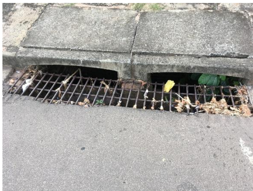
Foto 3.113 – Estrutura de drenagem – Av. Salvador M. Almeida
