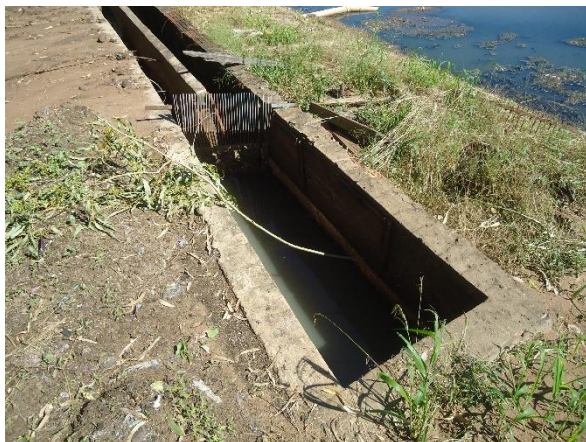
Foto 3.85 – Tratamento Preliminar - Gradeamento
