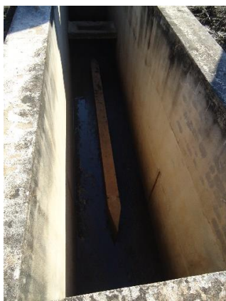
Foto 3.56 – Vista Geral – Tratamento Preliminar – EEE 1 – Dist. Industrial III
