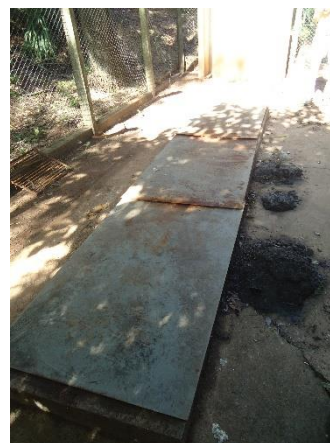
Foto 3.69 – Tratamento preliminar – EEE 1 – Vila Paulínea
