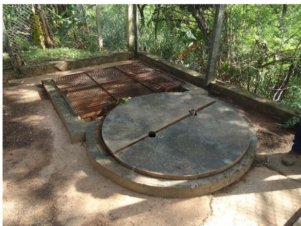
Foto 3.66 – Poço de Sucção – EEE 1 – Vila Paulínea
