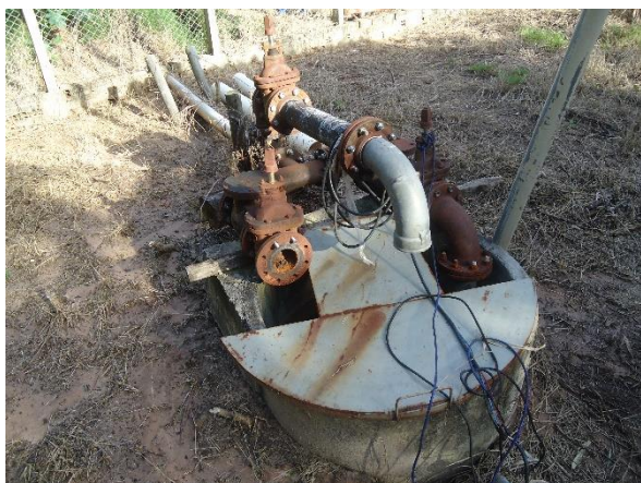
Foto 3.75 – Poço de Sucção – EEE Luis Padilha
