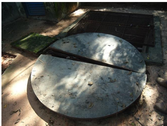
Foto 3.73 – Poço de Sucção – EEE Flamboyant
