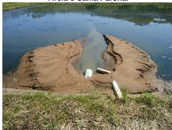
Foto 3.88 – Entrada Lagoa Anaeróbia – Problemas de Assoreamento
