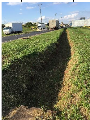
Foto 3.126 – Estrutura de drenagem – Av. Perimetral
