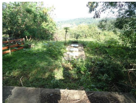
Foto 3.100 – Decantador – ETE F. Favoreto
