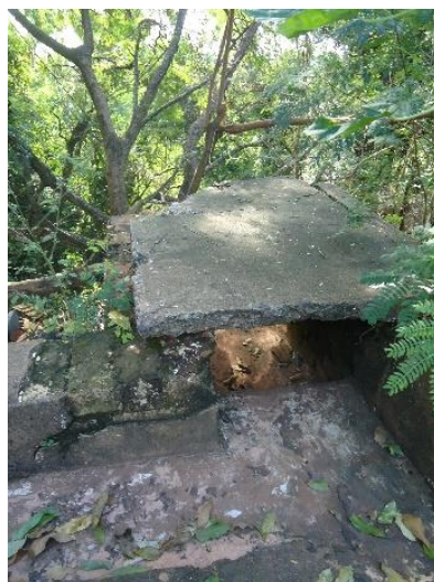
Foto 3.136 –Dispositivo de descarga ao final da Rua Francisco Colabono
