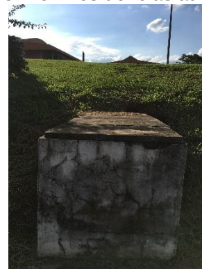
Foto 3.127 – Estrutura de drenagem – Av. Perimetral
