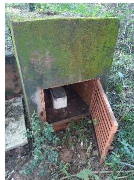
Foto 3.104 –Soprador – ETE F. Boa Vista
