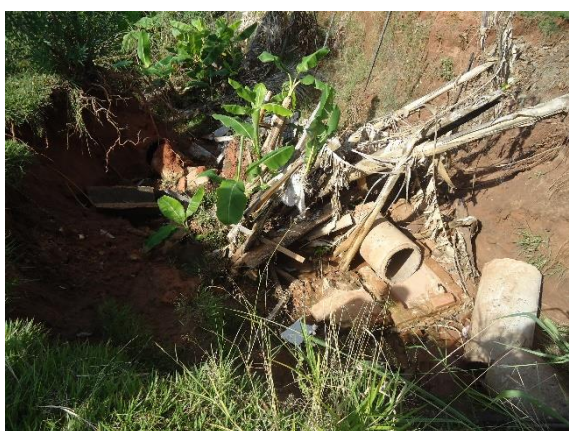
Foto 3.144 –Processo erosivo – Chácara Aurora
