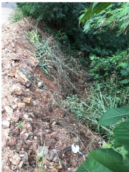
Foto 3.133 – Ponto de erosão – Rua Pirajá
