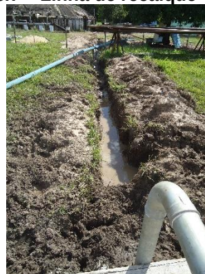
Foto 3.9 – Linha de recalque – Poço 03
