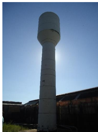
Foto 3.26 – Reservatório apoiado – Dist. Industrial III
