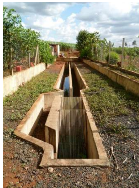
Foto 4.16 - Gradeamento e caixa de areia
