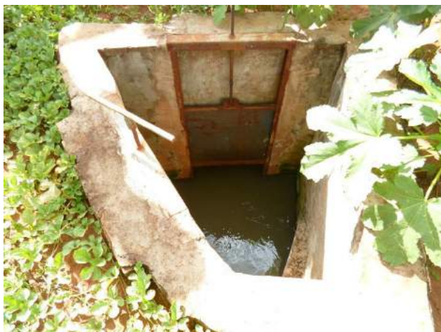
Foto 4.15 - Chegada do esgoto no tratamento preliminar
