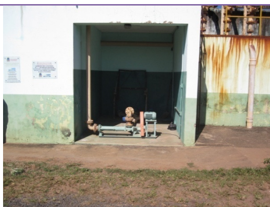
Foto 67 - Elevatória de descarte de lodo.
