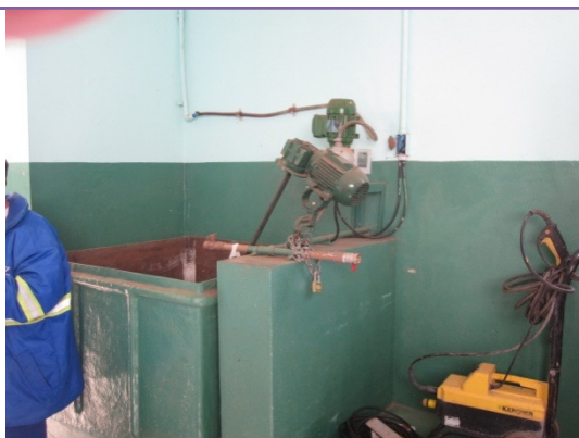
Foto 64 - Vista de outro tanque de preparo de polieletrólito.
