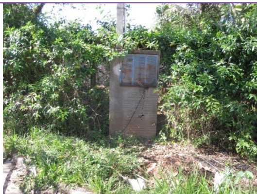
Foto 41 - Quadro de comando da estação elevatória de esgotos EEE-4E.
