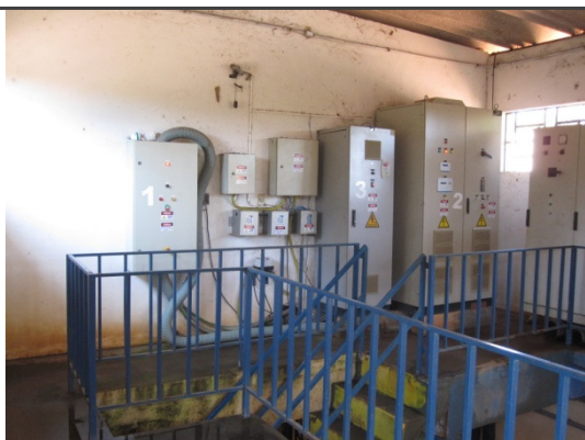
Foto 3 - Painéis das bombas da elevatória "nova" da captação nº 1.
