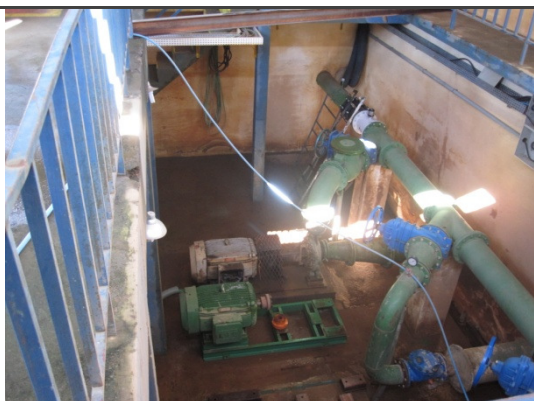
Foto 4 - Vista de um dos conjuntos de recalque da elevatória "nova".
