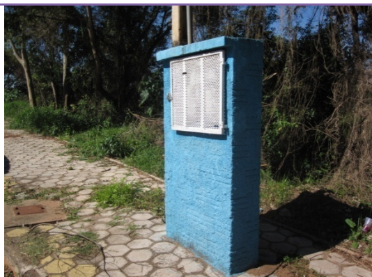
Foto 44 - Estação elevatória de esgotos EEE-5E (N. Sra. Aparecida 02), que será desativada.
