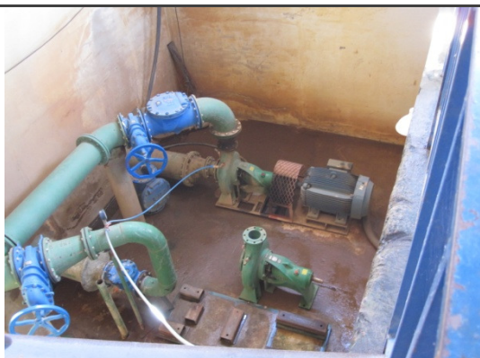
Foto 5 - Vista de outro conjunto de recalque da elevatória "nova".
