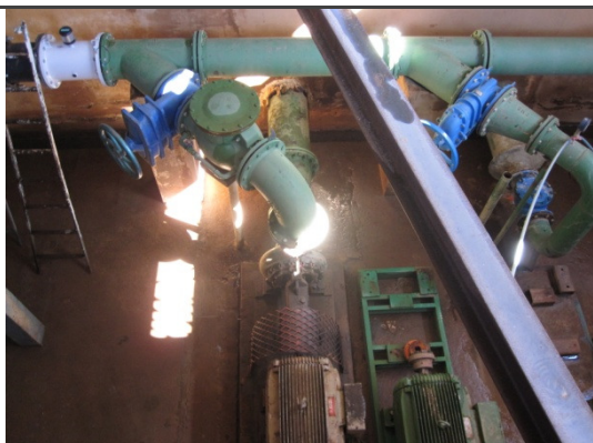
Foto 6 - Detalhe do barrilete de recalque da elevatória "nova".
