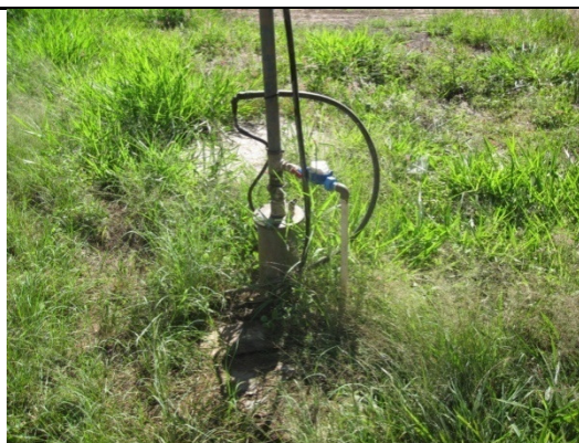
Foto 28 - Poço de captação de água subterrânea localizado junto ao reservatório Cuca Fresca.
