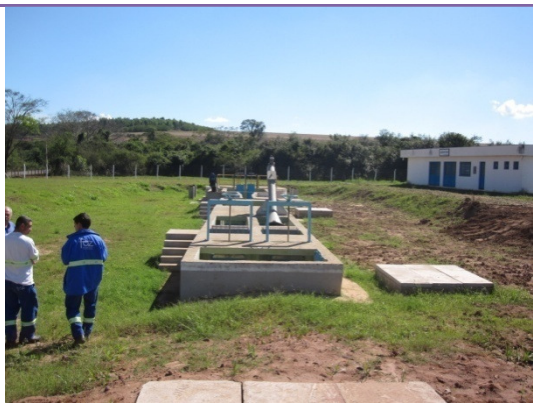
Foto 76 - Tratamento preliminar da ETE da Fazendinha.
