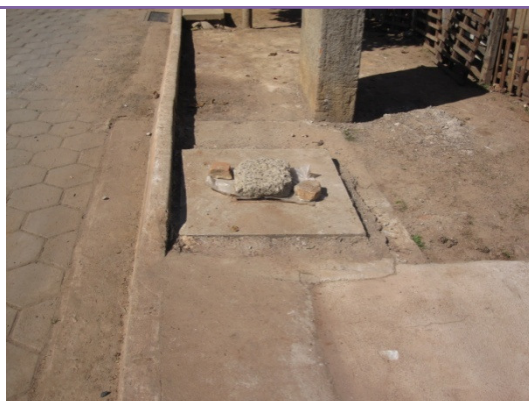
Foto 47 - Detalhe da estação elevatória de esgotos EEE-7E (N. Sra. Aparecida 04), que será desativada.
