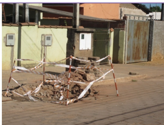
Foto 49 - Detalhe da estação elevatória de esgotos EEE-6E (N. Sra. Aparecida 03), que será desativada.
