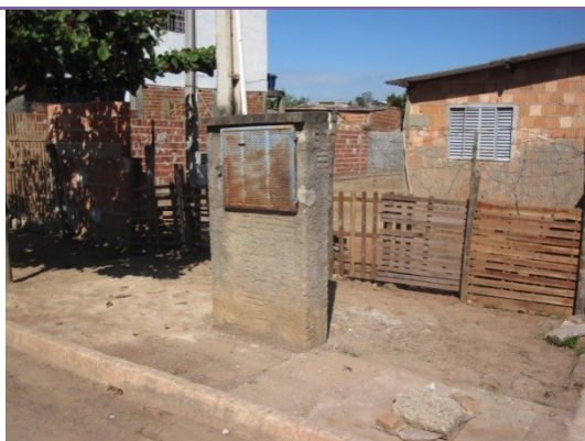
Foto 46 - Estação elevatória de esgotos EEE-7E (N. Sra. Aparecida 04), que será desativada.
