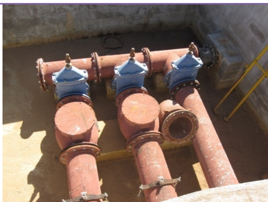
Foto 78 - Detalhe do barrilete da estação elevatória de esgoto localizada após o tratamento preliminar.
