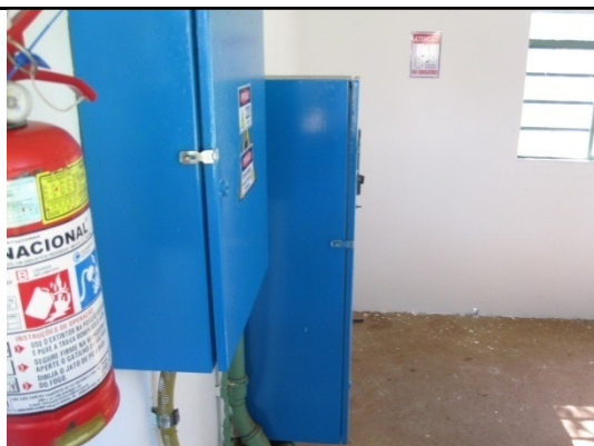
Foto 20 - Painéis das bombas.
