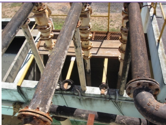
Foto 56 - Estação elevatória de efluente gradeado e desarenado que alimenta os tanques de aeração.
