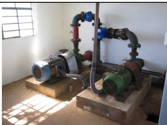
Foto 19 - Bombas da elevatória da captação nº 2.
