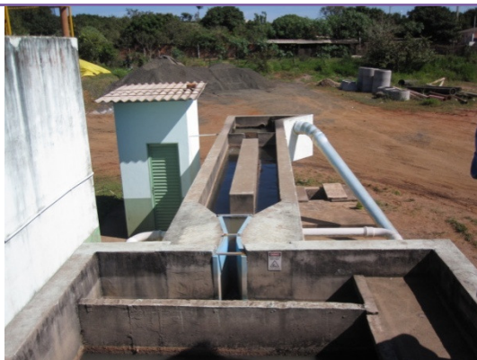
Foto 58 - Unidade de desarenação e gradeamento da ETE Santa Rosa.
