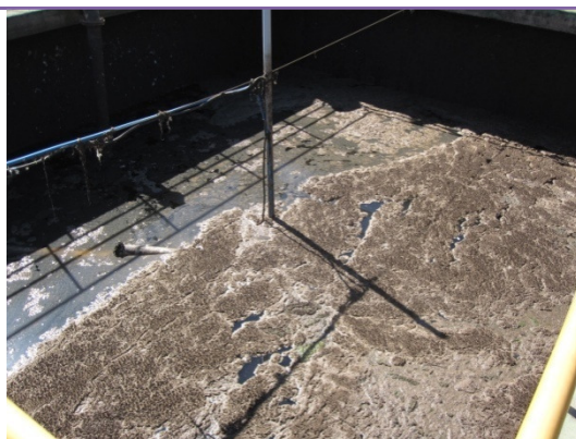
Foto 53 - Vista de um dos tanques de aeração da ETE Santa Rosa (parado).
