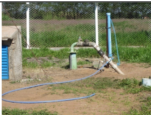
Foto 30 - Poço de captação de água subterrânea nº 1 localizado junto ao reservatório Águas Claras.
