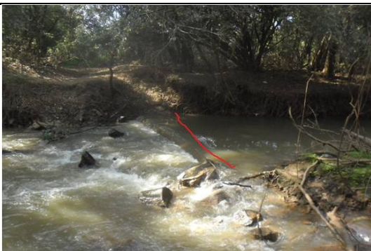
Foto 39 - Detalhe da travessia da adutora de água bruta da captação do Rio Mogi Guaçu, totalmente em desacordo com as normas do DAEE.
