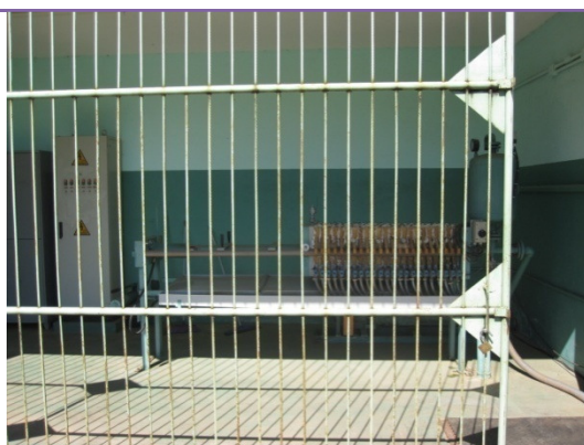
Foto 61 - Unidade de desidratação de lodo, composta por um filtro-prensa.
