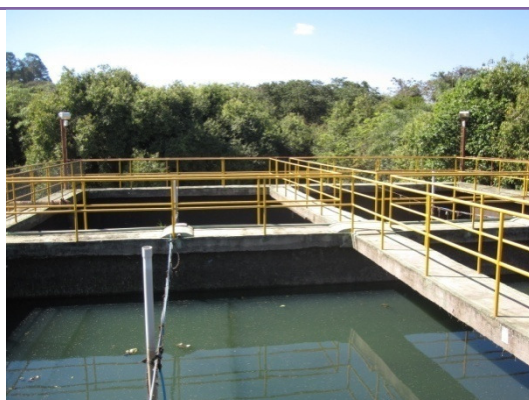
Foto 51 - Vista de um dos tanques de aeração da ETE Santa Rosa, em estágio de decantação.
