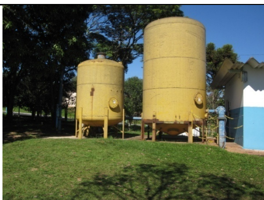
Foto 17 - Instalações da ETA 2
