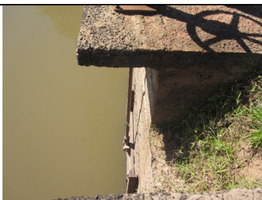
Foto 10 - detalhe da comporta da tomada de água.
