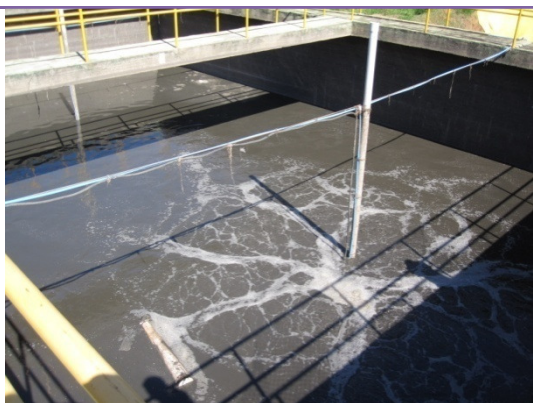
Foto 52 - Vista de um dos tanques de aeração da ETE Santa Rosa em estágio de aeração.
