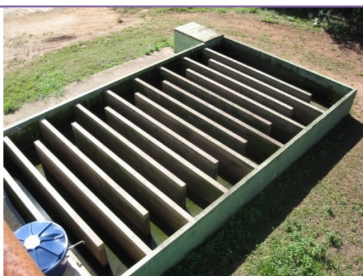
Foto 60 - Tanque de contato da unidade de desinfecção de efluente tratado.
