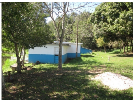
Foto 16 - Elevatória da captação nº 2.
