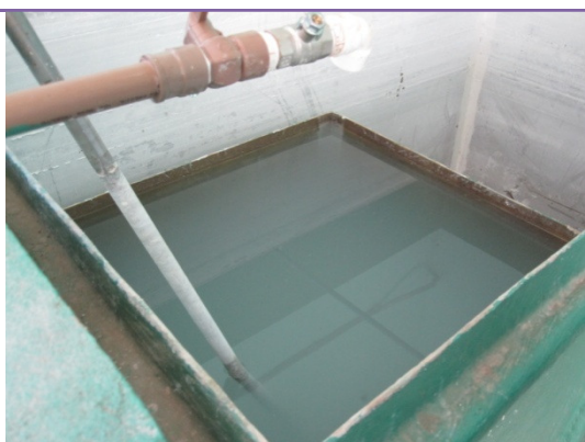
Foto 66 - Detalhe do interior de um dos tanques de preparo de polieletrólito.
