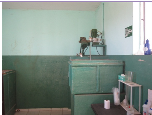
Foto 63 - Vista de um dos tanques de preparo de polieletrólito.
