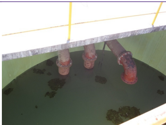
Foto 77 - Poço de sucção da estação elevatória de esgoto localizado após o tratamento preliminar
