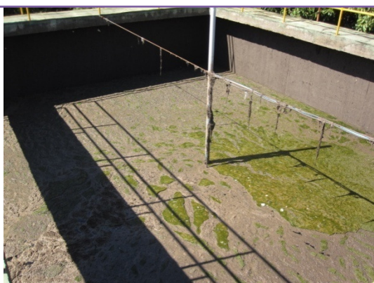
Foto 54 - Vista de um dos tanques de aeração da ETE Santa Rosa (parado).
