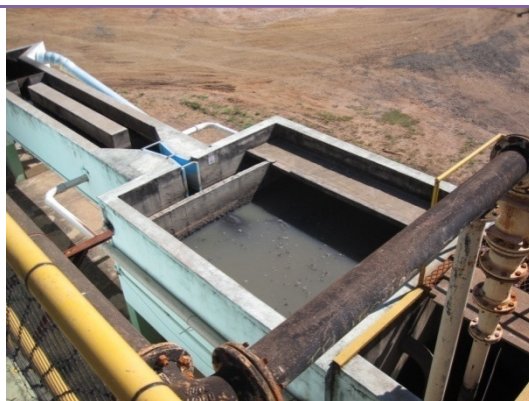
Foto 57 - Estação elevatória de efluente gradeado e desarenado que alimenta os tanques de aeração.
