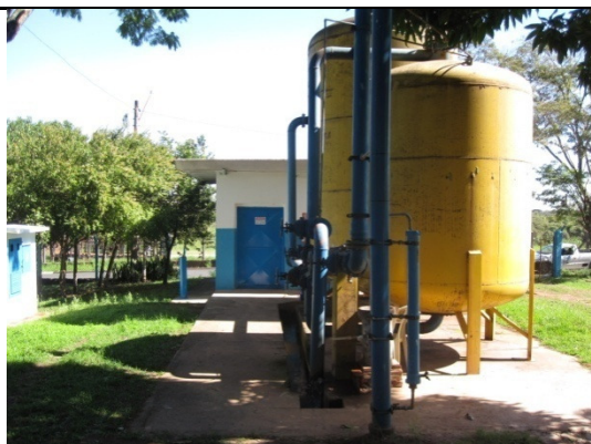
Foto 21 - Instalações da ETA 2 (ETA compacta).
