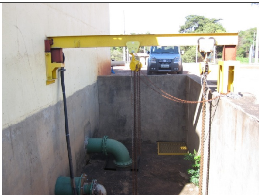
Foto 2 - Outra vista das tubulações do poço de sucção.
