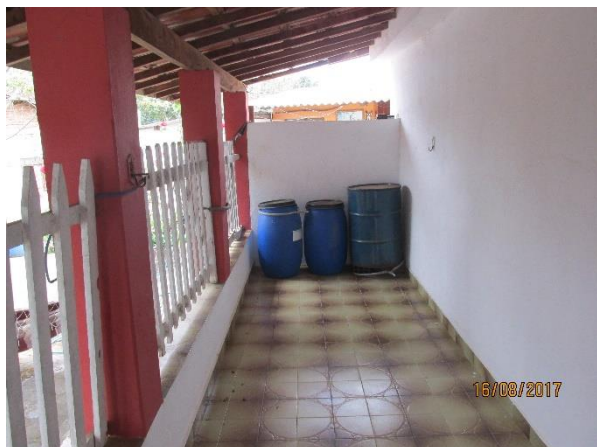
FIGURA 25 – ARMAZENAMENTO IRREGULAR DE RSS NO ESF-E (EXTENSÃO)
