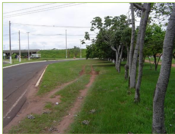
Foto 89. Ponto de Alagamento do asfalto
