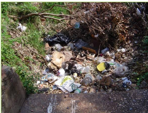
Foto 66: Outra erosão sendo usada para depósito de resíduos sólidos
