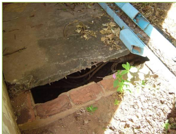
Foto 04: Caixa de fiação
