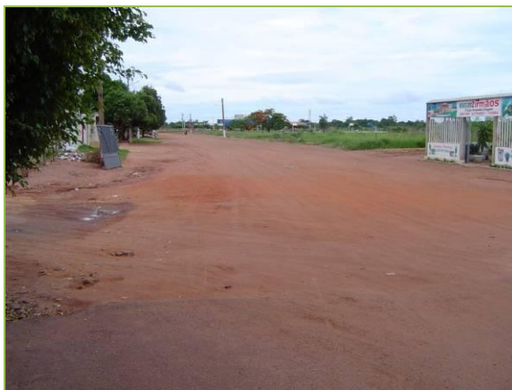
Foto 84. Ponto de Alagamento
