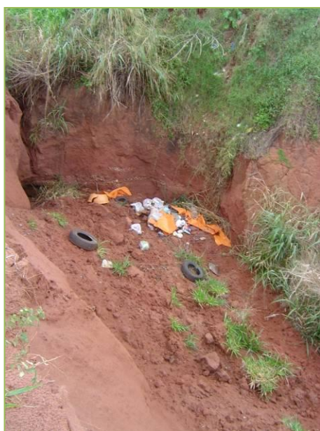
Foto 49: Resíduos descartados dentro da erosão.
