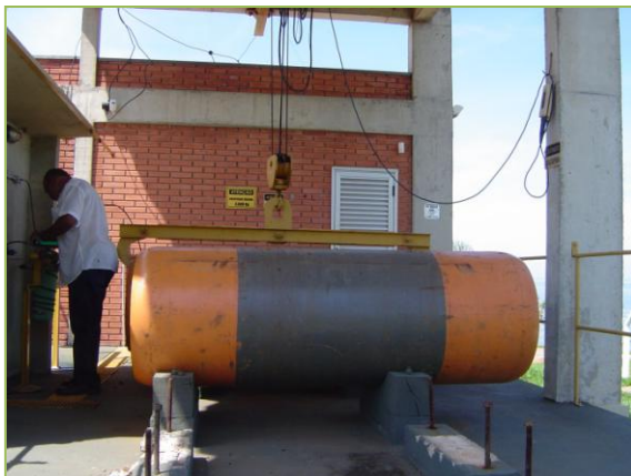
Foto 36 - Cilindro de gás-cloro
