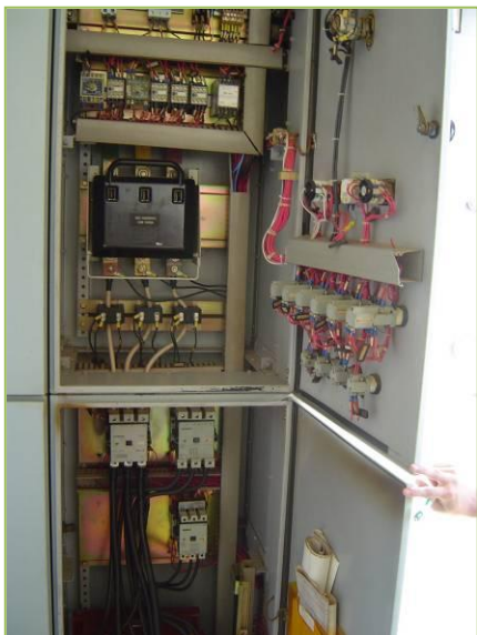
Foto 03: Painéis da captação
