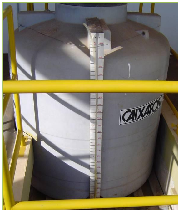
Foto 12 - Tanque de armazenamento de ácido Fluossilícico na ETA
