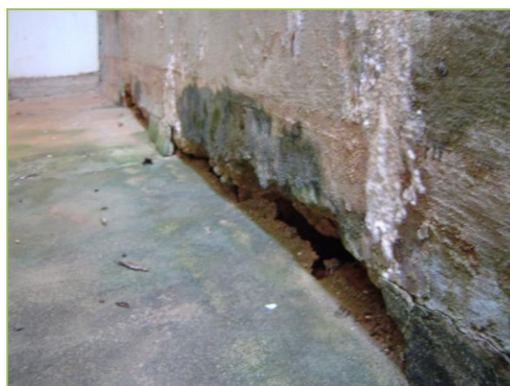
Foto 17: Deterioração da base
