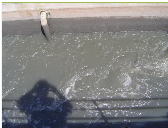
Foto 33: Vista da caixa de areia com soprador em operação.
