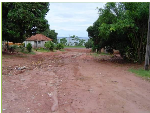
Foto 79. Rua sem pavimentação
