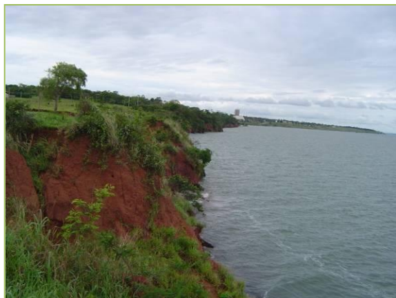
Foto 47: Falta de proteção na encosta
