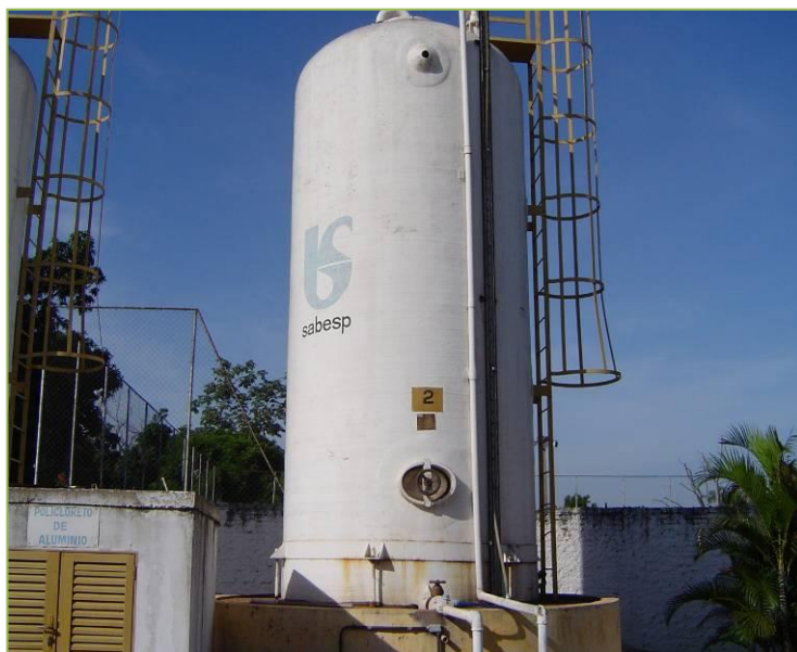
Foto 05: Tanque 2 de armazenamento de coagulante – PAC.
