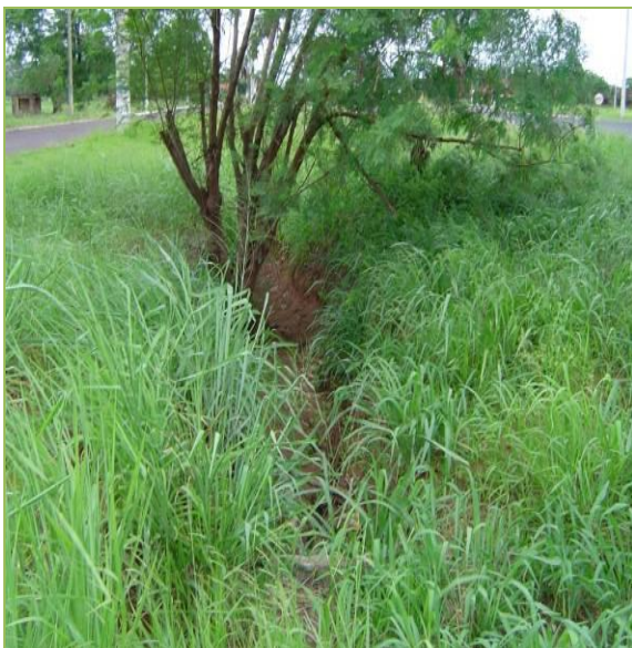
Foto 94. Início da erosão
