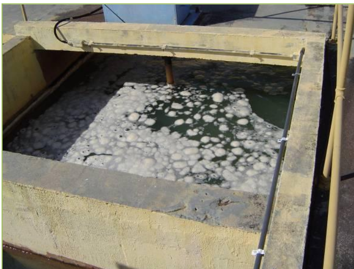
Foto 07 – Foto de uma das câmaras de floculação em operação na ETA
