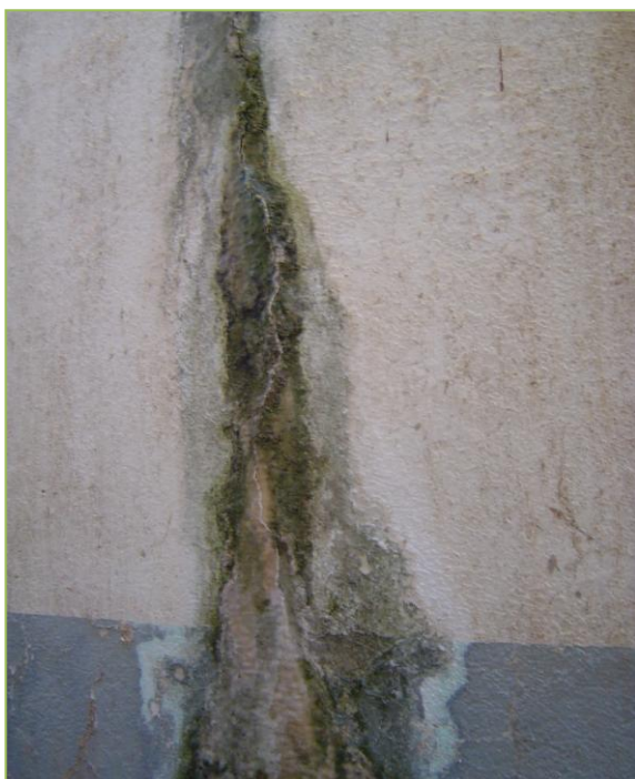
Foto 16: Trincas nas paredes
