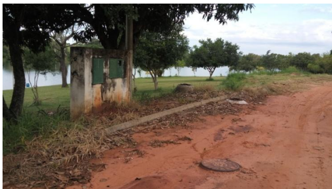
Foto 3.50 – Vista da EEE 05
