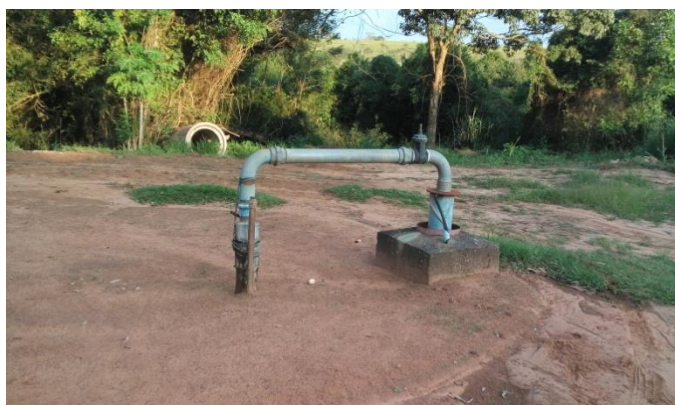
Foto 3.1 – Poço Profundo – PP-04
