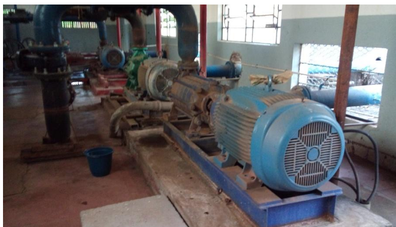
Foto 3.13 – Detalhe da EEAT da captação da Água da Lavadeira
