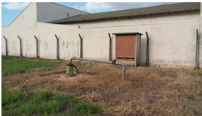
Foto 3.10 – Poço Profundo – PP-16
