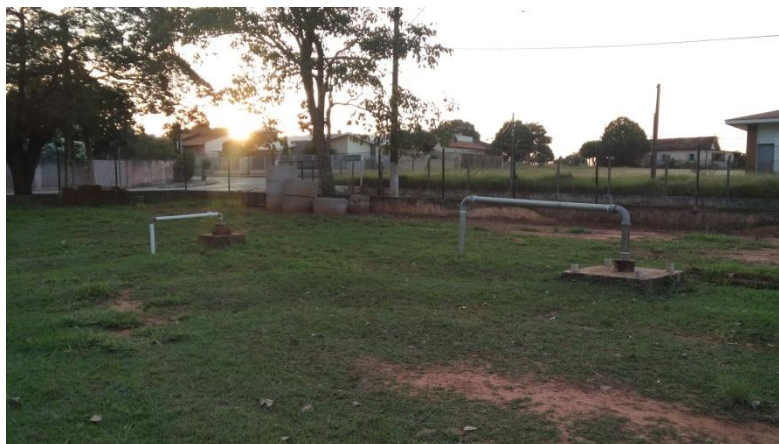
Foto 3.8 – Poço Profundo – PP-14
