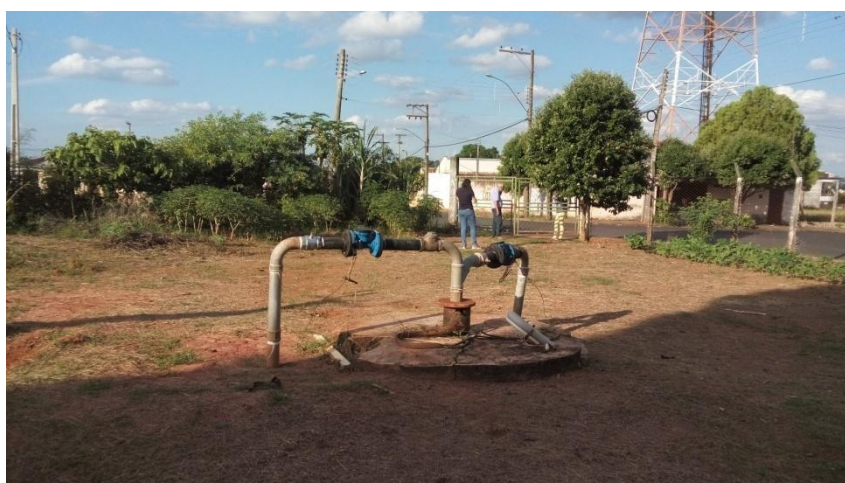
Foto 3.9 – Poço Profundo – PP-15
