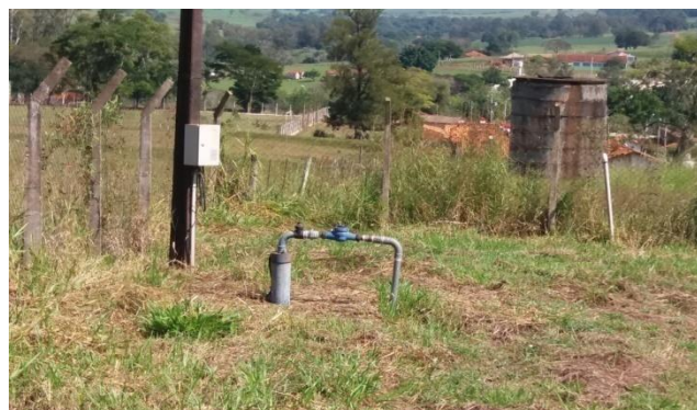
Foto 3.25 – Detalhe do Poço Profundo – PP-19
