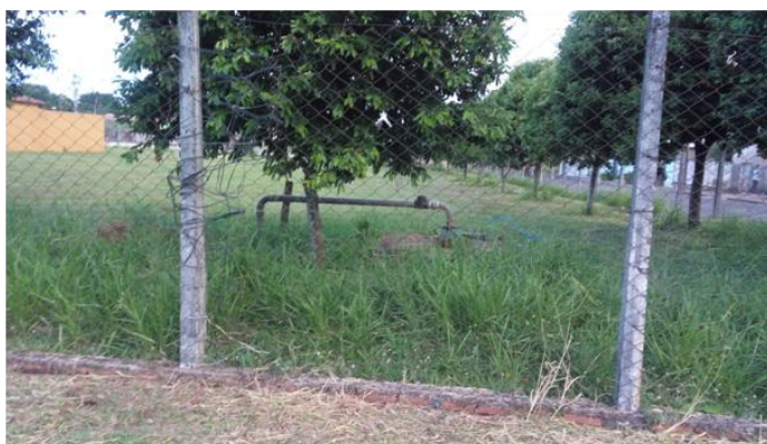
Foto 3.5 – Poço Profundo – PP-11
