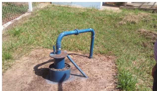
Foto 3.22 – Detalhe do Poço Profundo – PP 20
