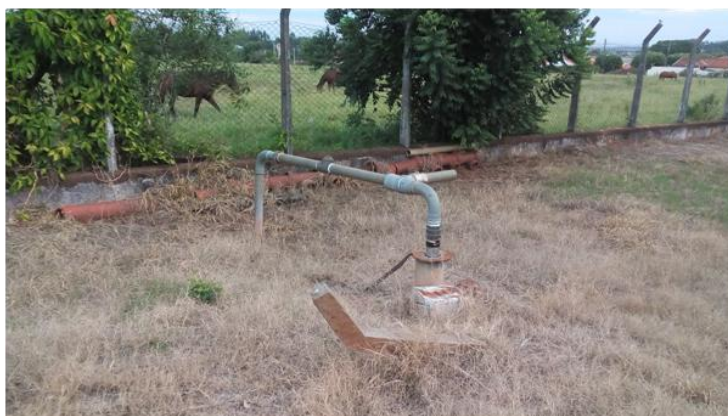
Foto 3.3 – Poço Profundo – PP-09
