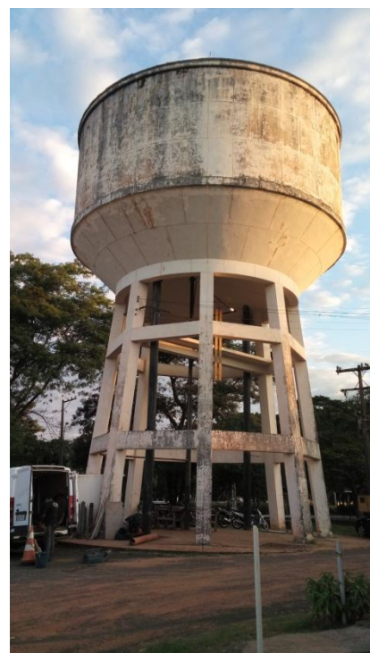
Foto 3.20 – Vista do reservatório elevado do Centro de Reservação Central
