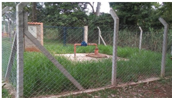
Foto 3.28 – Detalhe do Poço Profundo – PP 18
