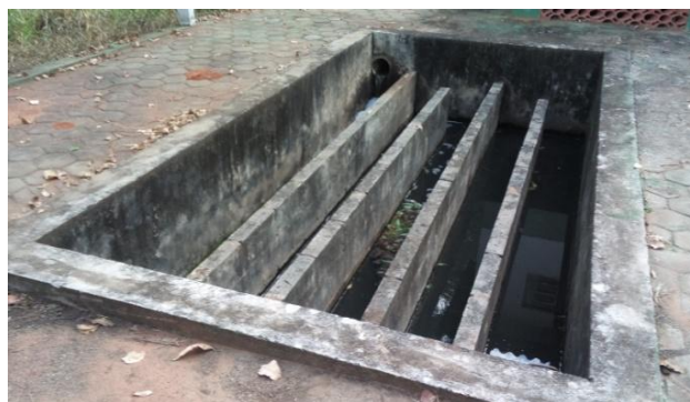
Foto 3.53 – Vista da Desinfecção da ETE
