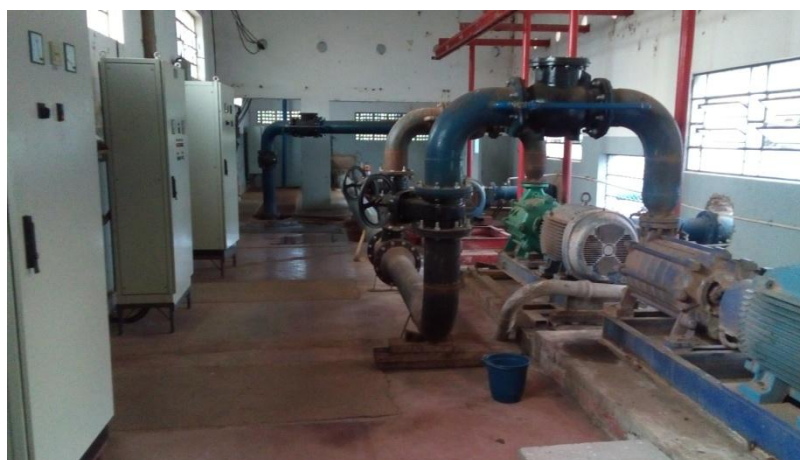
Foto 3.12 – EEAT1 E 2 - Água da Lavadeira
