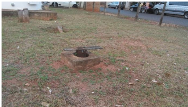
Foto 3.4 – Poço Profundo – PP-10
