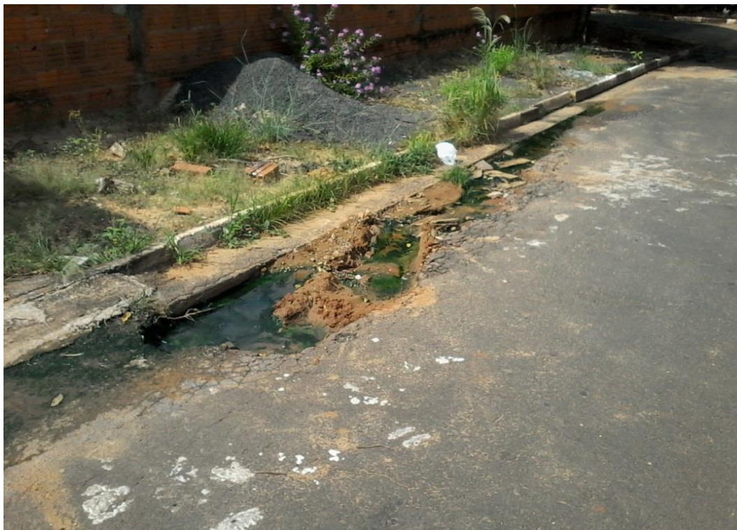
Imagem 34 - Erosão localizada na Rua 15 de Agosto
