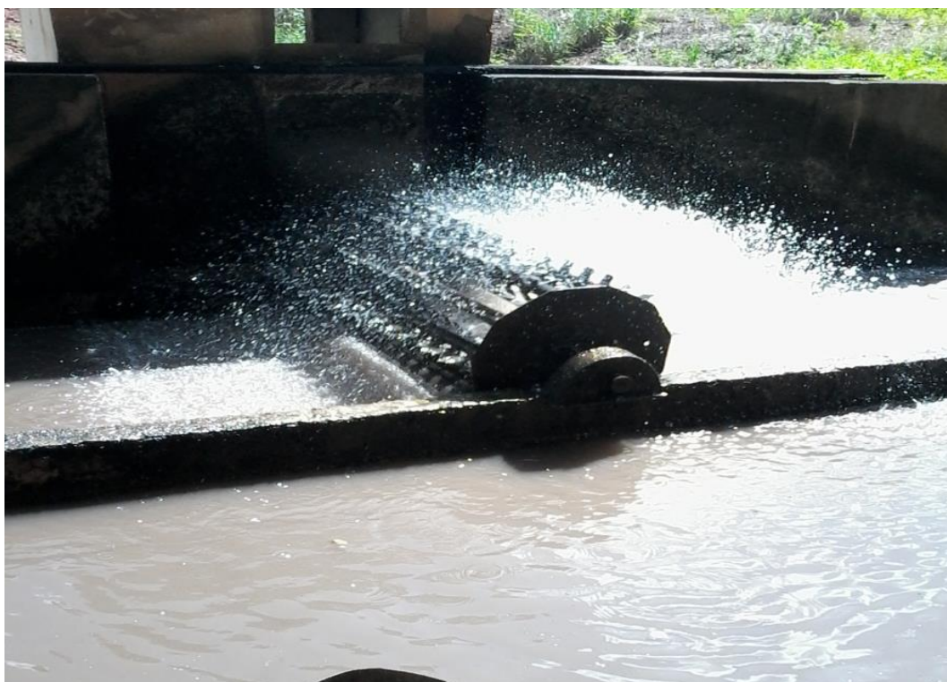
Imagem 19 - Aerador da Estação de Tratamento de Esgoto do Bairro Primavera
