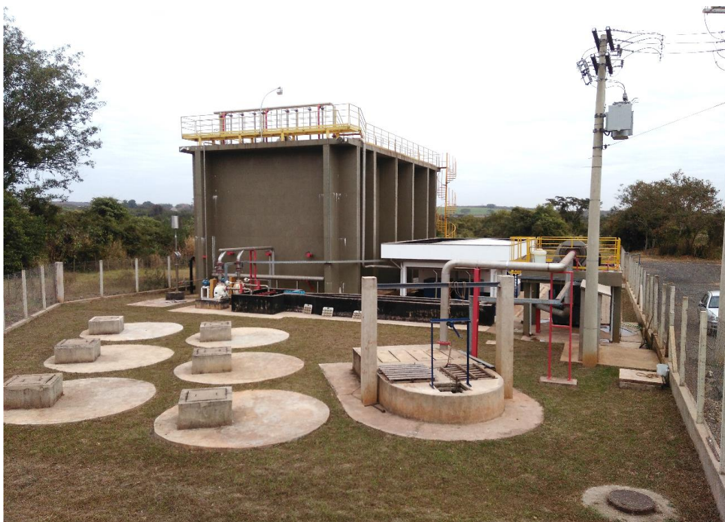
Imagem 22 – Estação de tratamento de esgoto (sistema UASB)
