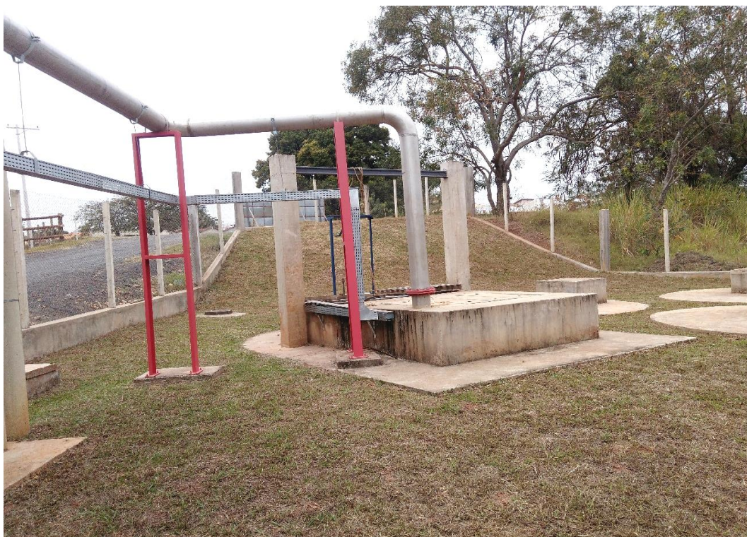
Imagem 23 – Estação elevatória de esgoto localizada na nova ETE do município
