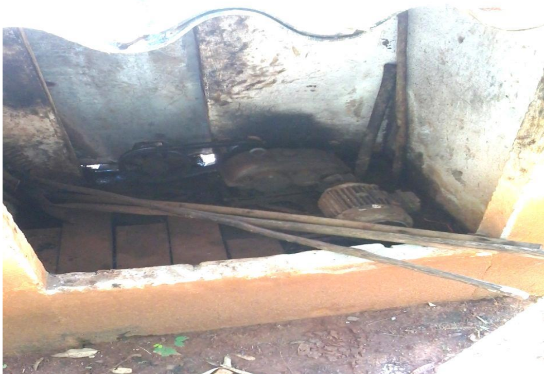
Imagem 18 – Motor do aerador da Estação de Tratamento de Esgoto do Bairro Primavera
