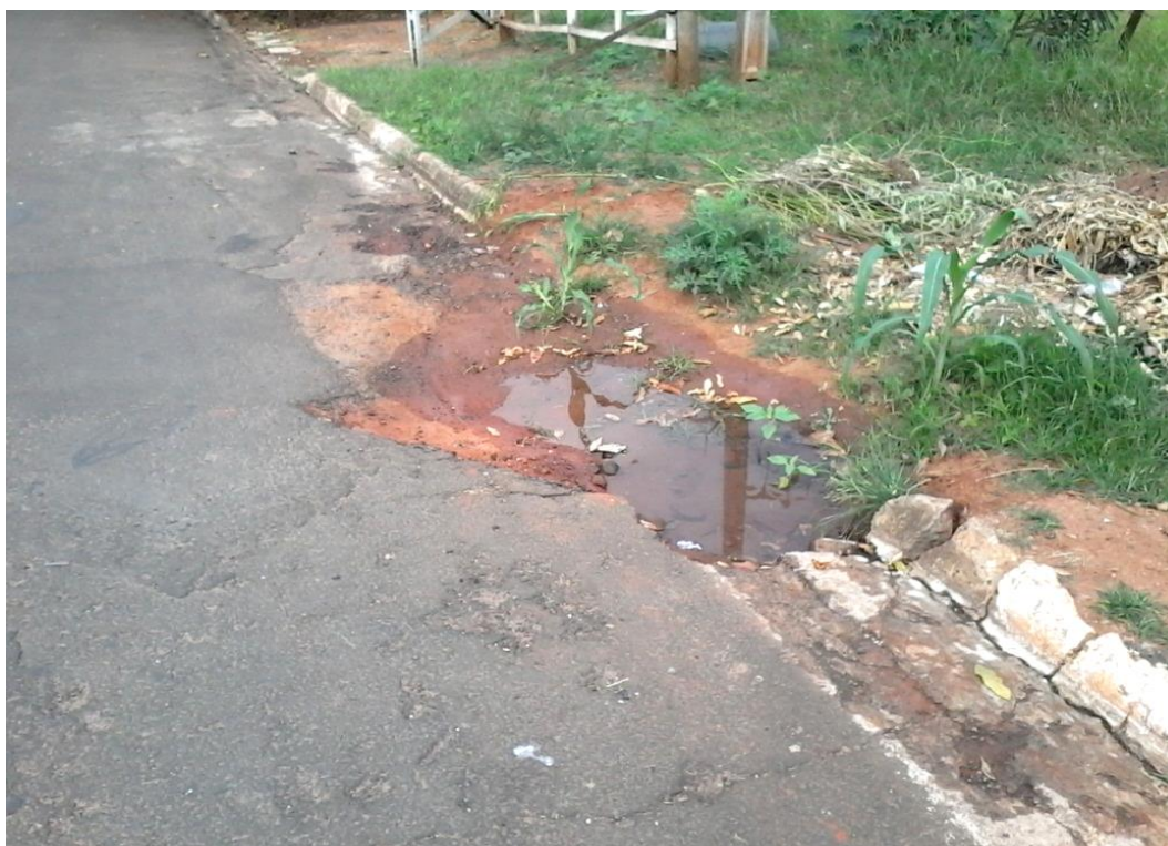
Imagem 33 - Erosão localizada na Rua 15 de Agosto
