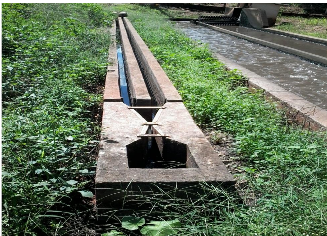
Imagem 17 - Caixas de gradeamento e de areia da Estação de Tratamento de Esgoto do Bairro Primavera
