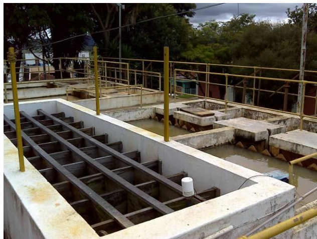
FOTO 4.4 - DETALHE DA ETA RIBEIRÃO BRANCO
