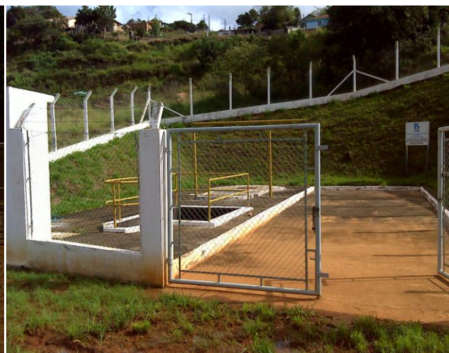
FOTO 4.17 - VISTA DA EEE CORREIAS - BAIRRO ITABOA
