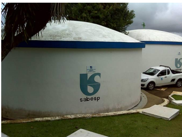
FOTO 4.5 - VISTA DOS RESERVATÓRIOS JUNTO A ETA RIBEIRÃO BRANCO
