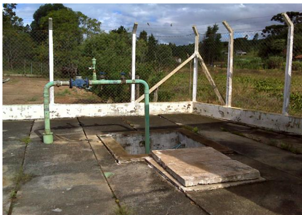
FOTO 4.8 – VISTA DO POÇO PROFUNDO DE ITABOA
