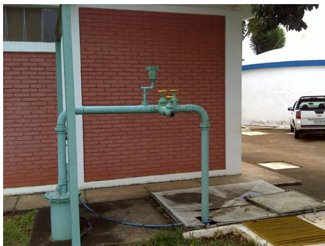
FOTO 4.7 – DETALHE DA EEAT DA SEDE LOCALIZADA DENTRO DA ETA RIBEIRÃO BRANCO
