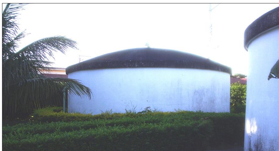
Foto 5 - Reservatório apoiado 02 (RA02)
