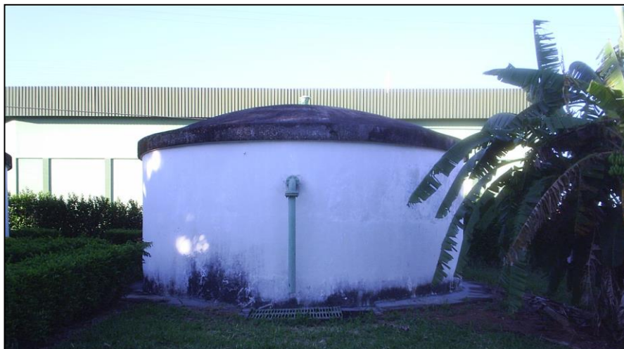
Foto 4 - Reservatório apoiado 01 (RA01)
