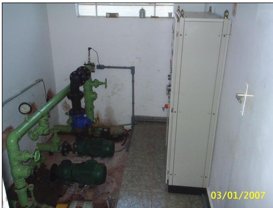
Foto 7 - Vista interna - equipamentos da EEAT 01
