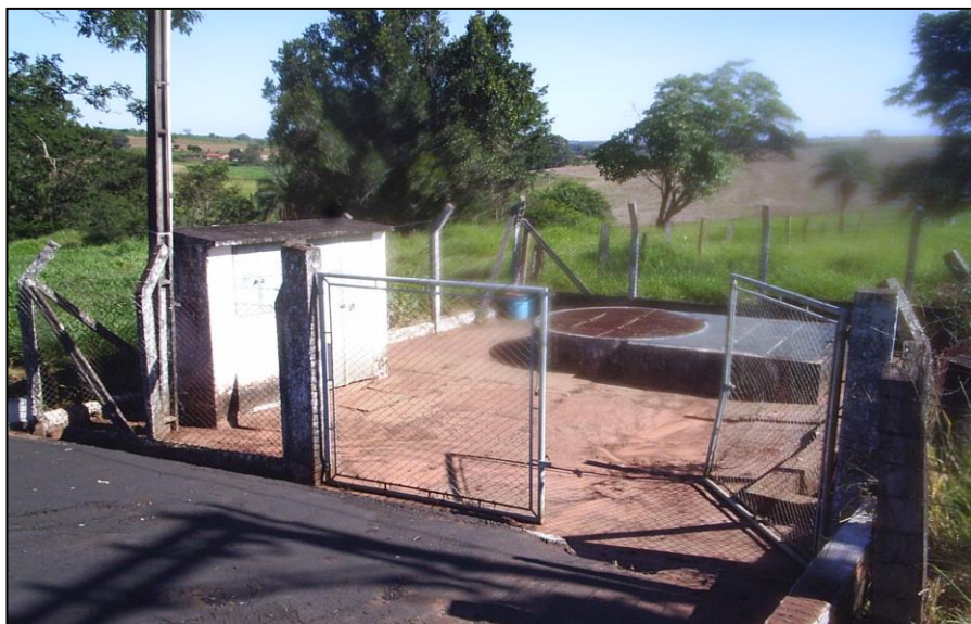
Foto 8 - Estação elevatória de esgotos (EEE 01)
