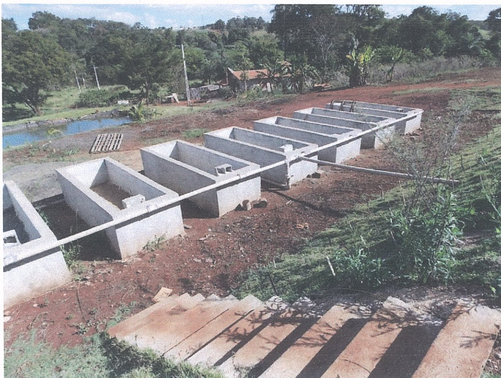
Foto: tanques de tratamento da água. Julho/2013
