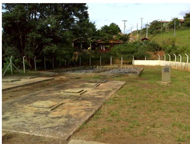
FOTO 4.19 - ETE RIBEIRÃO GRANDE – FOSSA FILTRO
