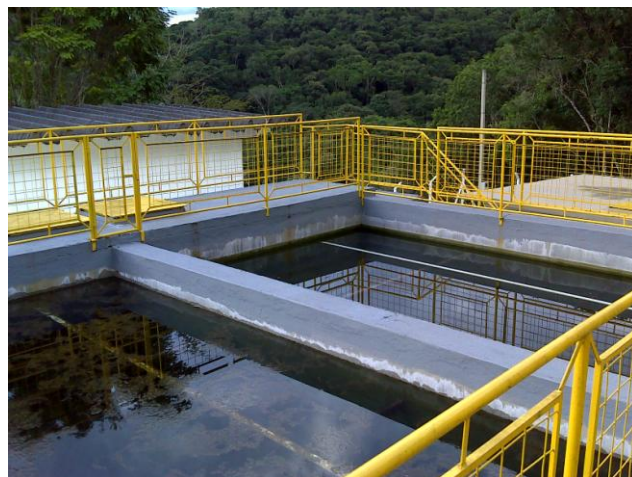
FOTO 4.14 – DECANTADORES DA ETA BOA VISTA
