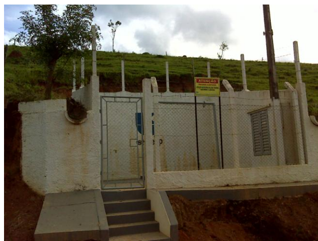
FOTO 4.5 – EEAT BAIRRO LAGOA
