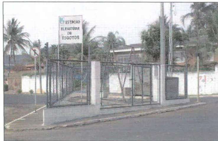
Foto 12 - Estação Elevatória de Esgotos 01 - EEE 01
