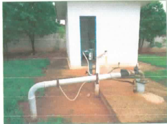
Foto 6 – Poço 6 (São Tiago)
