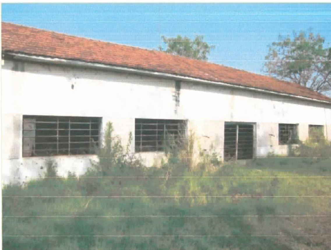
Foto 4 - Local de armazenamento de pneumáticos inservíveis
