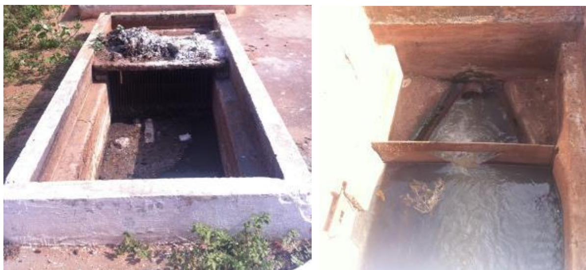
Figura 49. Caixas de gradeamento e desarenação
