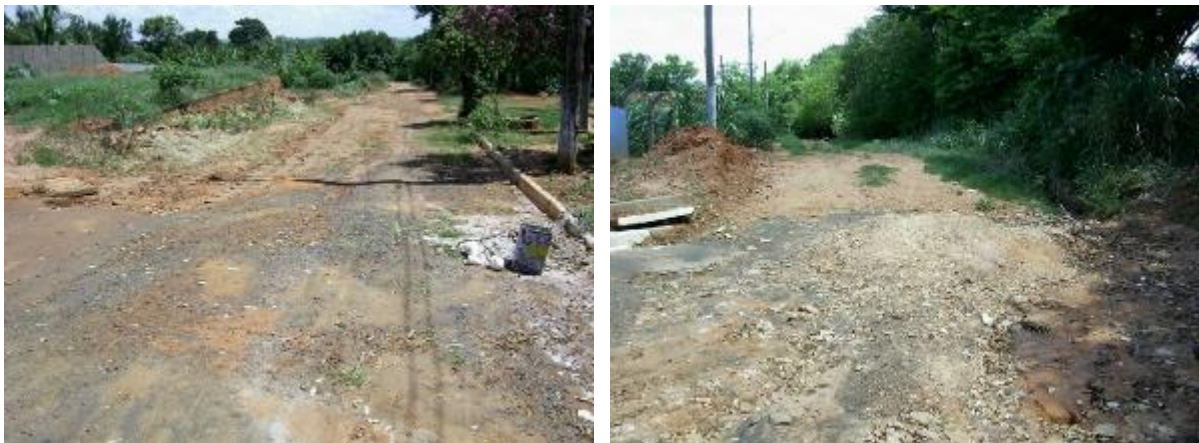
Figura 69. Erosão periurbana na Rua Cel. Francisco Schimidt
