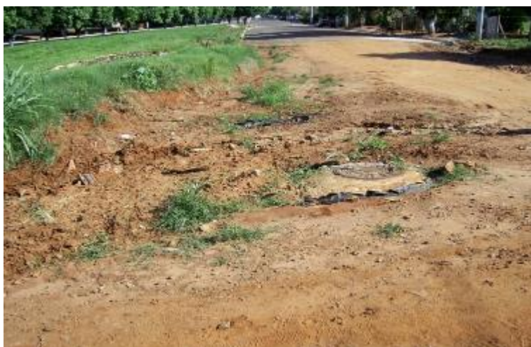
Figura 66. Erosão periurbana na Av. Santos com Av. Sir Alexander Fleming
