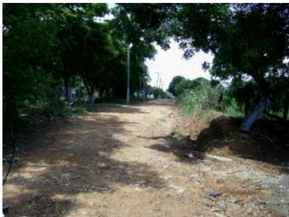
Figura 70. Erosão periurbana na Rua Cel. Francisco Schimitd
