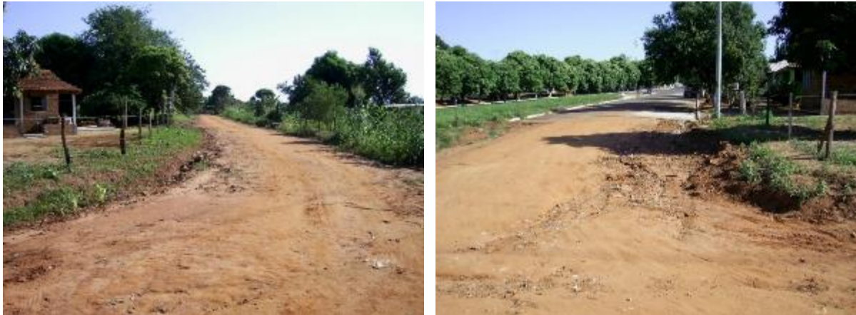
Figura 67. Erosão periurbana na Av. Santos com Av. Dr. Julio Prestes
