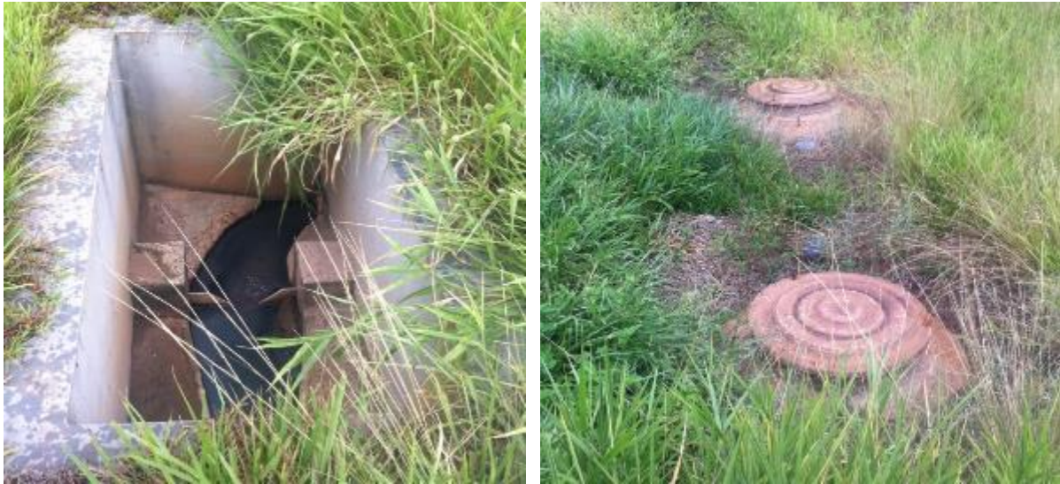
Figura 54. Caixa de passagem e filtros, respectivamente
