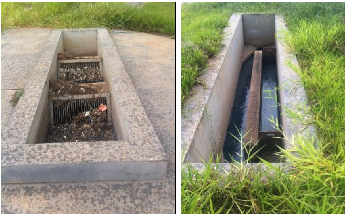
Figura 53. Caixas de gradeamento e desarenação
