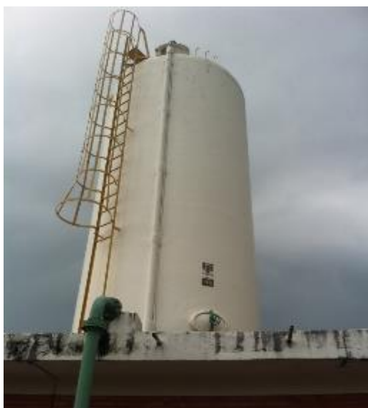
Figura 38. Reservatório (R2) – REL – Bairro Rural Caramuru
