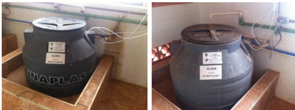
Figura 36. Cloração e fluoretação da água para abastecimento – Bairro Rural de Caramuru
