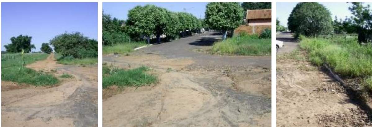
Figura 68. Assoreamento e erosão periurbana na Av. Ministro Konder com Av. Santos e Av. Dr. Alarico Silveira
