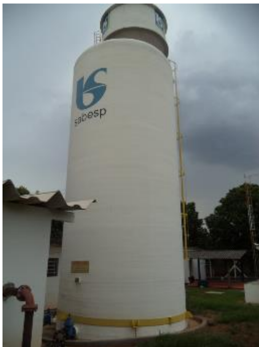
Figura 39. Reservatório (R3) – RAP
