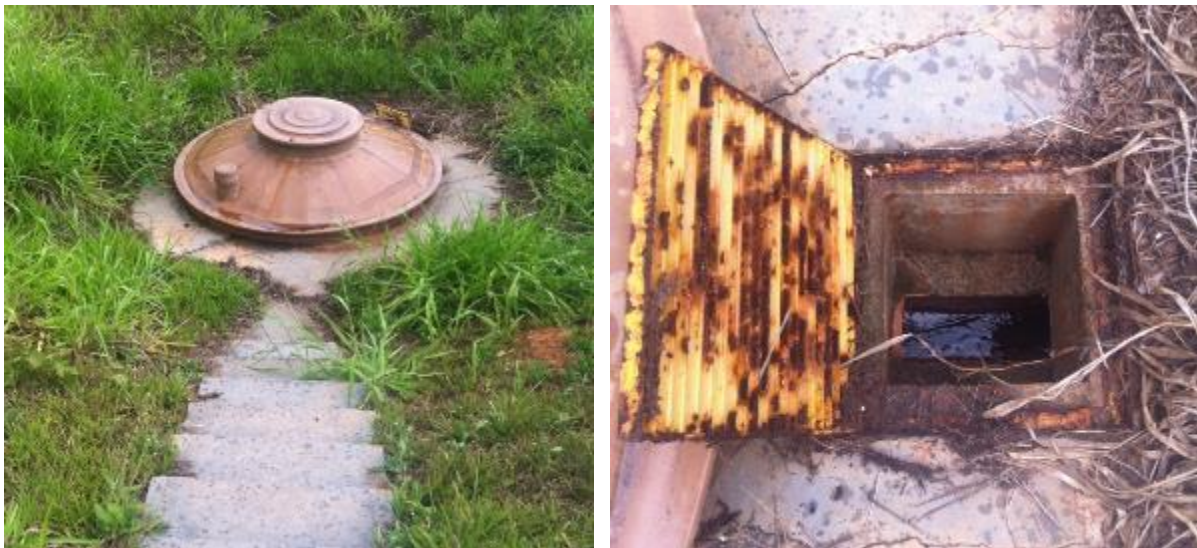
Figura 55. Processo final do tratamento com reator anaeróbio
