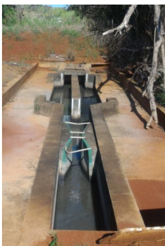
Foto 3.21 – Tratamento preliminar e Calha Parshall
