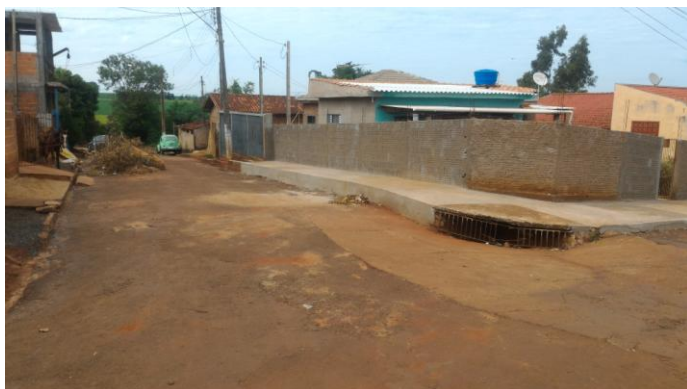
Ponto de alagamento – Rua Benjamin Constant com Rua Amadeu Amaral
