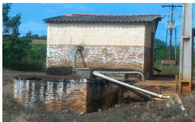
Foto 3.9 – Reservatório de água tratada
