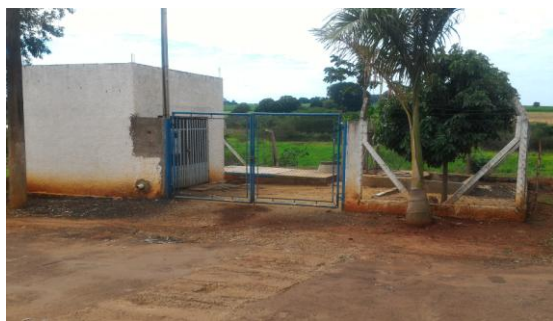
Estação Elevatória de Esgoto (EEE) Benjamin Constant
