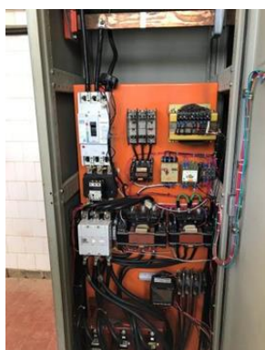
Figura 17. Vista Geral do painel elétrico das bombas.
