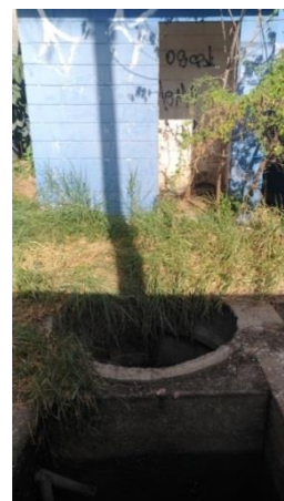
Figura 124. Estação Elevatória de Esgoto – Bandeirantes- Vista 2.
