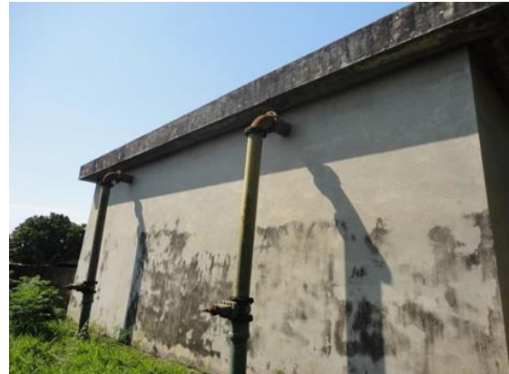
Figura 56. Reservatório Semi-Enterrado EAT Jurumirim.
