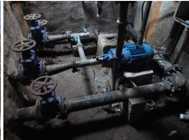
Figura 62. Conjuntos motor - bomba do EAT Haras Paineiras.
