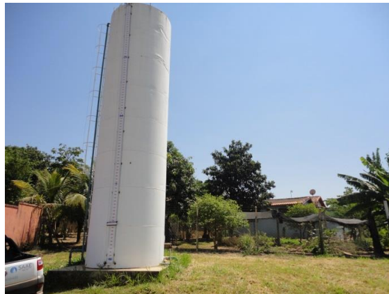
Figura 78. Vista Geral do EAT Santa Isabel e do Reservatório EAT.
