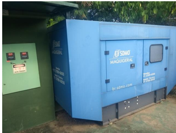
Figura 122. Estação Elevatória de Esgoto – D'Icarai - Vista 3.
