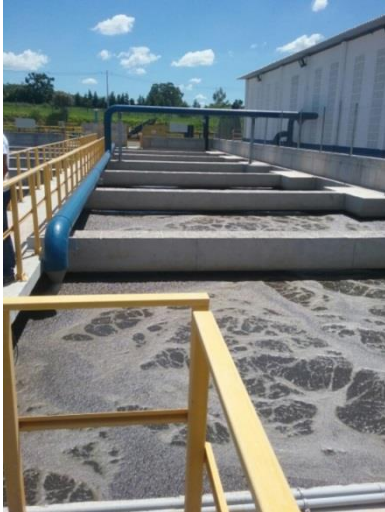
Figura 101. Vista do Tanque de Aeração.
