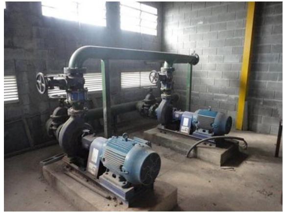
Figura 71. Recalque dos dois conjuntos motor - bomba do EAT Jardim Panorama.
