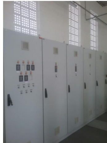
Figura 108. Vista dos painéis elétricos dos Sopradores.
