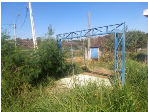
Figura 114. Estação Elevatória – Monte Carlo- Vista 1.
