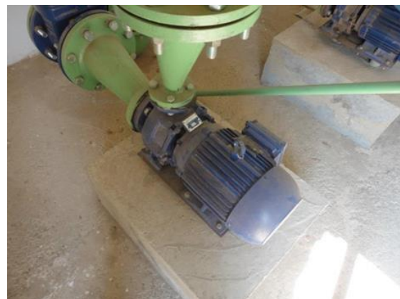
Figura 82. Conjuntos motor - bomba do EAT Portal dos Bandeirantes.
