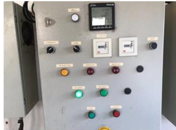
Figura 54. Vista Geral do painel de energia dos conjuntos motor bomba do EAT Prefeitura.
