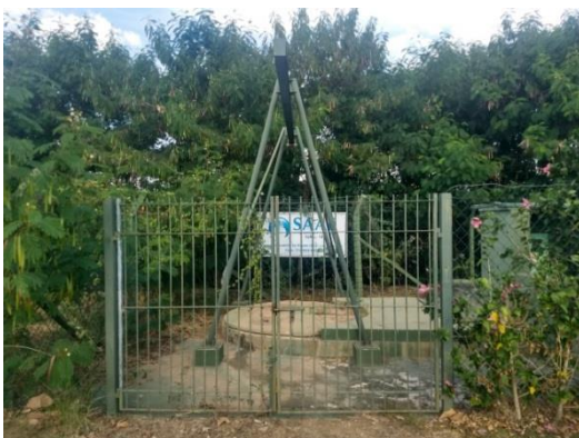
Figura 120. Estação Elevatória de Esgoto – D'Icarai - Vista 1.
