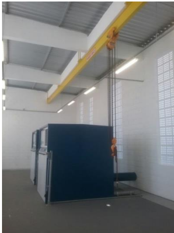
Figura 107. Vista do Sistema de Aeração por sopradores tipo "roots".
