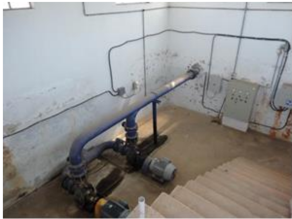
Figura 42. Conjunto –motor bomba para o abastecimento do Reservatório Elevado – REL 03.
