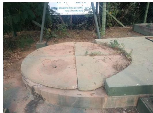
Figura 121. Estação Elevatória de Esgoto – D'Icarai - Vista 2.
