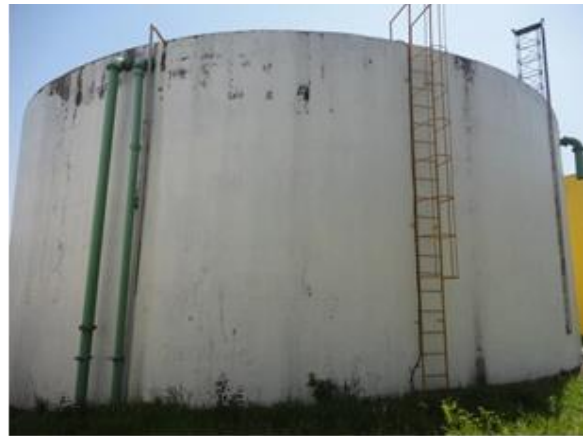
Figura 48. Reservatório Semi-Enterrado: EAT Jardim Cidade (Siemens).
