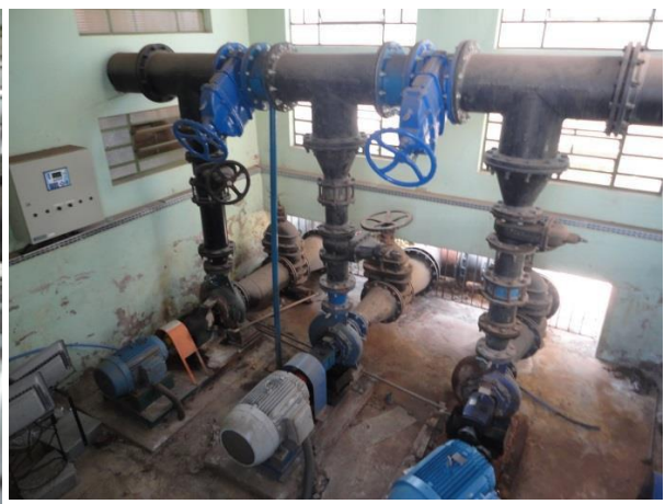
Figura 66. Recalque dos três conjuntos motor - bomba do EAT João Jabour
