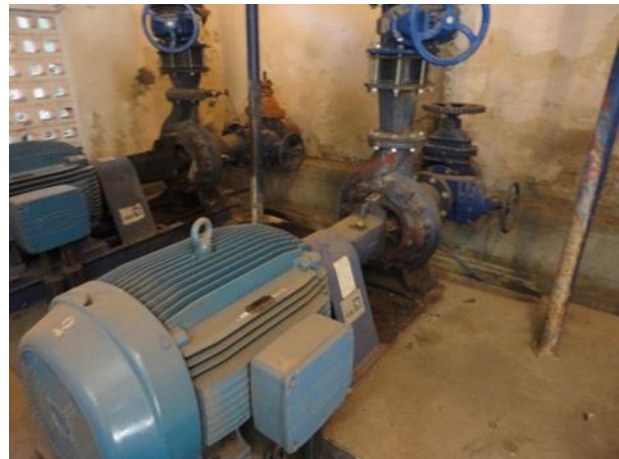
Figura 46. Vista Geral dos conjuntos motor-bomba do Booster dos Trabalhadores.
