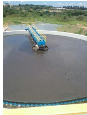
Figura 104. Vista do módulo de Decantação Secundária.
