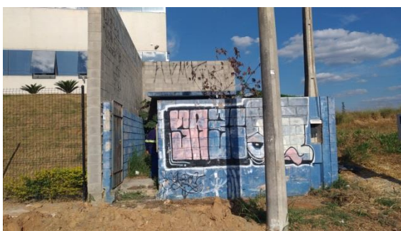
Figura 123. Estação Elevatória de Esgoto – Bandeirantes - Vista 1.
