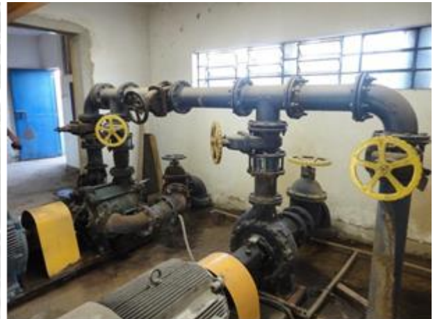
Figura 44. Vista Geral dos conjuntos motor-bomba do Booster Estação.
