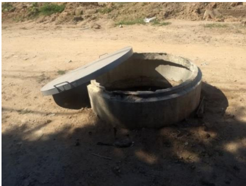
Figura 116. Elevatória de Esgoto – Ribeirão Preto.
