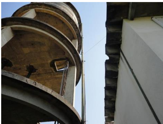
Figura 57. Reservatório Elevado EAT Jurumirim.
