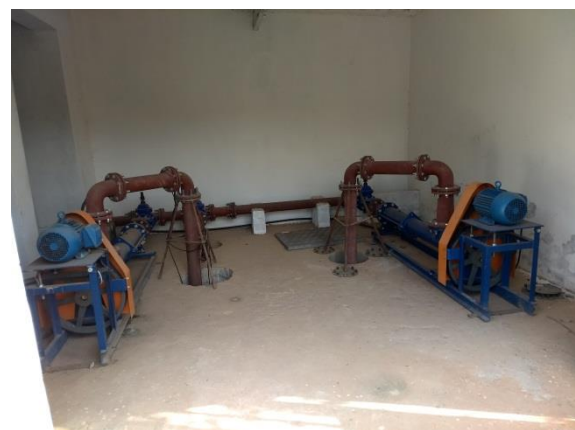
Figura 132. Estação Elevatória de Esgoto – Portal dos Bandeirantes - Vista 2.
