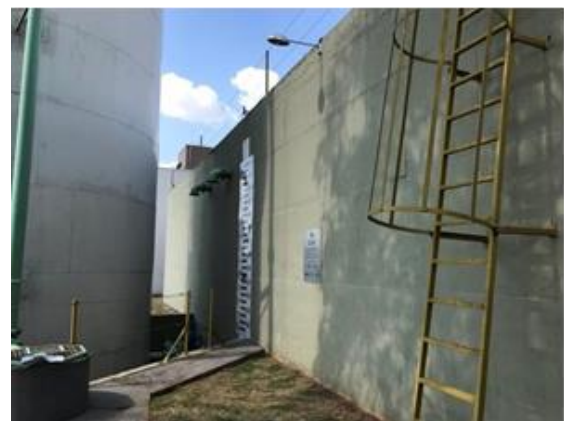
Figura 77. Reservatório Apoiado EAT D'Icaraí.
