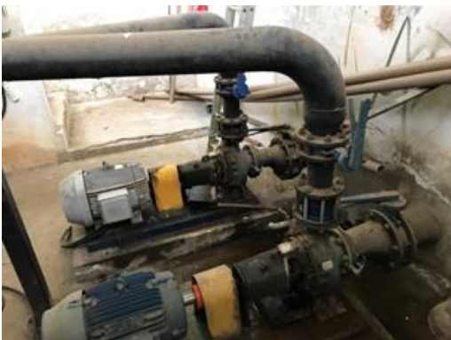
Figura 37. Conjunto –motor bomba para o abastecimento do Reservatório Elevado do EAT Nova Era.
