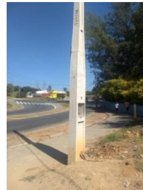
Figura 117. Vista do poste onde localiza-se o disjuntor de acionamento da bomba.
