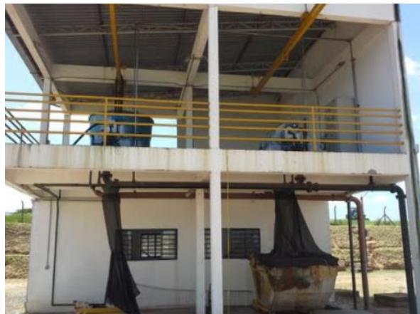
Figura 96. Vista do sistema de Desidratação de lodo por centrifugação.
