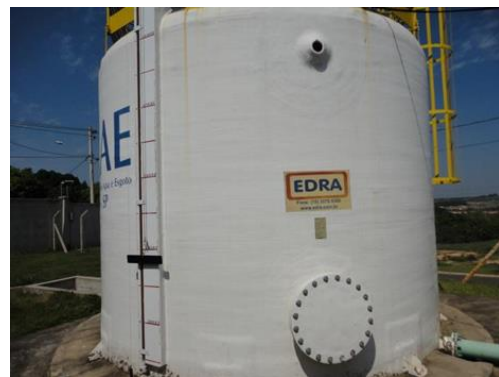
Figura 80. Reservatório Apoiado EAT Portal dos Bandeirantes.
