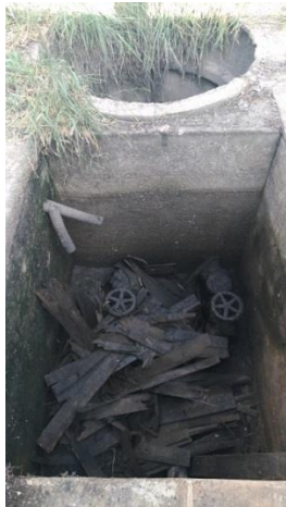
Figura 125. Estação Elevatória de Esgoto – Bandeirantes - Vista 3.
