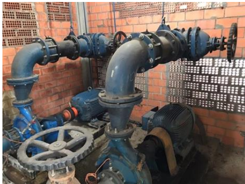
Figura 33. Vista Geral dos conjuntos motor-bomba do Booster Telesi.
