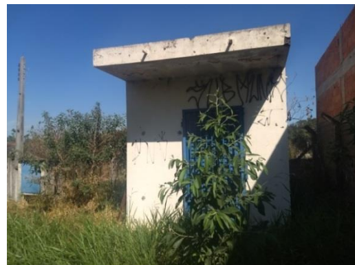
Figura 115. Estação Elevatória – Monte Carlo - Vista 2.
