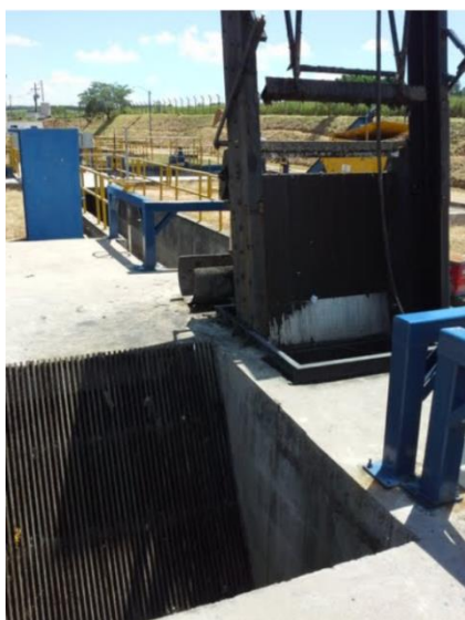
Figura 97. Vista do Gradeamento Grosseiro do efluente bruto.
