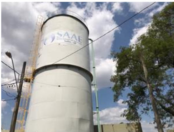
Figura 76. Reservatório Elevado EAT D'Icaraí.
