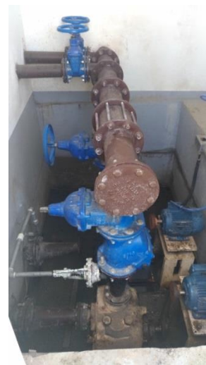
Figura 134. Estação Elevatória de Esgoto – Moutonnée - Vista 2.
