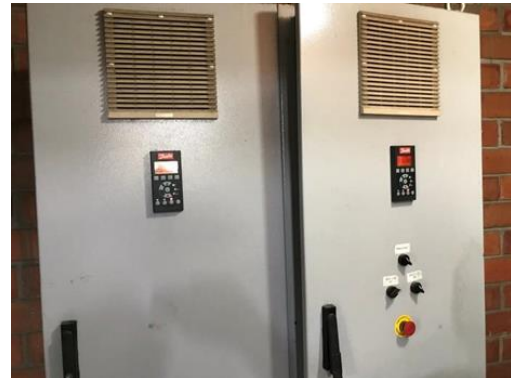
Figura 34. Vista Geral dos Painéis de Energização do Booster Telesi.
