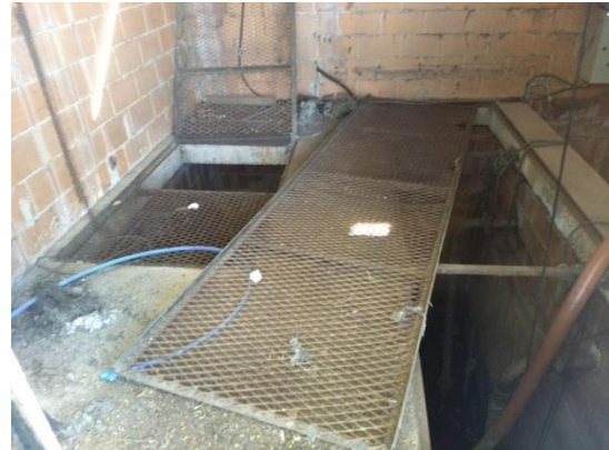
Figura 119. Estação Elevatória de Esgoto – Casa Verde - Vista 2.
