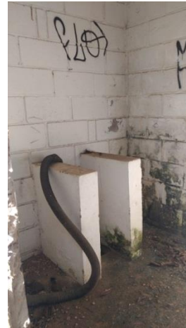
Figura 126. Estação Elevatória de Esgoto – Bandeirantes- Vista 4.
