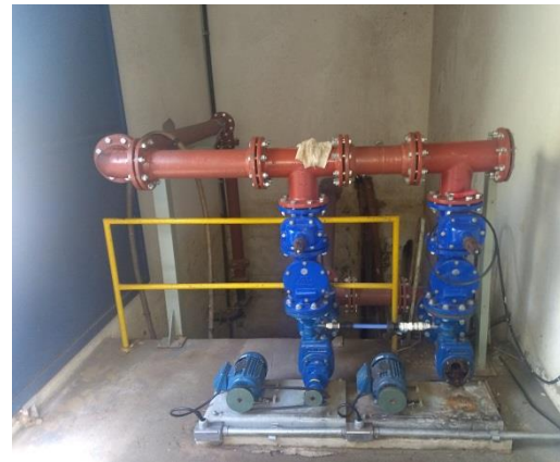
Figura 111. Vista do conjunto motor-bomba.
