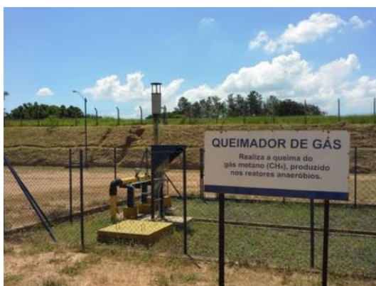
Figura 105. Vista do Sistema de Queima de gás Metano.
