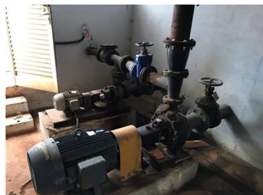
Figura 32. Conjunto motor bomba para o abastecimento da rede de distribuição e Reservatório Apoiado Icaraí.
