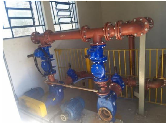
Figura 113. Vista do conjunto motor-bomba.
