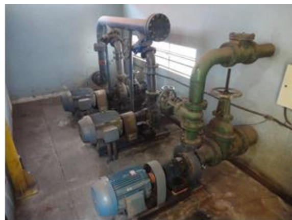
Figura 50. Conjuntos motor - bomba do EAT Jardim Cidade (Siemens).
