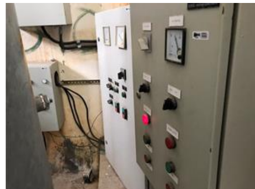
Figura 38. Vista Geral dos painéis de energia do conjunto motor bomba do EAT Nova Era.
