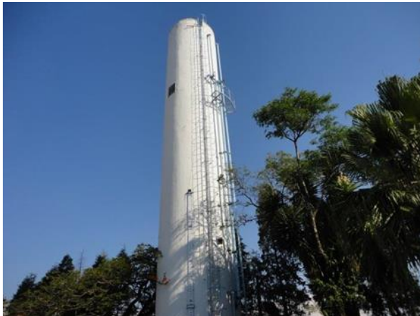
Figura 61. Reservatório Elevado EAT Haras Paineiras.
