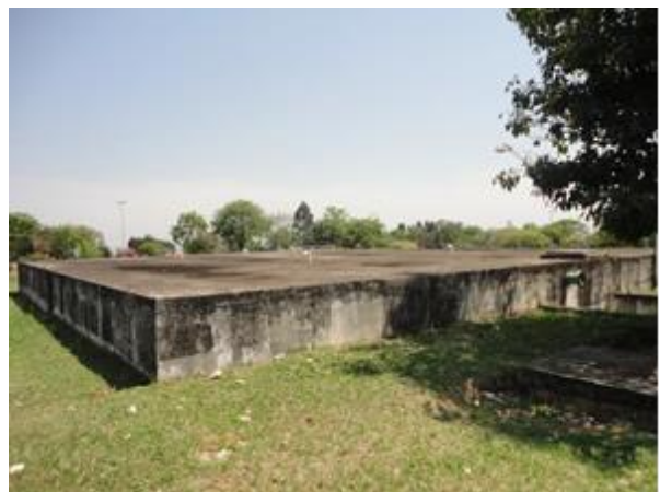
Figura 40. Reservatório Semi-Enterrado: RSE 01 EAT Santa Cruz.
