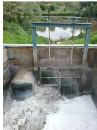
Figura 94. Vista do ponto de lançamento de efluente tratado no Rio Tietê.
