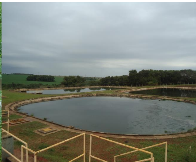
Foto 3.21 – Vista Geral das 3 Lagoas de Tratamento
