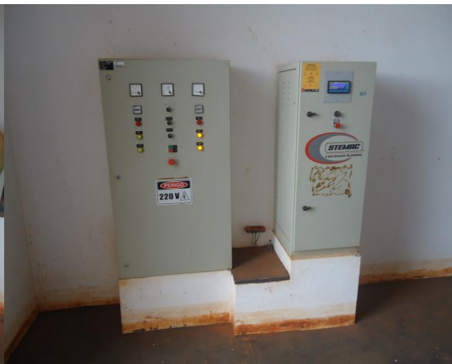
Foto 3.13 – Vista do Painel Elétrico da Bomba
