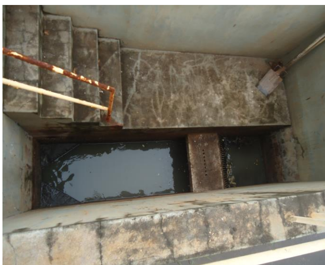
Foto 3.10 – Tratamento Preliminar na EEE1
