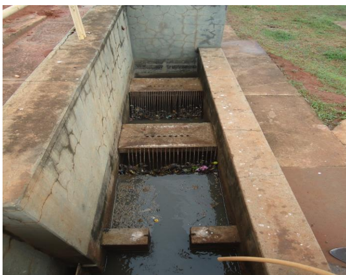
Foto 3.14 – Gradeamento do Tratamento Preliminar
