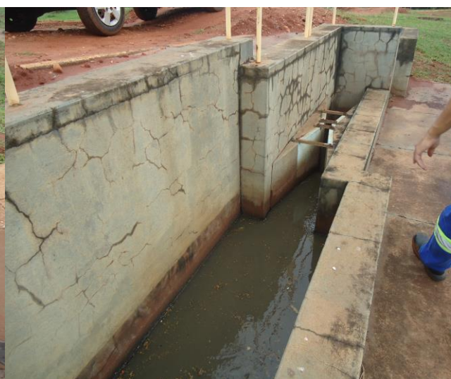
Foto 3.15 – Desarenador + Calha Parshall
