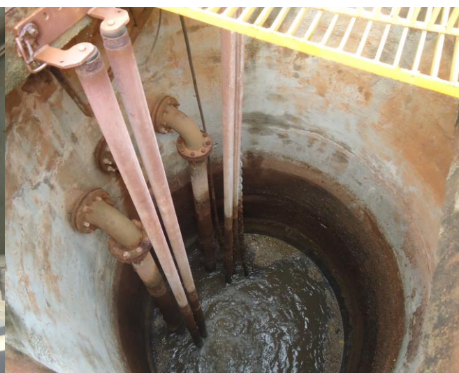
Foto 3.11 – Vista do Poço de Sucção
