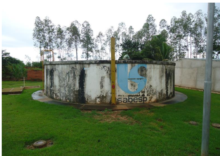
Foto 3.9 – Reservatório Semienterrado - SABESP
