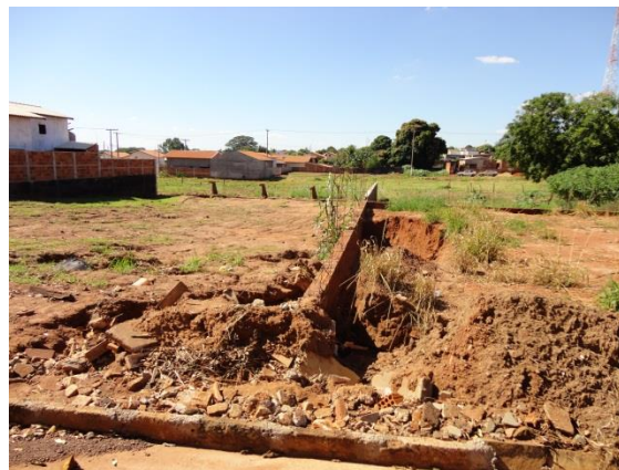
Foto 3.10- Ponto de Alagamento na rua Olímpio Estevam de Lacerda devido ao mal dimensionamento da rede existente.
