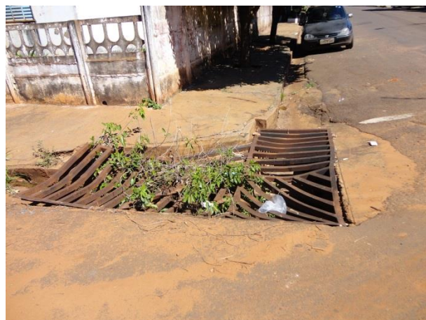
Foto 3.6 - Grelhas de captação no cruzamento entre as Ruas Santa Catarina e José Alves de Oliveira
