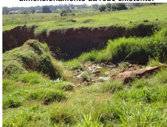
Foto 3.12 – Erosão no ponto de dissipação da galeria da rua Pedro Prudente de Moraes.
