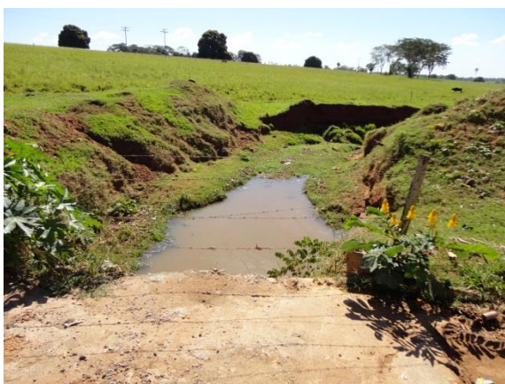
Foto 3.11 – Ponto de Erosão na dissipação no ponto de lançamento 2 na rua Osvaldo Florindo de Souza
