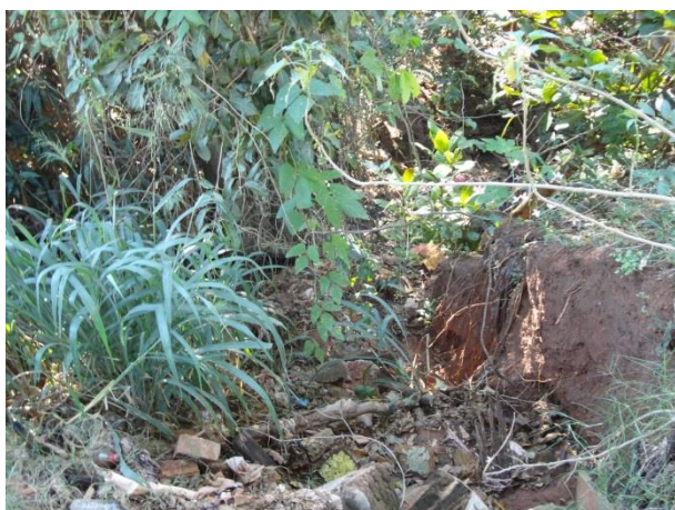
Foto 3.7 – Erosão no ponto de lançamento próximo a rua Pará – Dissipação realizada diretamente no solo, sem nenhum dissipador de energia.
