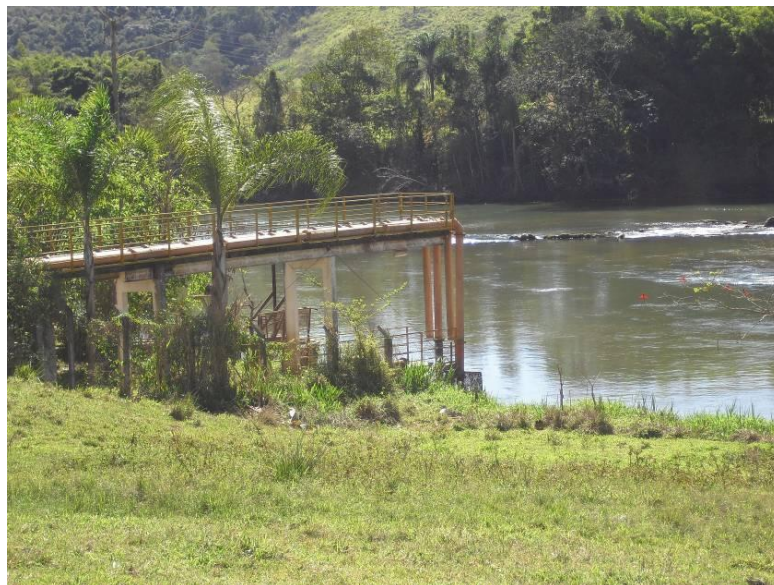
Foto 01 – Tubulações de Sucção da Captação no Rio Paraíba do Sul.
