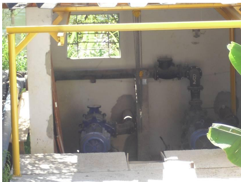
Foto 02 – Instalações do Sistema de Bombeamento da Captação no Rio Paraíba do Sul.
