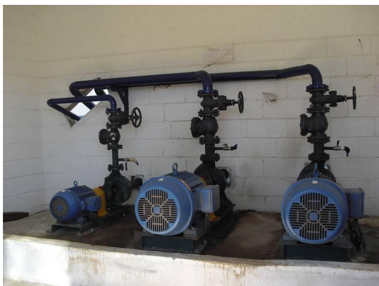
Foto 04 – Vista das Unidades de Bombeamento da ETA.
