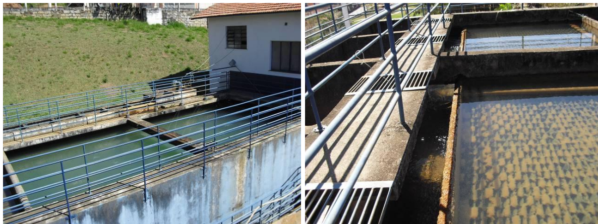
Foto 03 – Vista Geral das Unidades de Tratamento da ETA.
