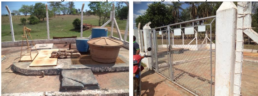
Figura 44. Estação elevatória esgoto (EEE - 1)
