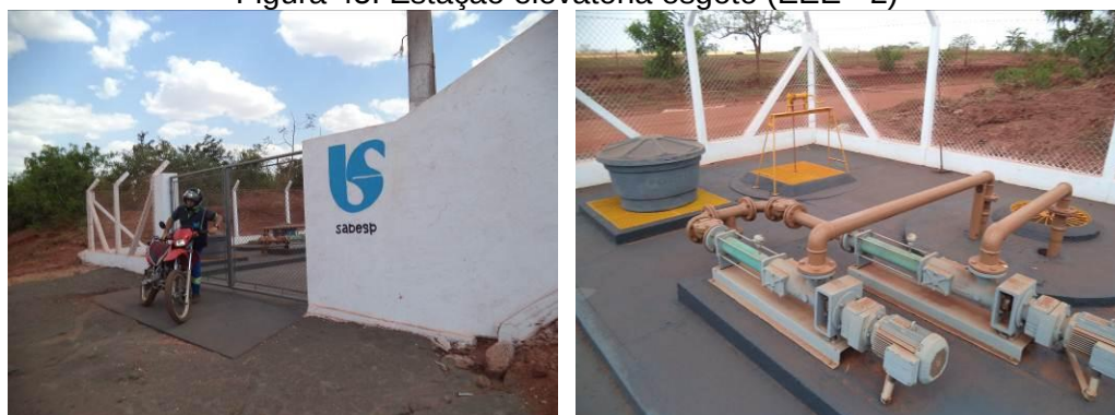
Figura 45. Estação elevatória esgoto (EEE - 2)
