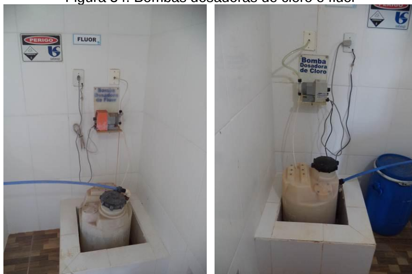
Figura 34. Bombas dosadoras de cloro e flúor
