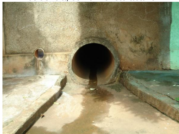
Figura 57. Rua Antônio Facincani, notou-se a instalação inadequada de um tubo de concreto, com diâmetro de 0,60 m, localizado sobre a calçada, saindo do muro de uma residência, conforme foto abaixo.
