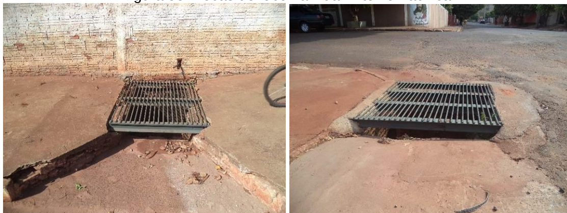
Figura 53. Bocas de lobo na Rua Antônio Facincani
