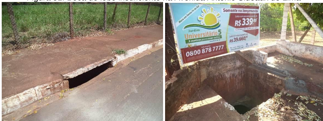
Figura 51. Boca de lobo insuficiente na Avenida Antônio Sideaux de Lima
