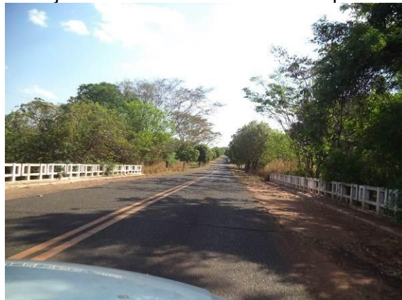
Figura 56. Ponte na via principal de acesso ao Município, o local sofre inundações em dias fortes chuvas, porem já foi obtido recurso financeiro para a substituição da ponte.
