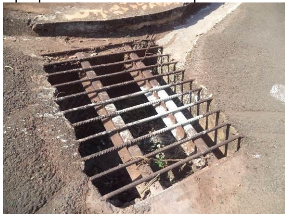
Figura 55. Bocas de lobo na Rua Isaura Brígida com a Rua Cincinato Francisco de Oliveira – no momento do registro foi possível observar que havia cimento recém lançado na boca, o que pode ser motivo do entupimento de outras bocas de lobo.
