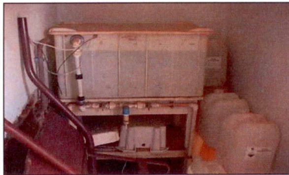
Foto 3 - Tanque de diluição de produto químico
