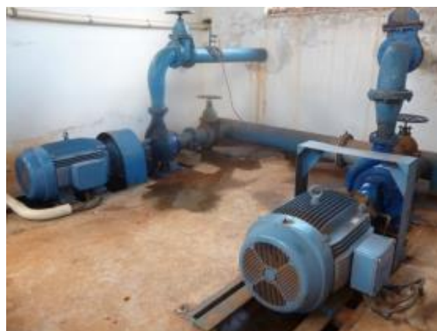
Foto 4.50 – Conjuntos Motobomba da EEAT 4
