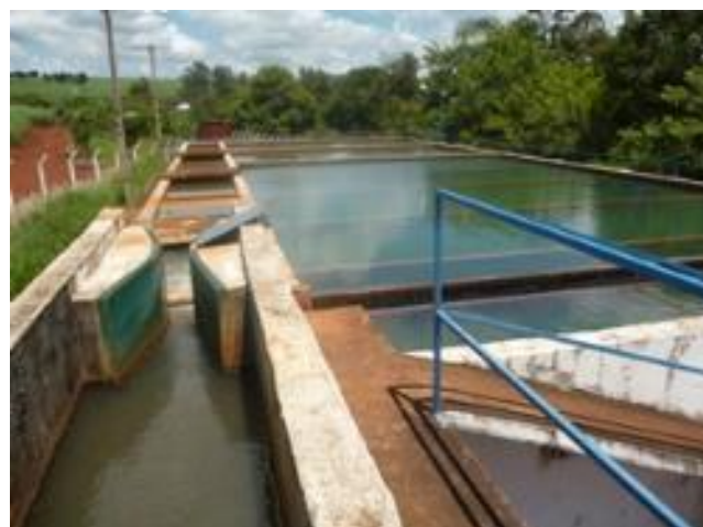
Foto 4.25 – ETA Schianon – Vista Geral
