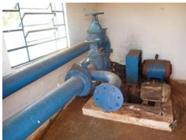
Foto 4.14 – Conjuntos Motobomba da EEAB 2
