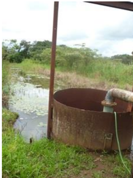
Foto 4.19 – Conjunto Motobomba da EEAB 5 Poço de Sucção do Conjunto Motobomba da EEAB 5
