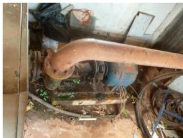
Foto 4.52 – Conjuntos Motobomba da EEAT 4
