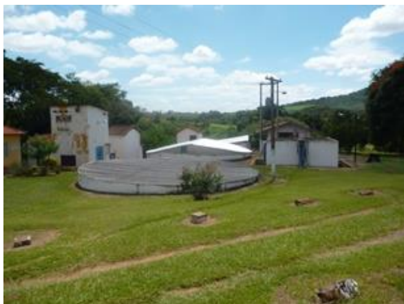
Foto 4.33 – Centro de Reservação ETA Aurora – R-06, R-07 e R-08
