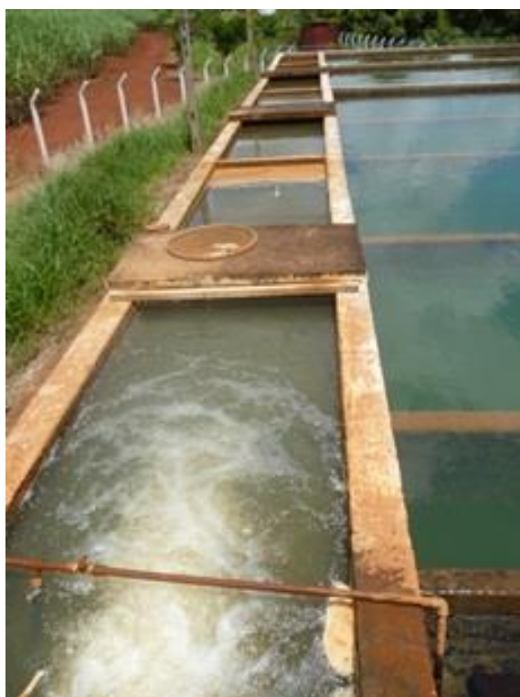
Foto 4.24 –ETA Schianon – Flocculadores
