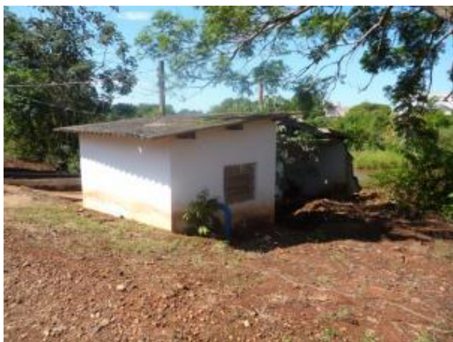
Foto 4.45 – Casa de Bombas da EEAT 2
