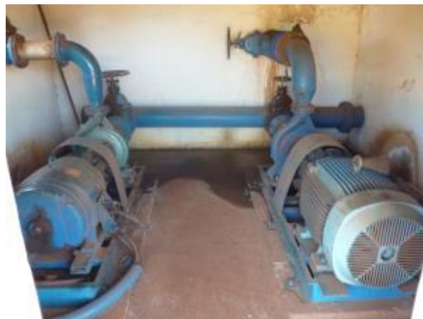
Foto 4.44 – Conjuntos Motobomba da EEAT 1
