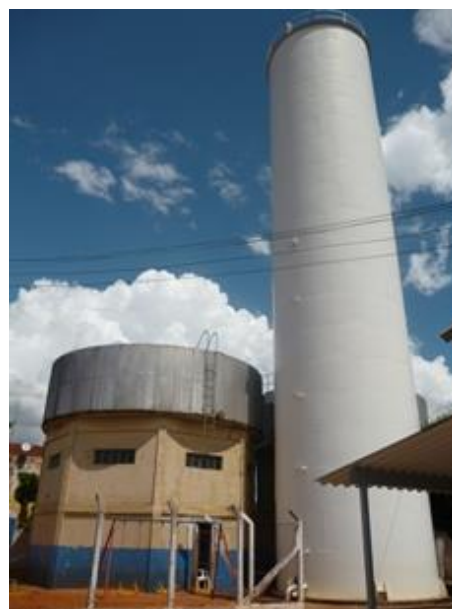
Foto 4.34 – Reservatório Jardim Brasil – R-09
