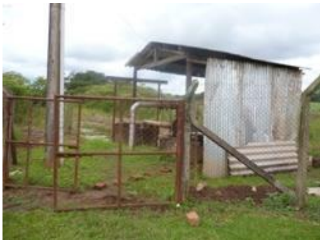
Foto 4.18 – Casa de Bomba da EEAB 5
