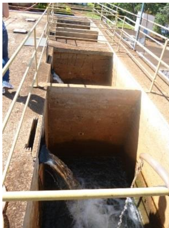
Foto 4.22 – ETA Davi – Filtros
