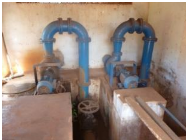
Foto 4.12 – Conjuntos Motobomba da EEAB 1
