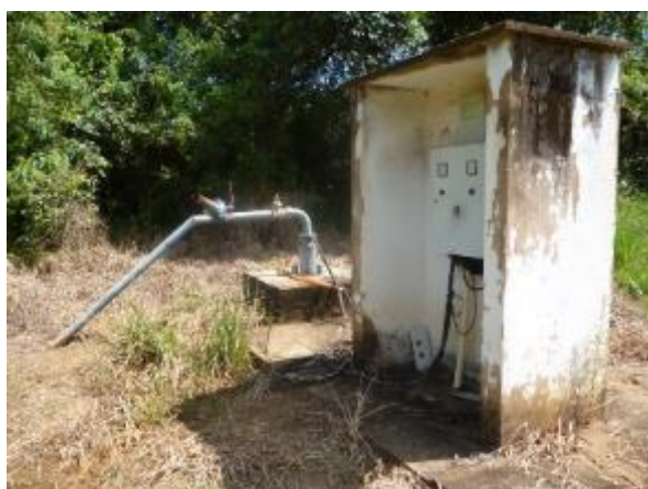
Foto 4.8 – Poço Profundo P-01
