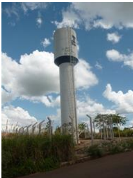
Foto 4.38 – Reservatório Vila Altaraju – R-13
