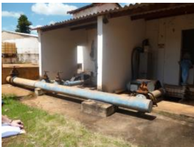
Foto 4.51 – Casa de Bombas e Conjuntos da EEAT5
