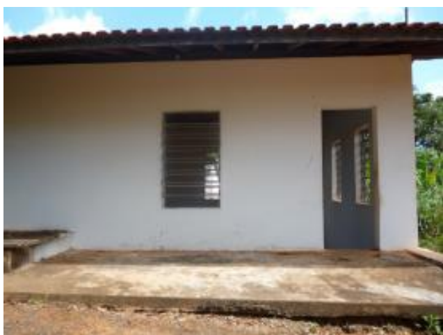
Foto 4.49 – Casa de Bombas da EEAT 4
