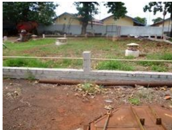
Foto 4.40 – Reservatório Enterrado Almojarifado – R-15
