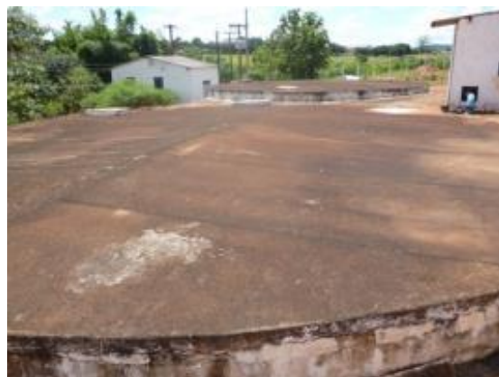
Foto 4.32 – Centro de Reservação ETA Schianon – R-04 e R-05
