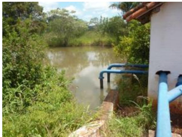
Foto 4.4 – Casa de Bombas e Sucção da EEAB 2
