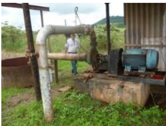
Foto 4.20 – Conjunto Motobomba da EEAB 5
