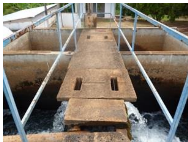
Foto 4.30 – ETA Aurora – Filtros
