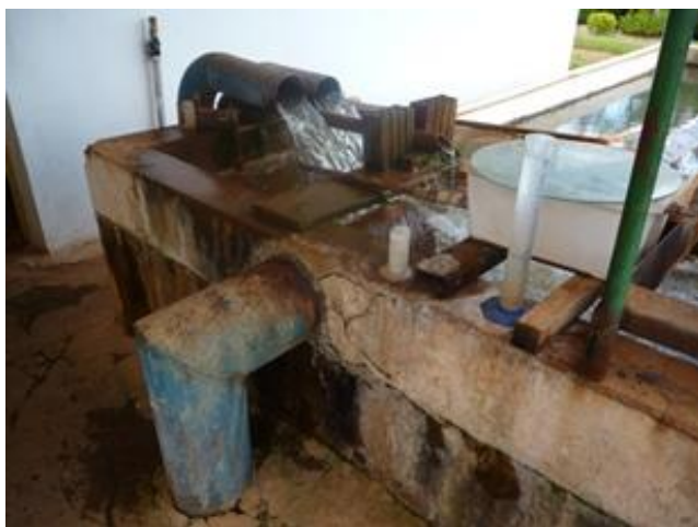
Foto 4.27 – ETA Aurora – Chegada das Águas Brutas ao Tratamento
