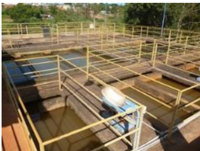
Foto 4.23 – ETA Davi – Floculadores e Decantadores
