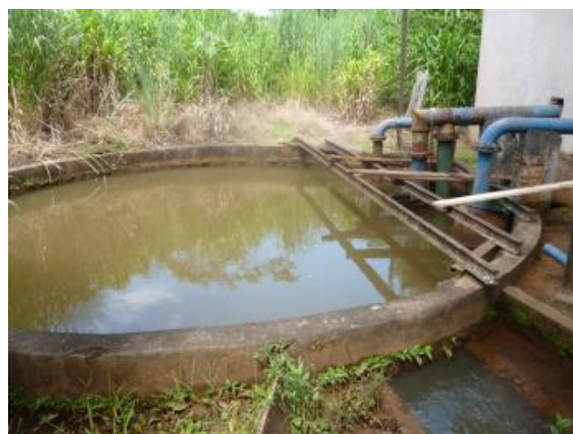
Foto 4.6 – Poço de Sucção da EEAB 4 – Recebe Água Bruta da Barragem de Nível I e Lago Artificial
