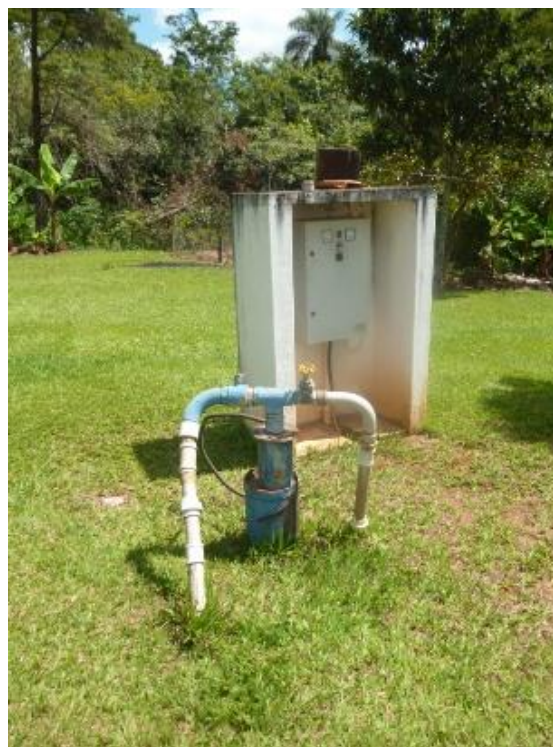
Foto 4.9 – Poço Profundo P-03
