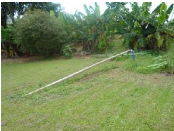
Foto 4.10 – Poço Profundo P-02
