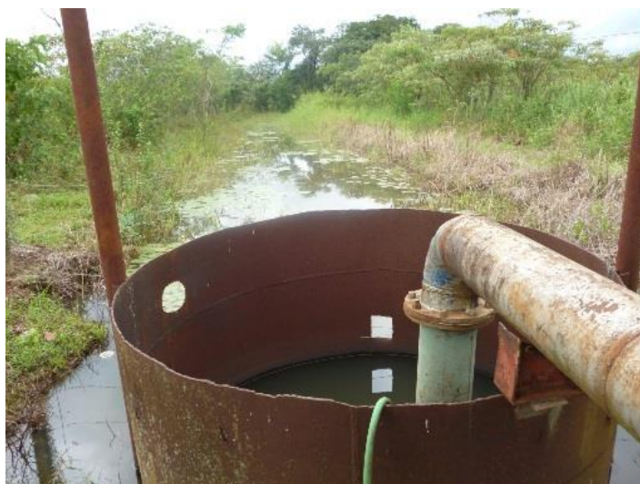
Foto 4.7 – Canal de Derivação da Barragem de Nível II do Córrego Tabaranas e Poço de Sucção
