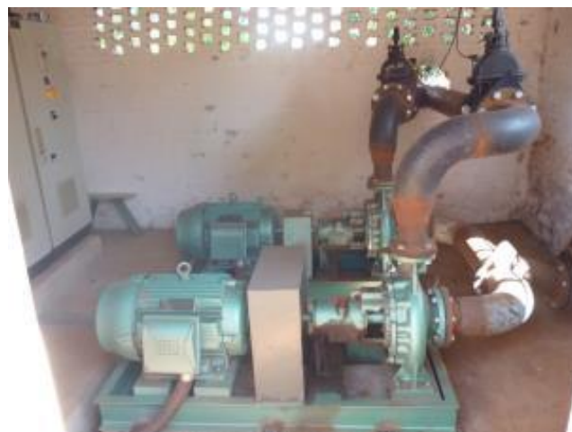
Foto 4.46 – Conjuntos Motobomba da EEAT 2
