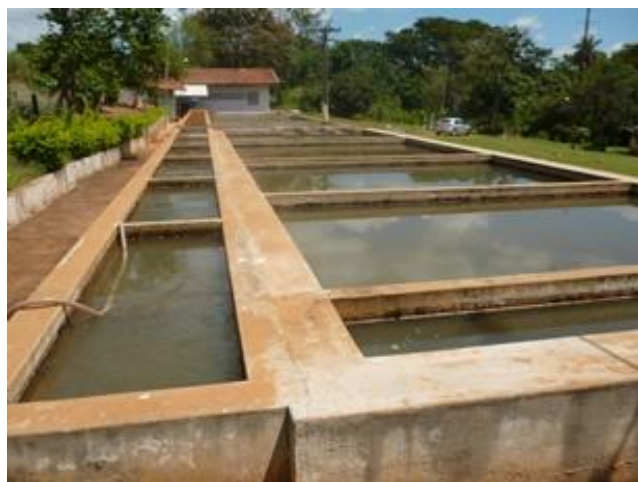
Foto 4.28 – ETA Aurora – Vista Geral – Floculadores e Decantadores
