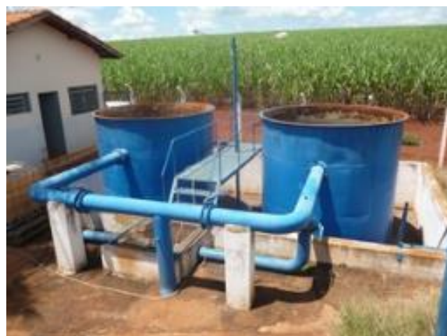
Foto 4.26 – ETA Schianon – Filtros
