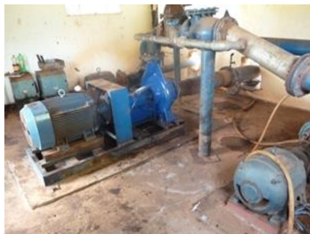
Foto 4.17 – Conjuntos Motobomba da EEAB 4
