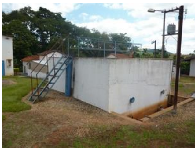
Foto 4.29 – ETA Aurora – Filtros
