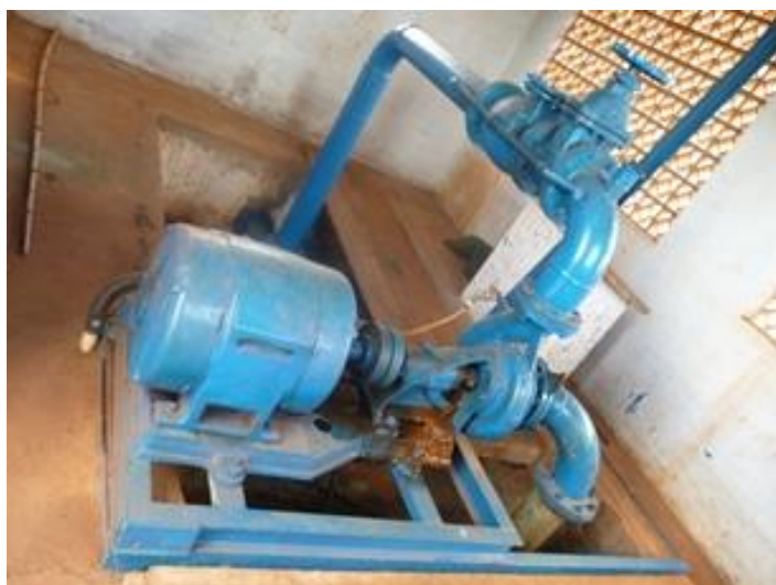
Foto 4.15 – Casa de Bombas da EEAB 3
