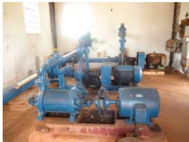
Foto 4.48 – Conjuntos Motobomba da EEAT 3
