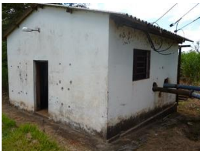
Foto 4.16 – Casa de Bombas da EEAB 4
