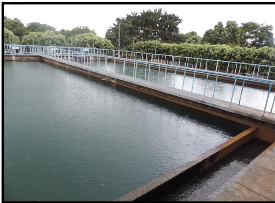
Imagem 26 – Tanque de decantação
