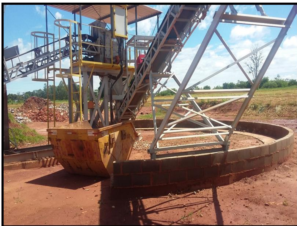
Imagem 95 – Usina de Britagem/Reciclagem de RCC
