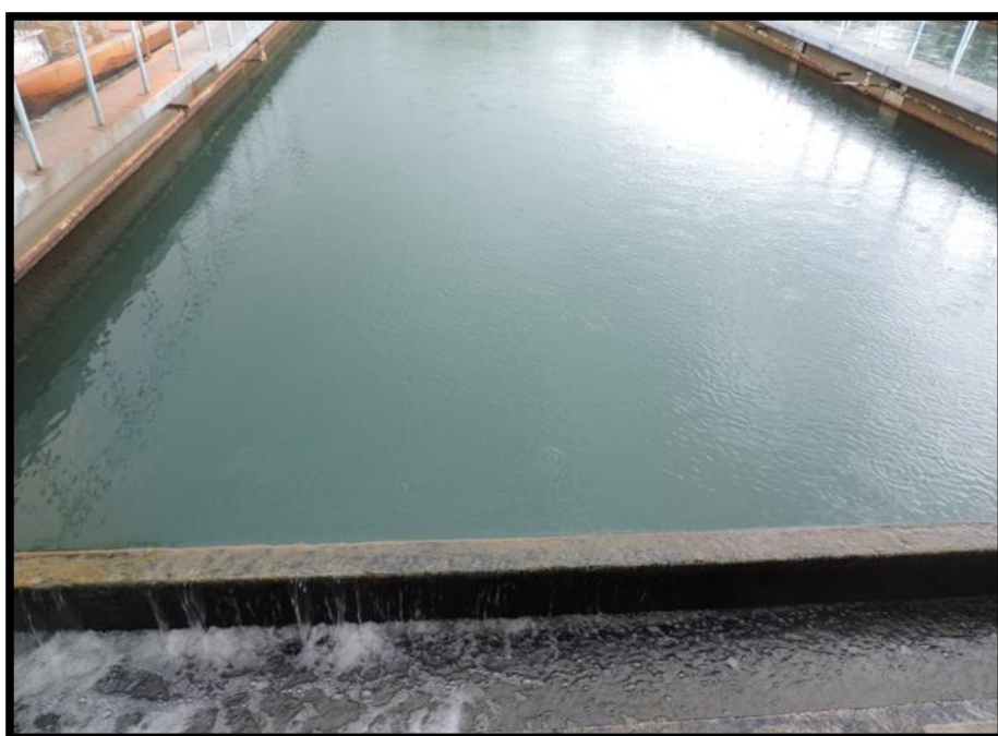
Imagem 27 – Tanque de decantação
