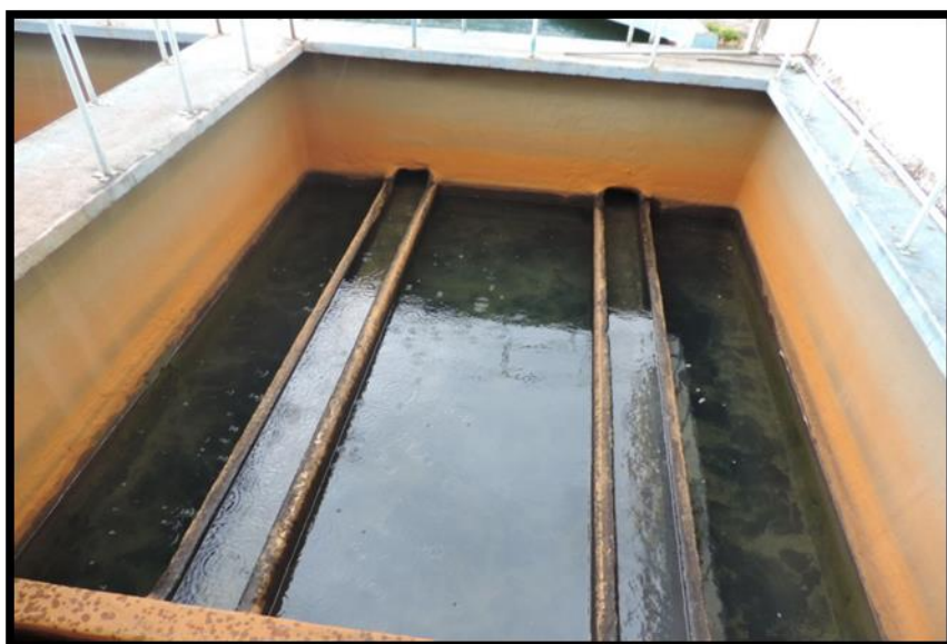
Imagem 29 – Tanque de filtração
