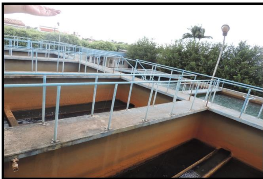
Imagem 28 – Tanque de filtração
