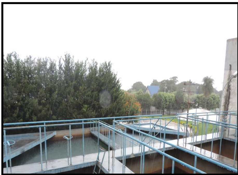
Imagem 30 – Tanque de sucção
