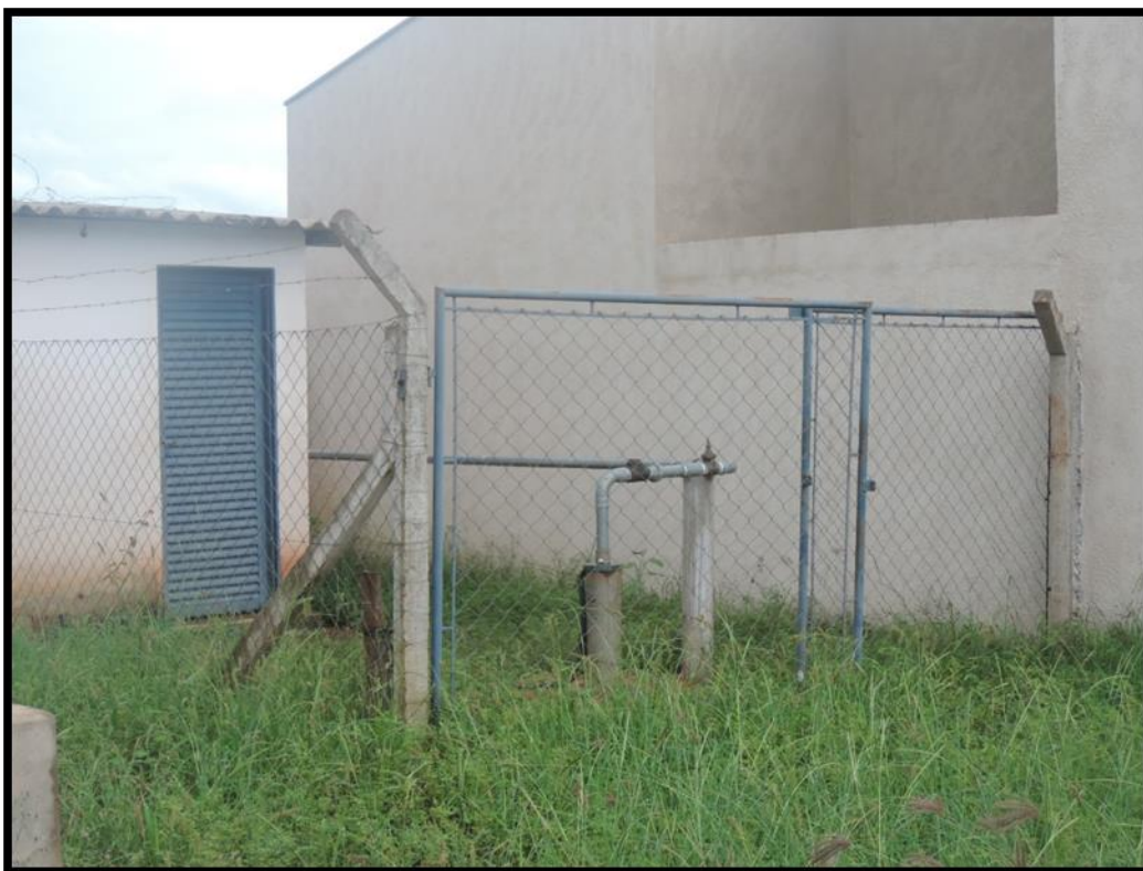
Imagem 9 – Poço Alto Bela Vista
