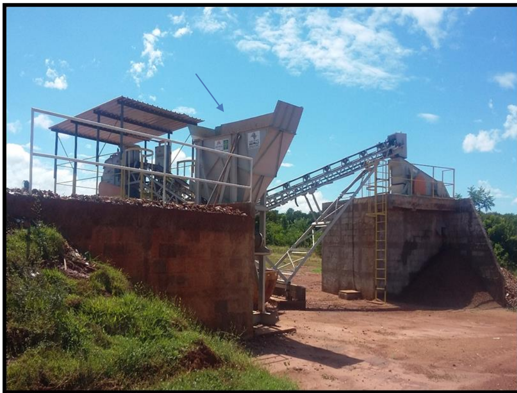
Imagem 96 – Alimentador da Usina de Britagem/Reciclagem de RCC
