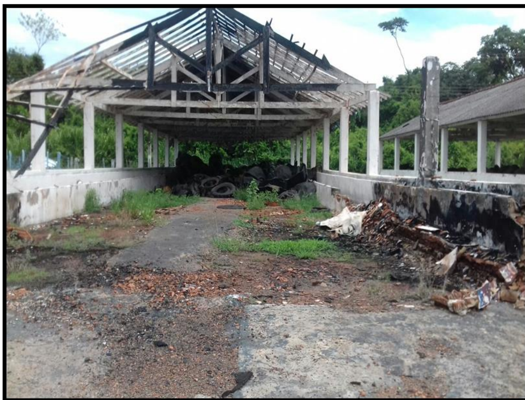
Imagem 112 – Barracão onde são armazenados os pneumáticos
