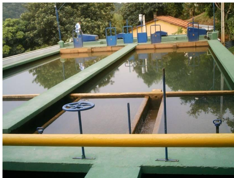
Foto 03 – Unidades de floculação, decantação e filtração da ETA-I (Fonte: Prefeitura Municipal de Santa Isabel)
