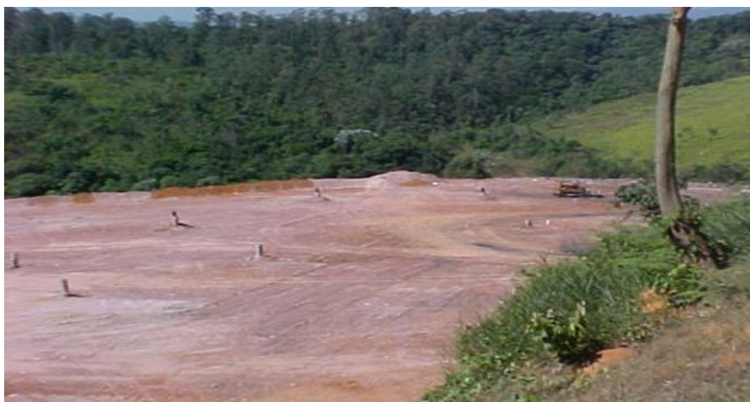
Foto 06 – Drenos Verticais de Gases no Aterro Anaconda em Santa Isabel.
