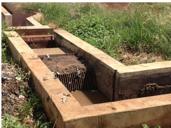
Foto 4.12 - Tratamento preliminar da ETE Ponte Alta
