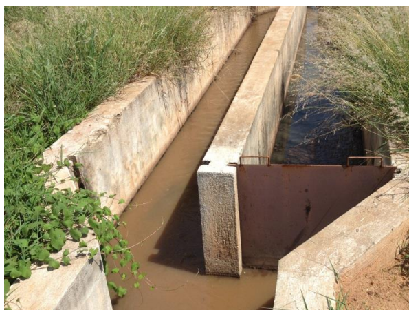
Foto 4.13 - Tratamento preliminar da ETE Ponte Alta
