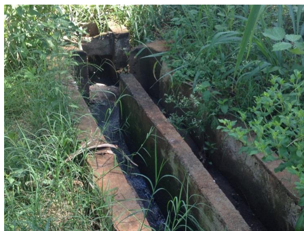
Foto 4.9 - Caixa de areia da ETE Monjolinho
