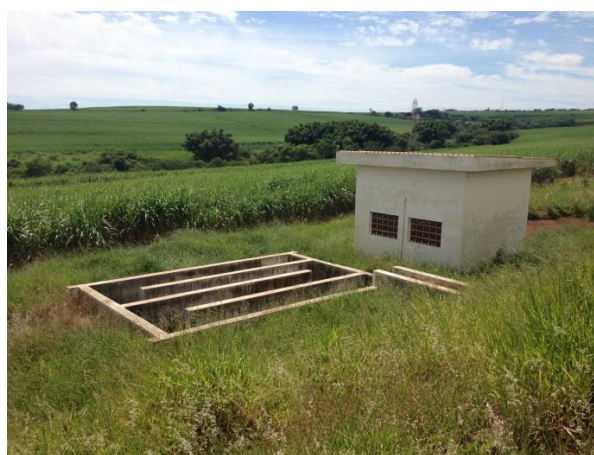
Foto 4.16 - Tratamento químico da ETE Ponte Alta
