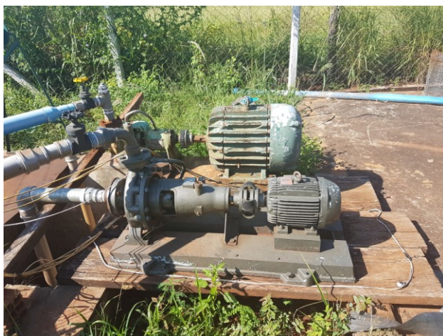
Foto 3.5 – Vista geral das bombas
