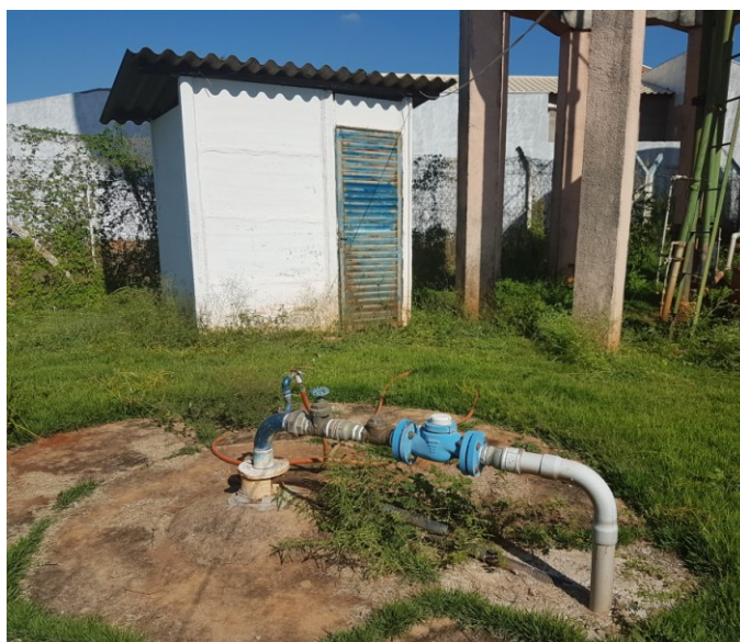
Foto 3.3 – Unidades de Fluoretação e Cloração com bomba dosadora.
