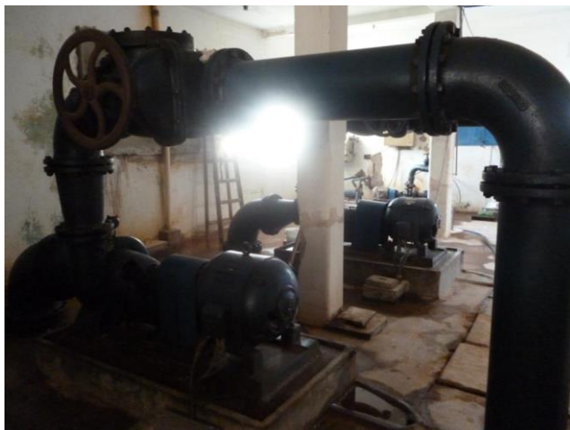
Foto 4.10 - Equipamentos- Lavagem dos Filtros
