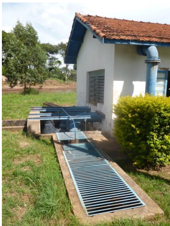
Foto 4.1 – Casa de Bombas 1 – Captação 1
