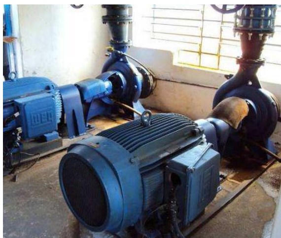
Foto 4.6 - Conjunto moto-bombas EEAB1
