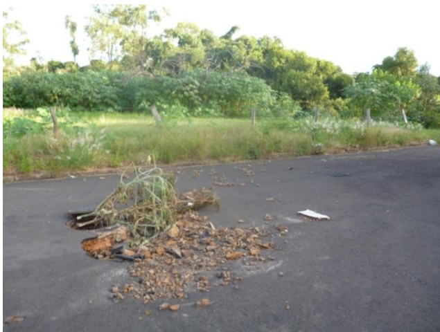
Foto 4.29 - Ponto de erosão na Rua Dorvaldo Ribeiro
