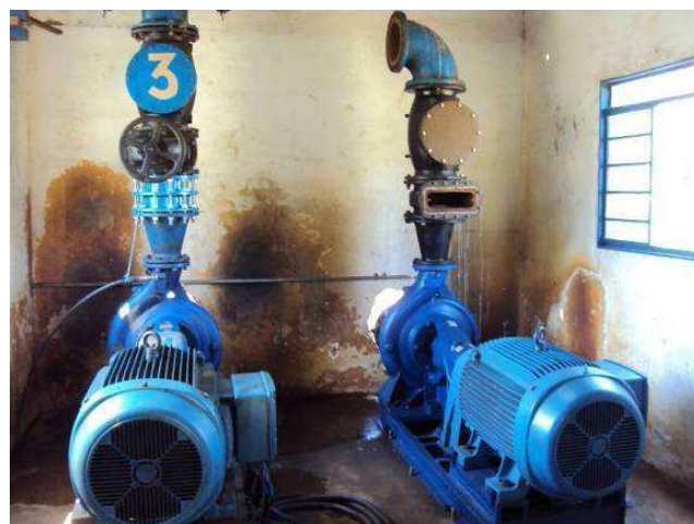
Foto 4.7 - Conjunto moto-bomba EEAB2
