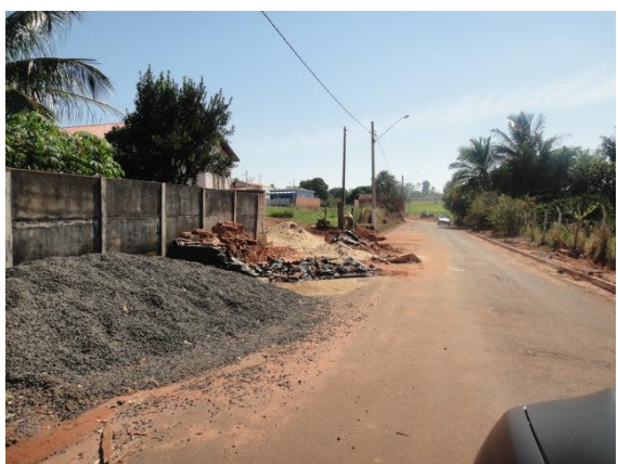
RESIDUOS DE CONSTRUÇÃO NAS VIAS PUBLICAS
