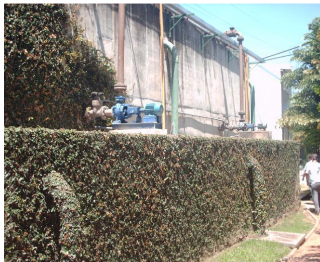
Vista parcial da ETE Tamboré.
