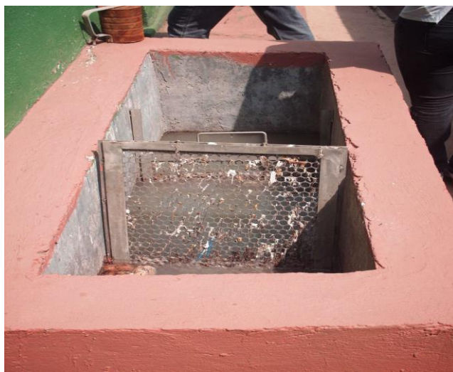
Sistema de gradeamento da ETE Scenic.
