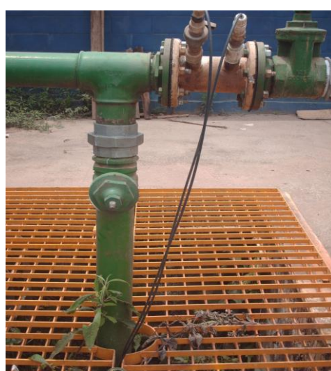
Sistema de dosagem de produtos químicos.
