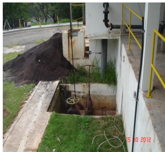
Adutora de água bruta na entrada da ETA.
