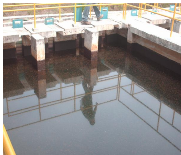
Vista dos flocos formados no decantador.
