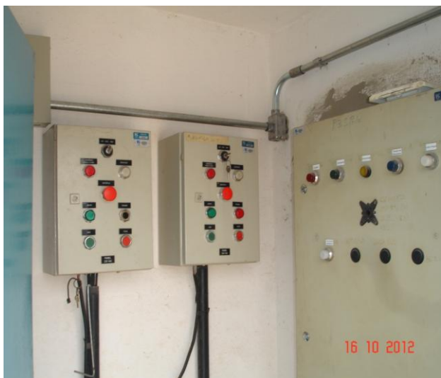
Painel de controle do Booster São Pedro – R4.
