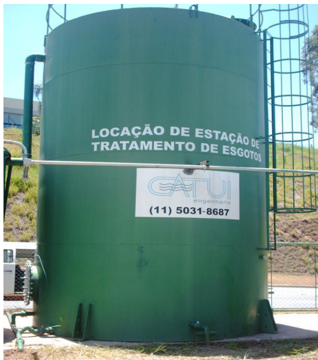
Reator ETE Itayhê.
