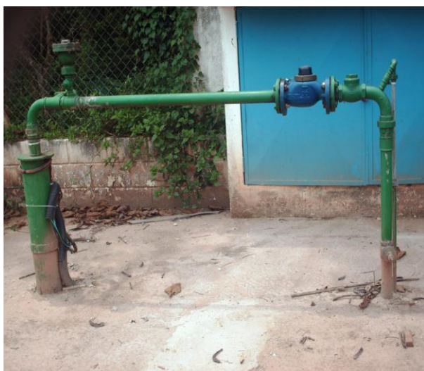
Detalhe do cavalete do Poço 02 – São Pedro.
