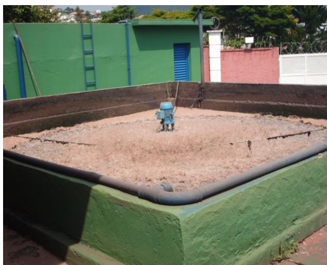
Tanque de aerção.
