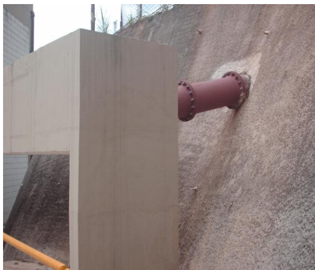
Chegada do esgoto bruto à ETE Aldeia da Serra.
