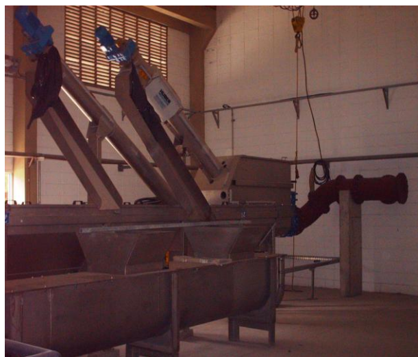
Sistema de tratamento preliminar dos esgotos.
