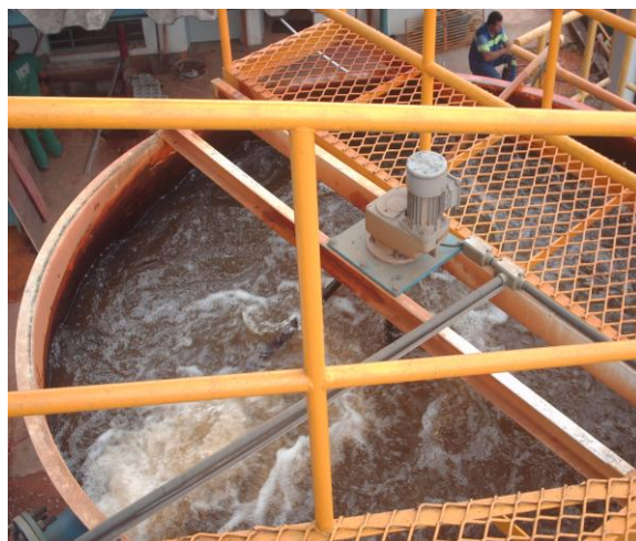
Chegada da água coagulada ao primeiro flocculador da série.
