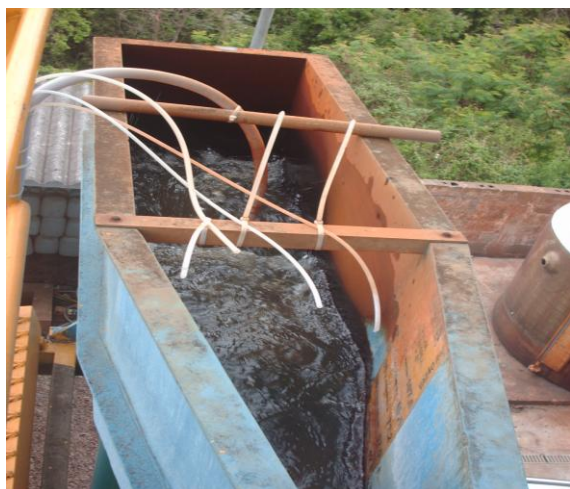
Chegada da água bruta: calha Parshall, detalhe do sistema de aplicação de alcalinizante para ajuste de pH e coagulante.
