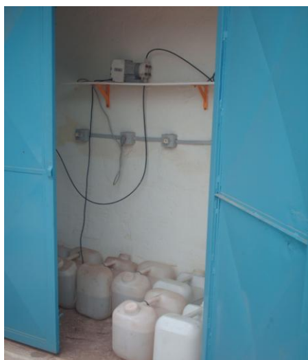
Detalhe das bombas e produtos químicos.
