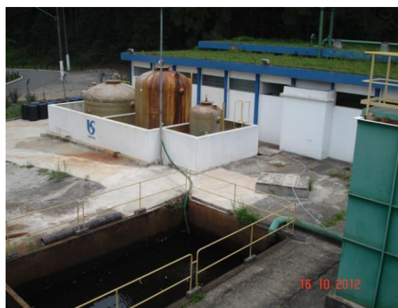
Vista do reservatório que armazena água de lavagem dos filtros e dos reservatórios de produtos químicos e ao fundo a instalação da EEAT.
