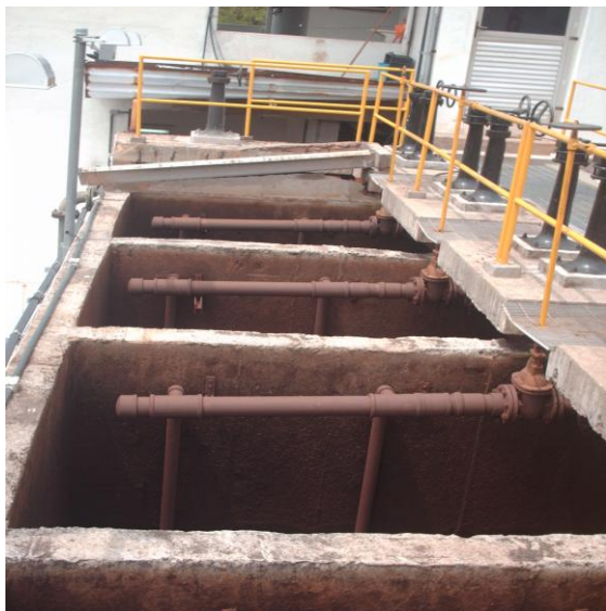
Vista superior dos filtros..
