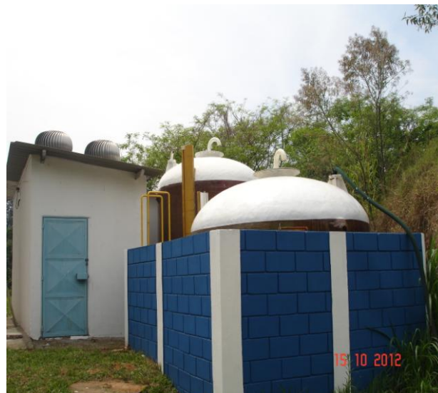
Tanques de armazenamento de produto químico e instalação de armazenamento de gás cloro.
