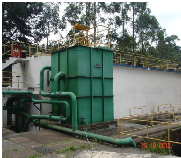
Filtro complementar instalado ao lado da ETA.
