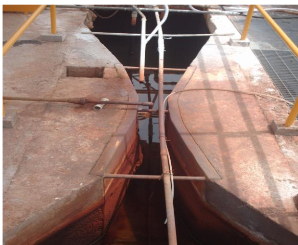
Chegada da água bruta: calha Parshall, detalhe do sistema de aplicação de coagulante.
