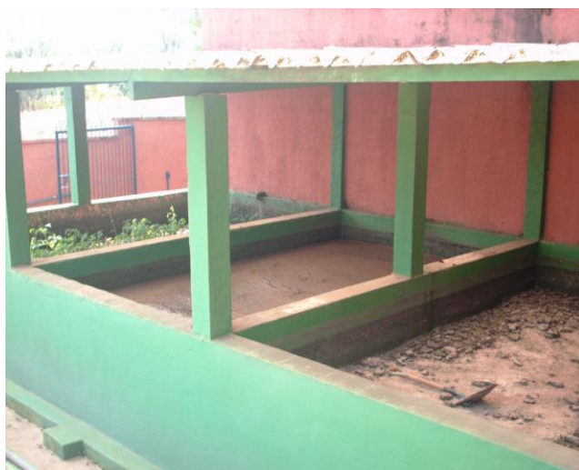
Leito de secagem de lodo.
