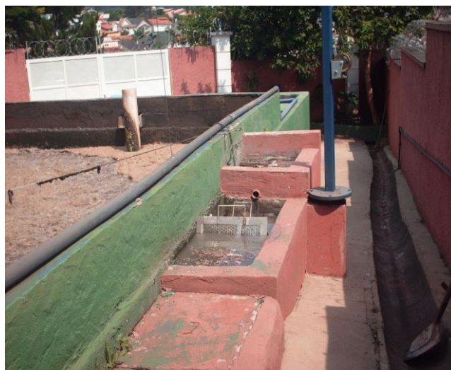
Vista parcial da ETE Scenic.
