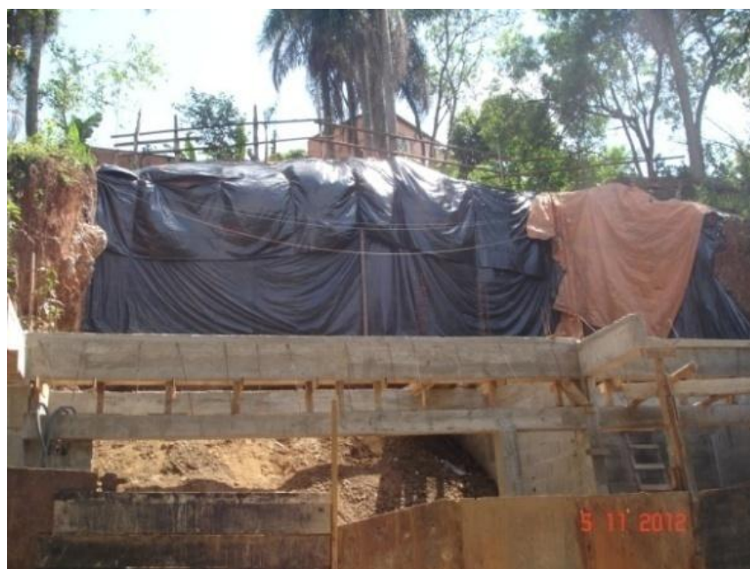
Figura 13- Falta de estruturas de estabilização do talude.
