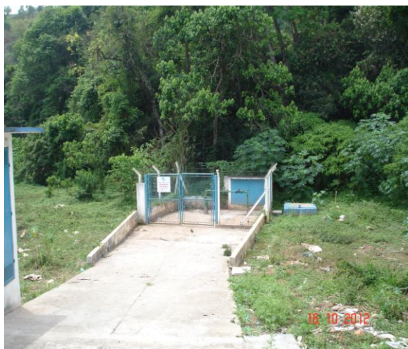
Poço 02 – São Pedro.
