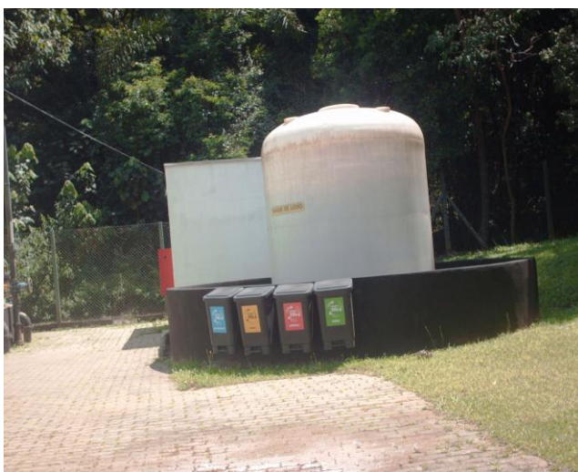
Tanque de armazenamento de lodo.
