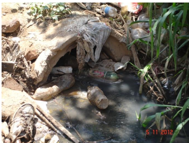
Figura 3- Falta de manutenção do sistema
