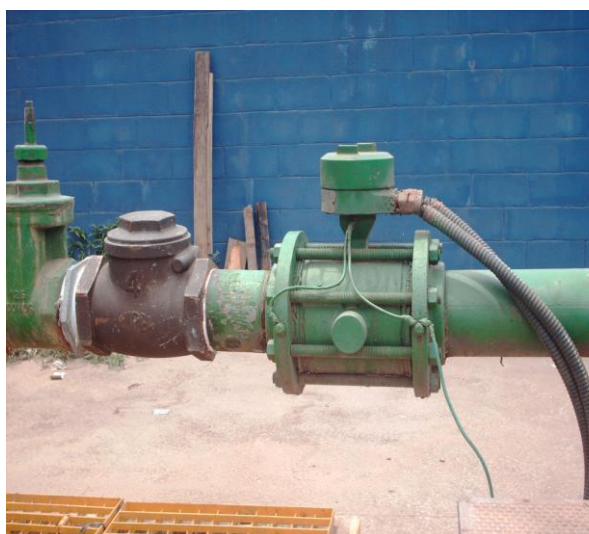
Medidor de vazão.
