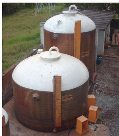
Tanques de armazenamento de produtos químicos.
