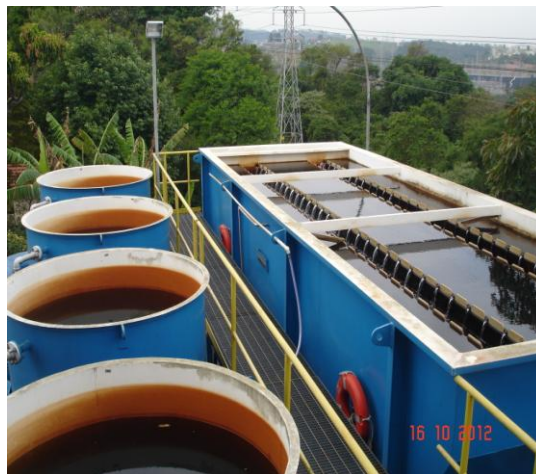
Vista superior do decantador e filtros.
