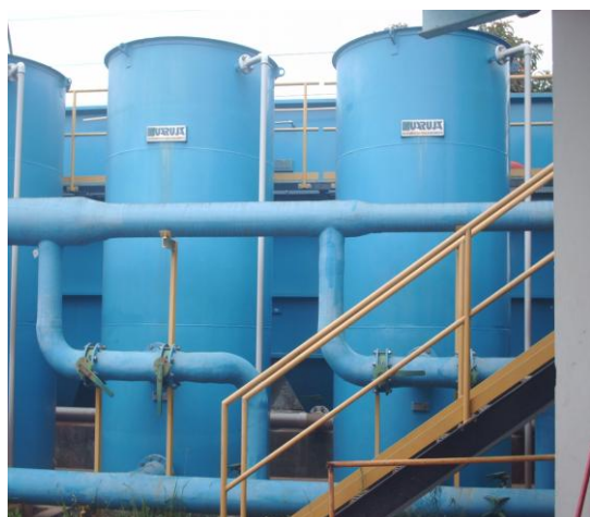
Vista lateral dos filtros.
