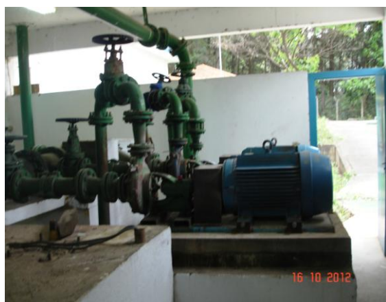
Detalhe das bombas da EEAT existente junto à ETA.
