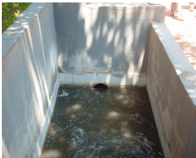
Efluente tratado para reúso.
