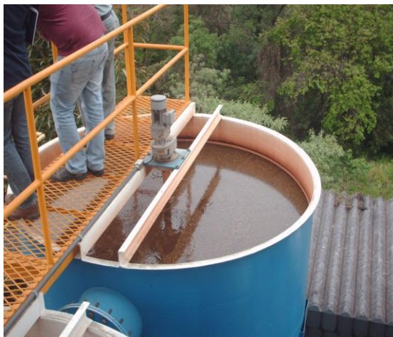
Água passando pelo último flocculador da série, nota-se a presença dos flocos formados.
