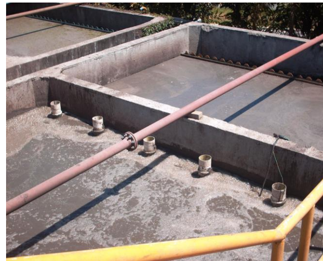
Vista do tanque de aeração e decantador.
