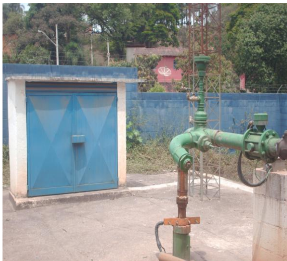
Detalhe da instalação onde são abrigados as bombas dosadoras e os produtos químicos.
