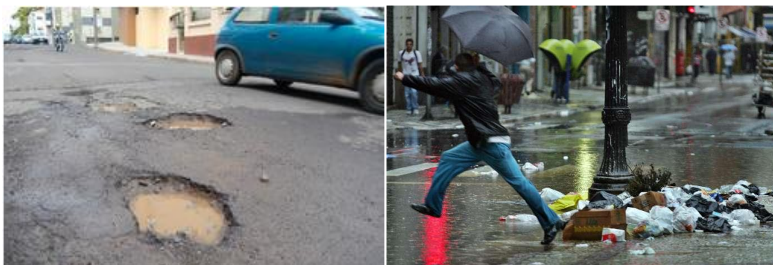
Figuras 18 e 19 - Desgaste de pavimento e acúmulo de resíduos no sistema de drenagem.
