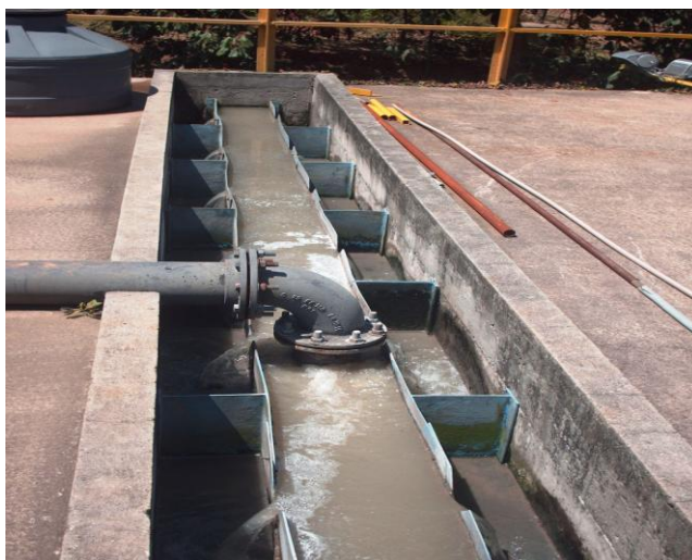
Calha de distribuição de esgoto para os reatores UASB.
