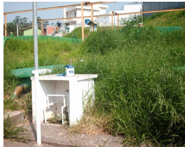
Vegetação encobrindo as unidades da ETE.
