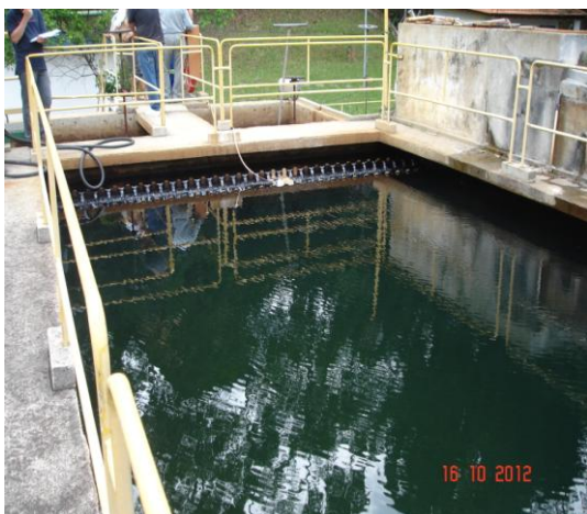
Calha de coleta do decantador e filtros.
