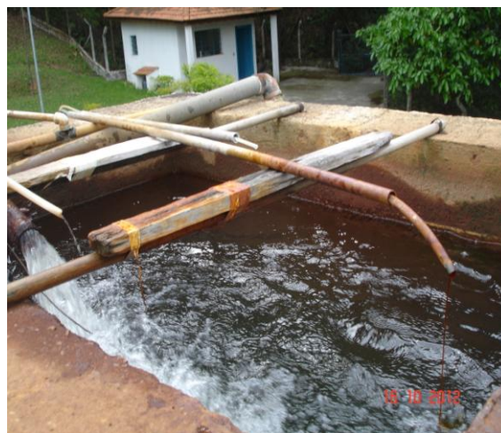
Aplicação de barrilha para ajuste de pH e cloreto férrico para coagulação na caixa de chegada da água bruta.
