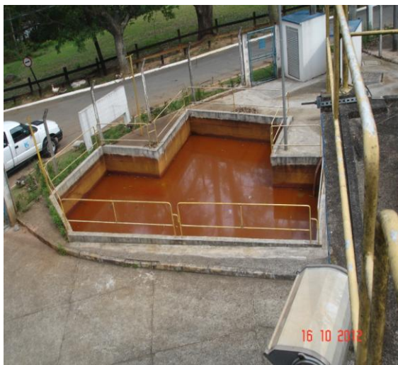
Reservatório de lodo do decantador.
