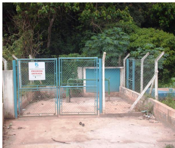
Vista das instalações do Poço 02 – São Pedro.
