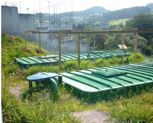
Vista dos reatores – ETE New Ville.
