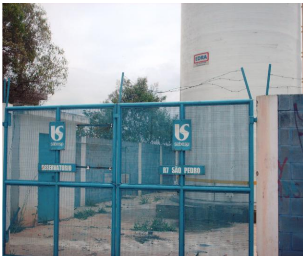
Vista do reservatório R7 - São Pedro e da EEAT R4 - São Pedro.
