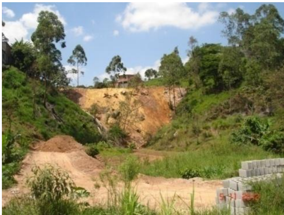
Figura 11 –Falta de proteção vegetal da encosta.
