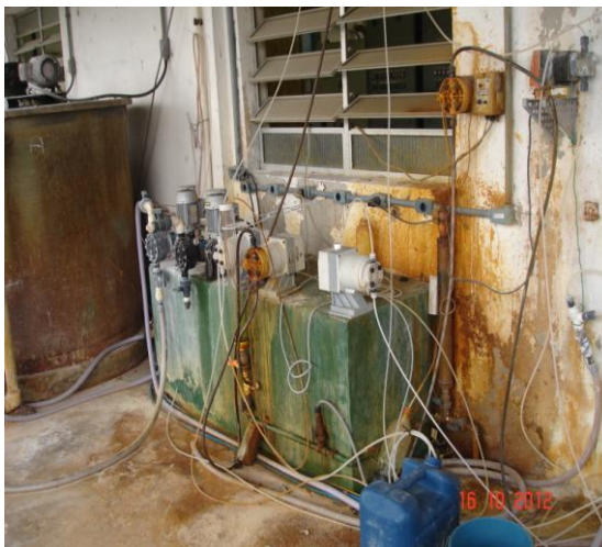
Bombas dosadoras de produtos químicos.
