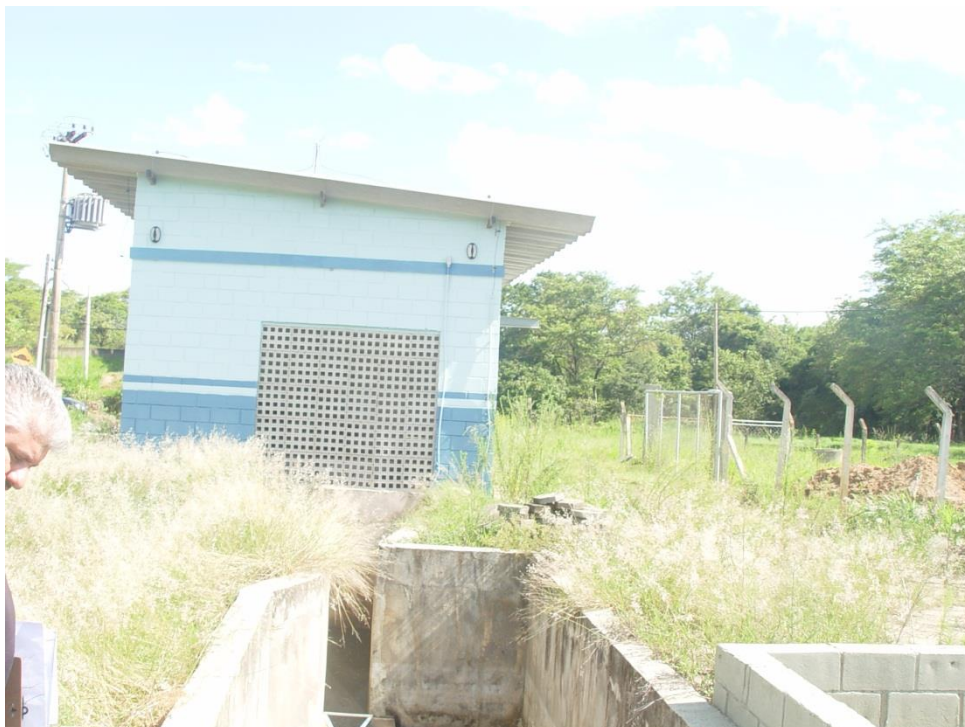
Foto - 65 Estação Elevatória de Esgotos Camanducaia
