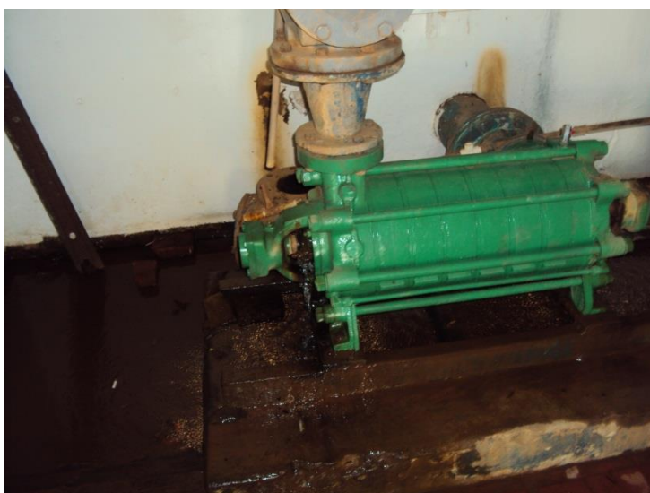
Foto 6 - Bomba da EEAB-1 apresentando muito vazamento de água
