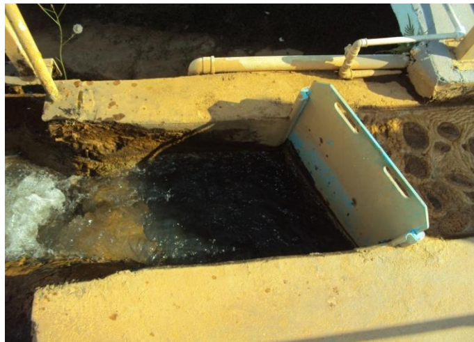
Foto 20 - Canal de chegada de água bruta
