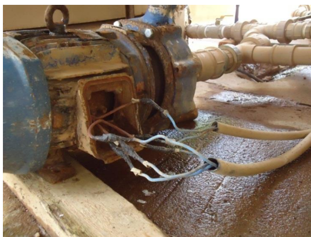
Foto 57 - ETA Rincão com fiação elétrica exposta
