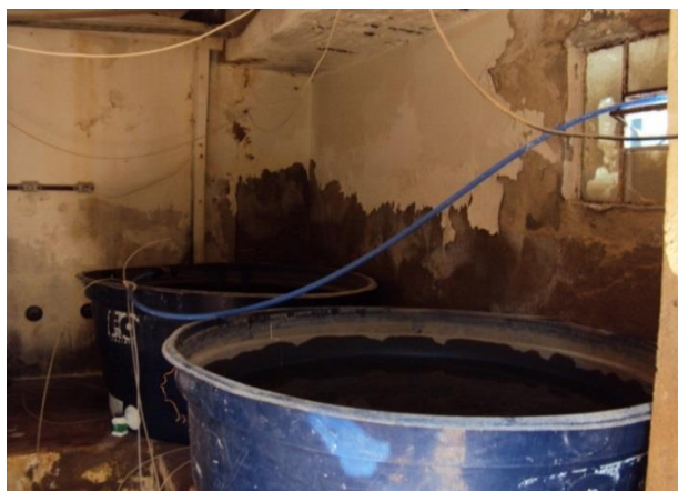
Foto 55 - Estado de conservação das paredes da sala de preparo de produtos químicos na ETA Centro
