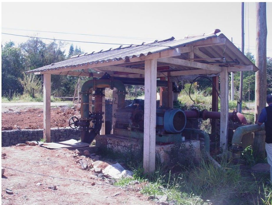
Foto 12 - Estação Elevatória de Água Bruta - EEAB-2
