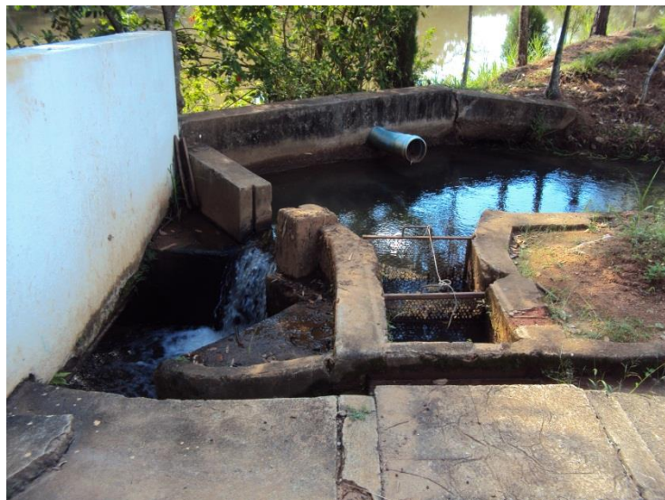
Foto 2 - Tomada de água da captação do Córrego Jequitibá - Benfica
