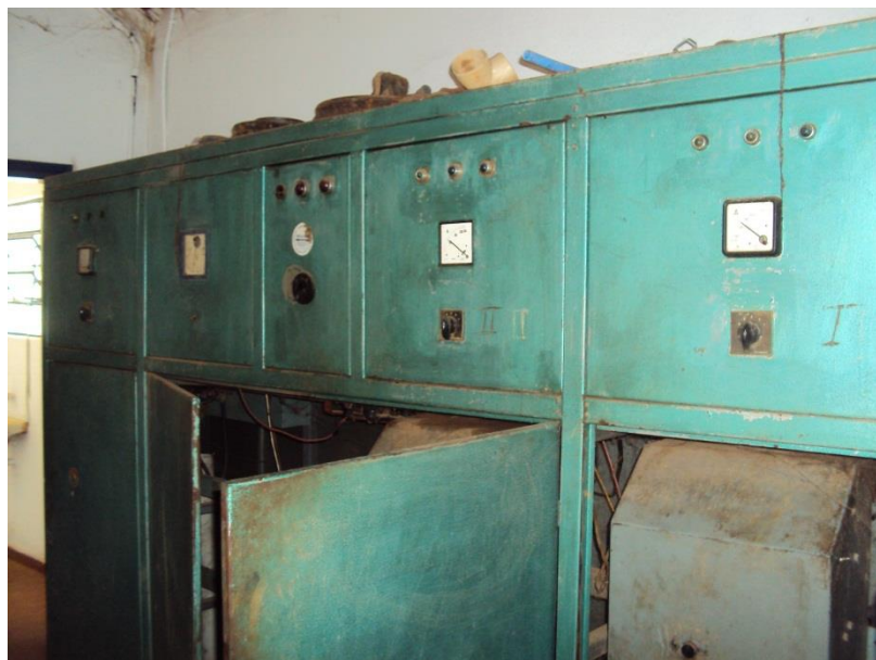
Foto 8 - Quadro de comando de motores, em péssimo estado de conservação
