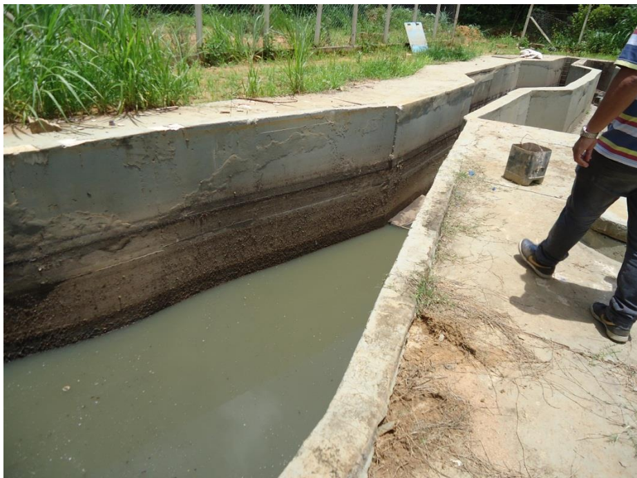
Foto 69 - Detalhe da Calha Parshall
