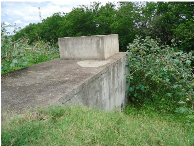
Foto 83 - Estrutura de lançamento do efluente no corpo receptor
