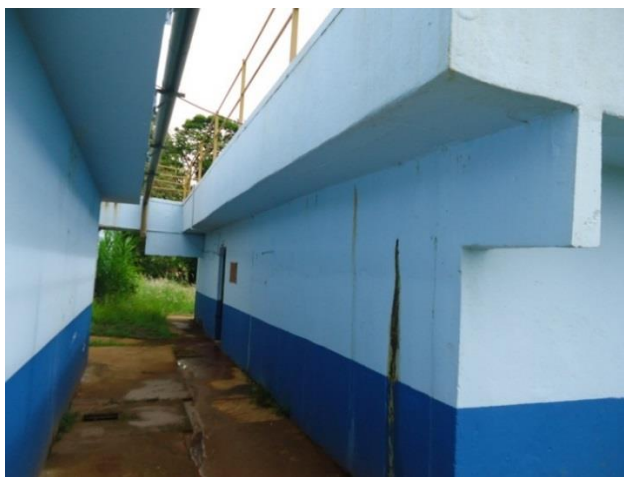
Foto 54 - ETA central - vazamento de água em parede
