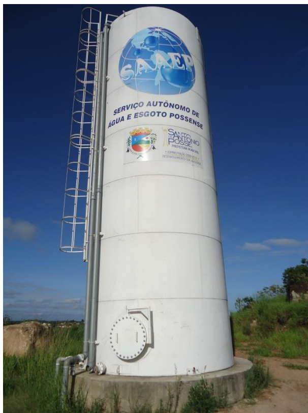
Foto 30 - Reservatório Bela Vista
