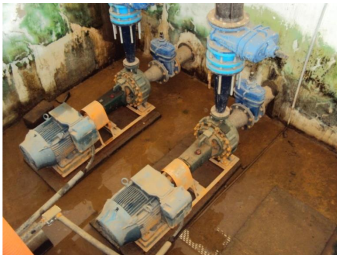
Foto 88 - Casa de bombas da EEE Barreiro em péssimo estado de conservação
