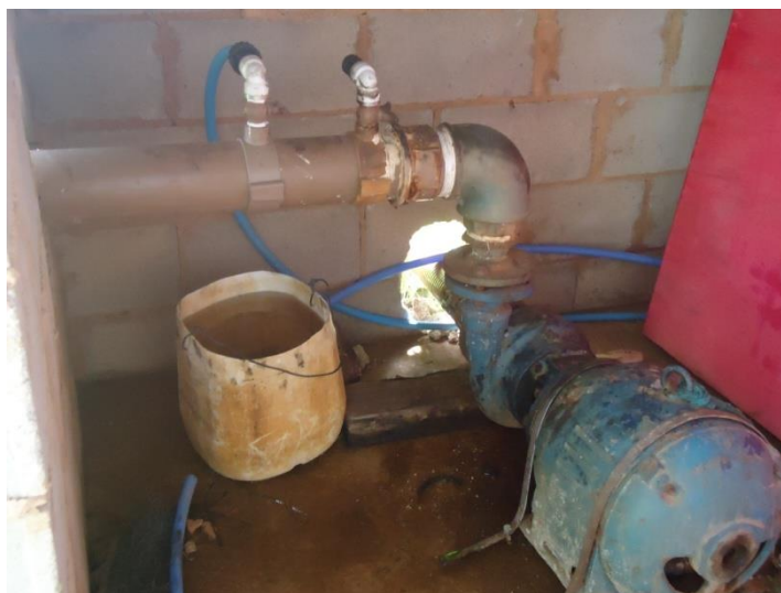
Foto 53 - Interior da Captação do Lambari sem conservação
