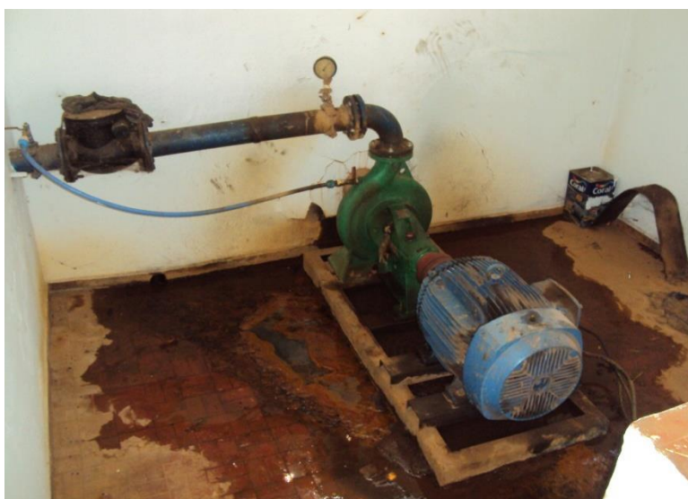
Foto 7 - Outra unidade de bombeamento instalada em pisos diferentes
