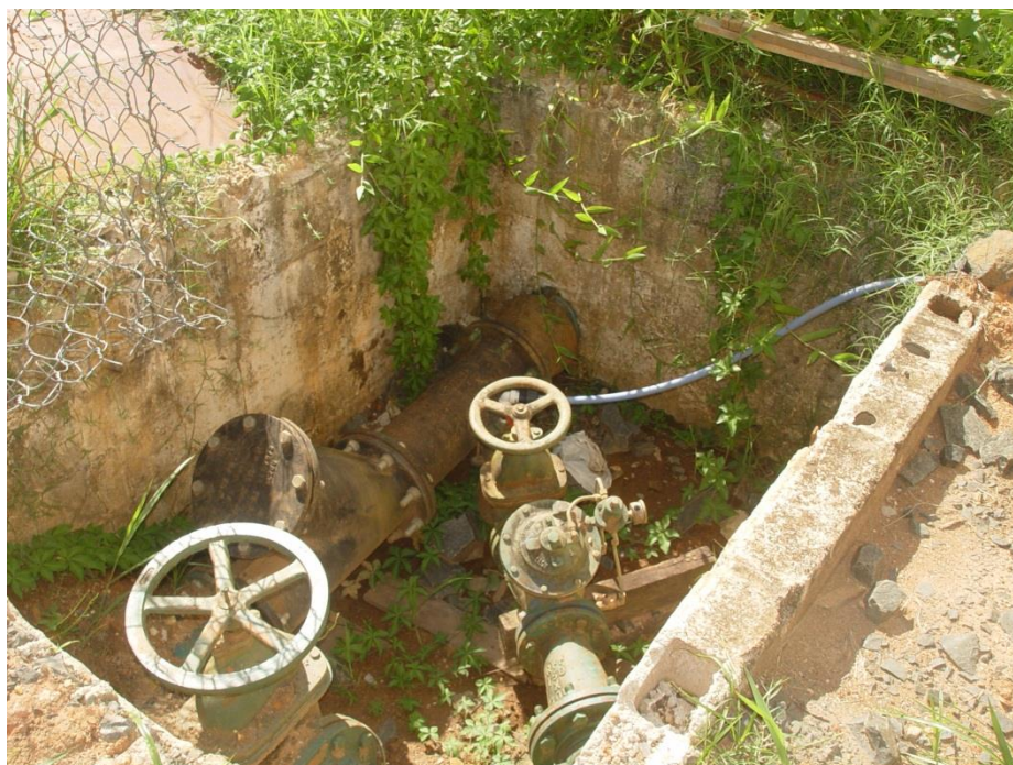
Foto 13 - Barrilete de recalque da EEAB-2
