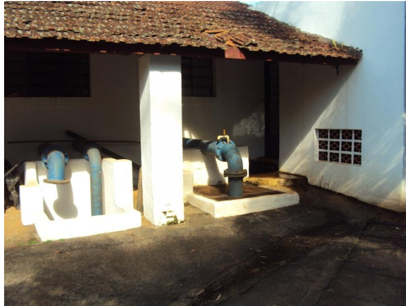
Foto 4 - Poços de sucção da EEAB-1
