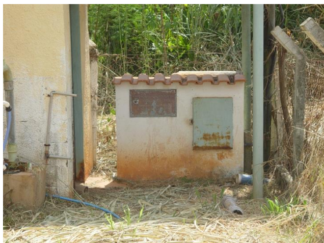
Foto 36 - Quadro de comando - Poço Vale Verde
