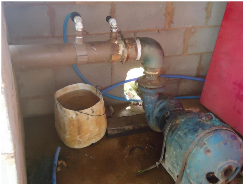
Foto 44 - Bomba da EEAB-4
