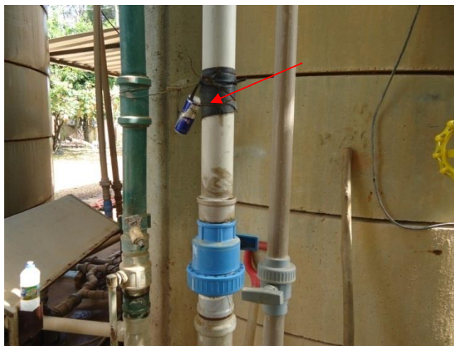
Foto 58 - Utilização de material inadequado para a substituição de uma luva
