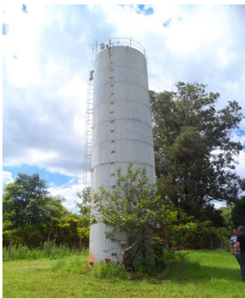
Foto 59 - Reservatório Monte Belo precisando de manutenção
