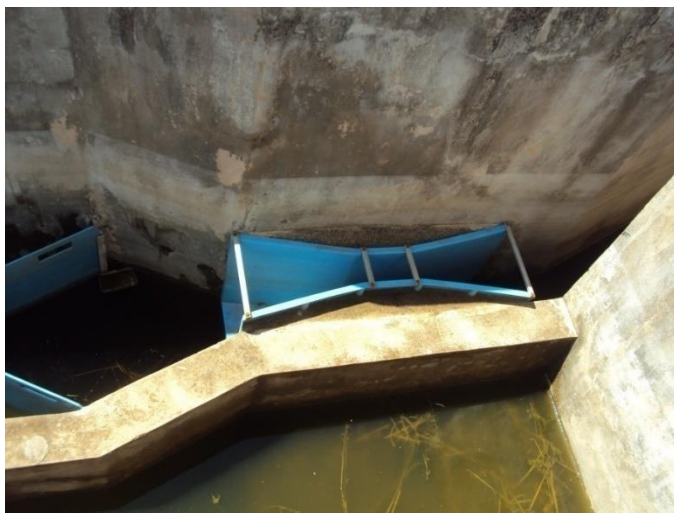
Foto 89 - Calha Parshall e canal ao lado cheio de água, quando deveria estar seco
