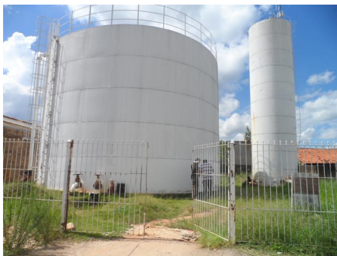
Foto 61 - Reservatório Pedra Branca II, mato sem cortar e falta de pintura na grade de fechamento (2014)
