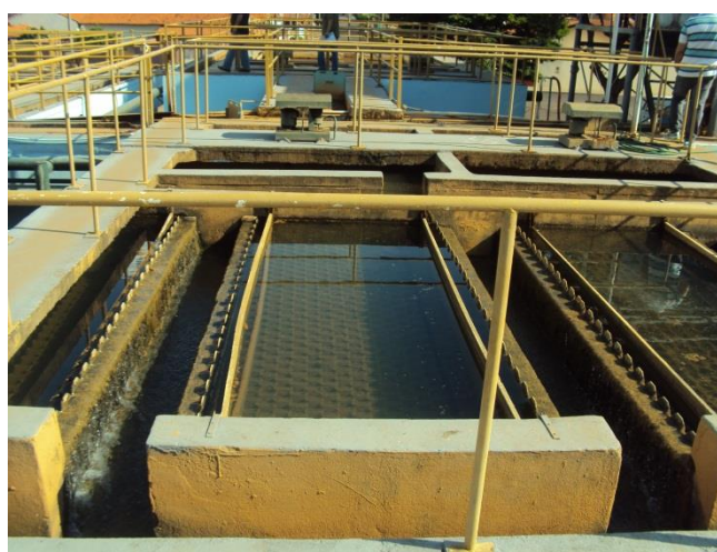
Foto 22 - Decantador da ETA 2
