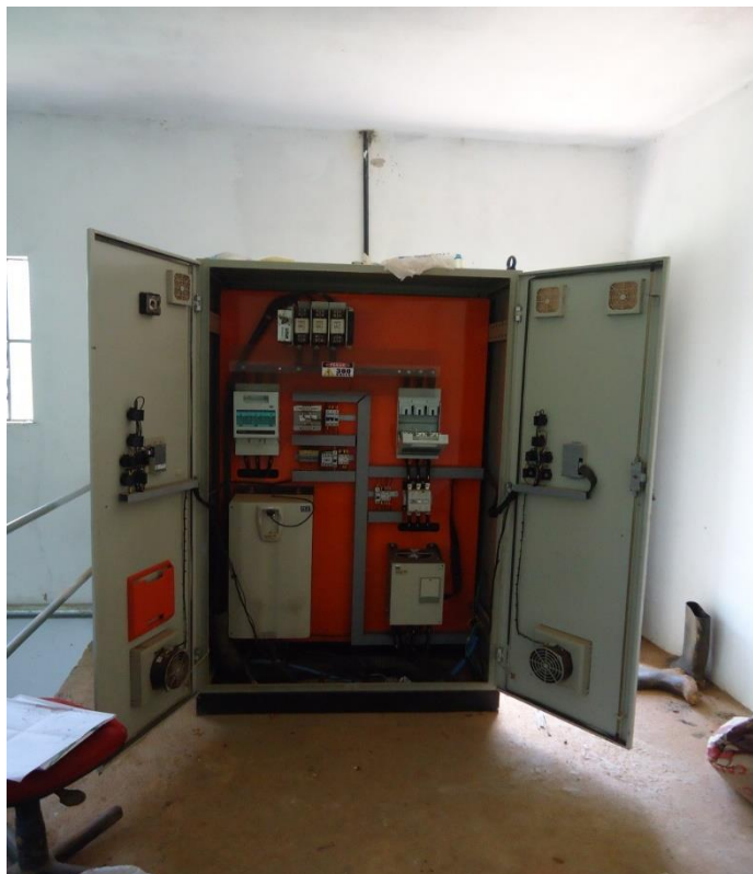
Foto 70 - Quadro de comando
