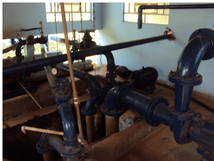
Foto 23 - Estação Elevatória de Água Tratada 1
