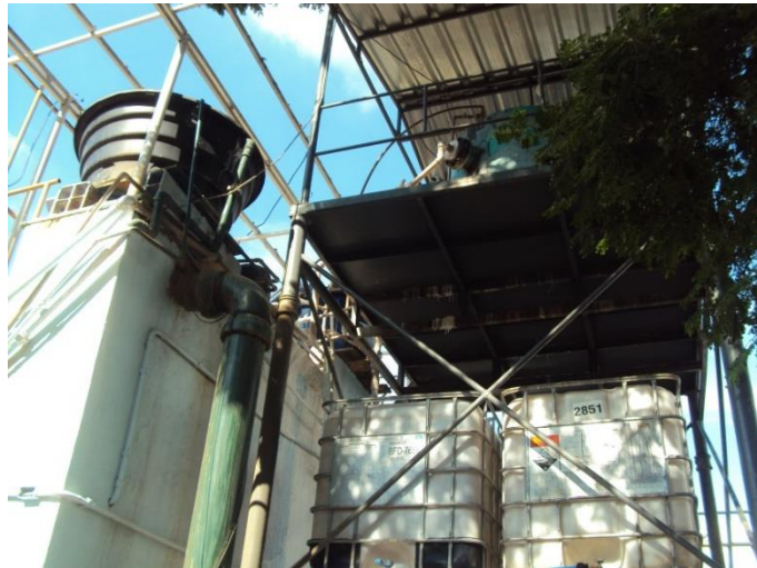
Foto 19 - Entrada de água bruta na ETA
