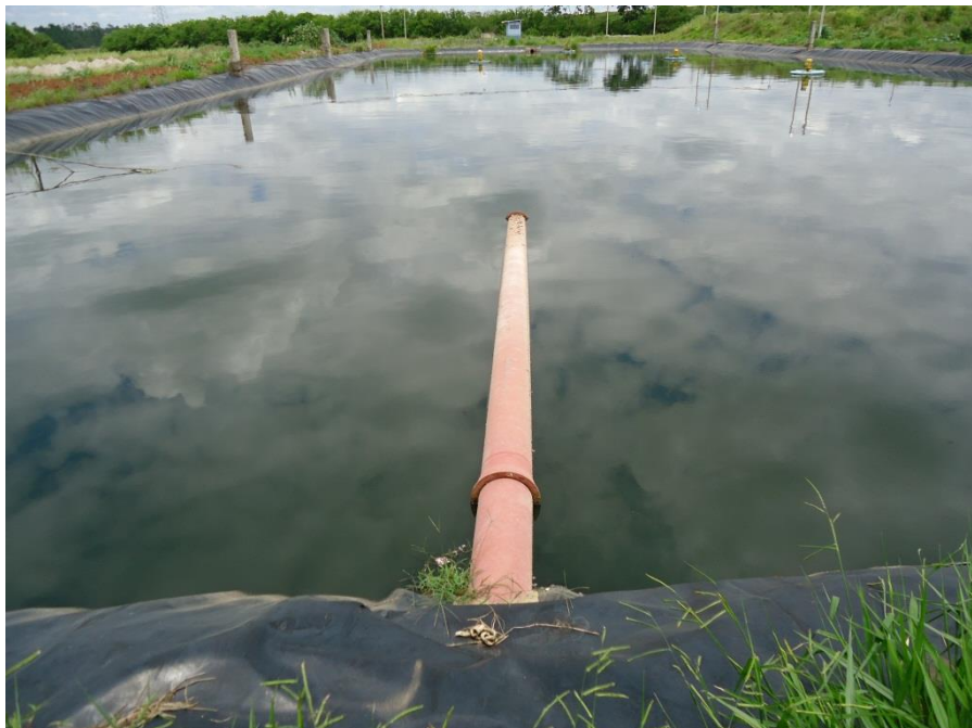
Foto 75 - Dispositivo de entrada de efluentes na Lagoa Aerada, cujos aerados não estão operando
