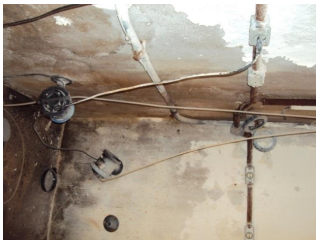
Foto 56 - Estado de conservação das fiações da sala de preparo de produtos químicos na ETA Centro
