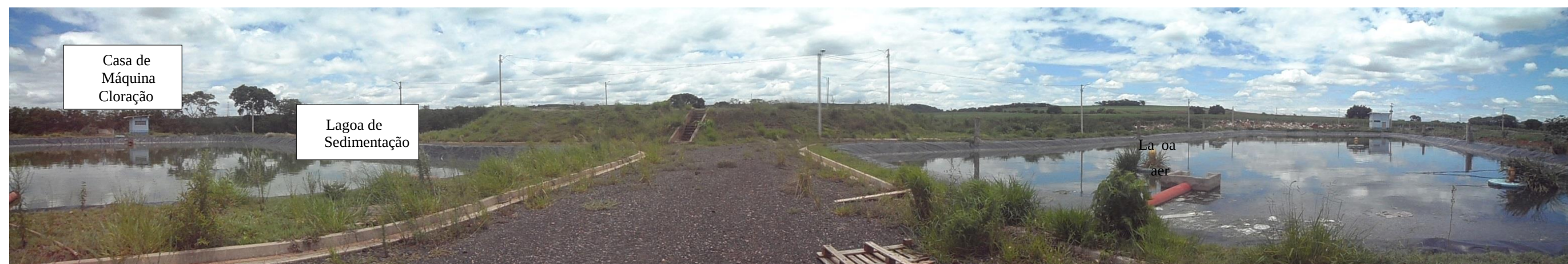
Foto 74 - Vista geral da ETE - Lagoas aerada e de sedimentação
