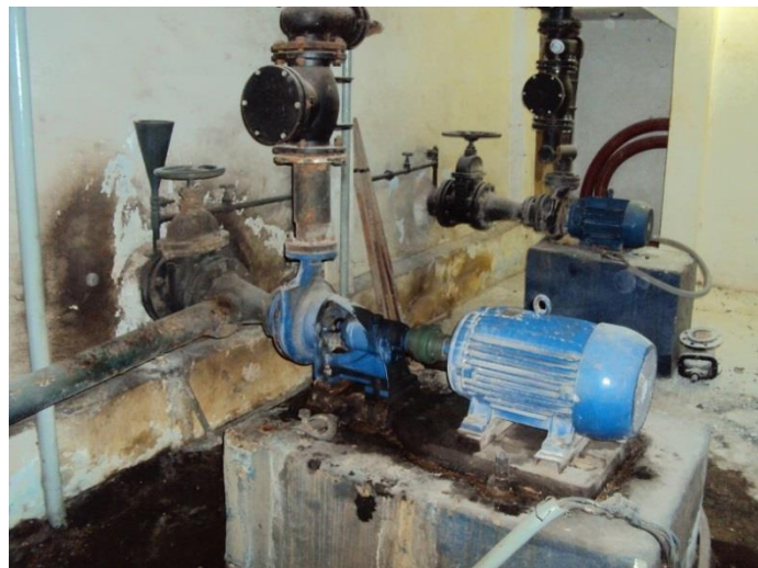
Foto 24 - Estação Elevatória de Água Tratada 2
