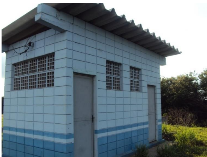
Foto 86 - Casa de cloração fora de operação por falta de equipamentos
