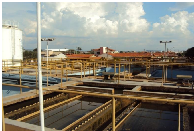
Foto 21 - Vista geral das ETAs 1,2 e 3
