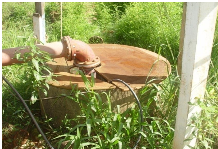
Foto 51 - Captação do Camanducaia - falta de manutenção no corte do mato
