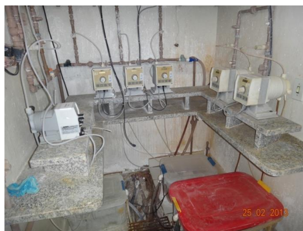
Foto 4.4 - ETA I - Dosadores.
