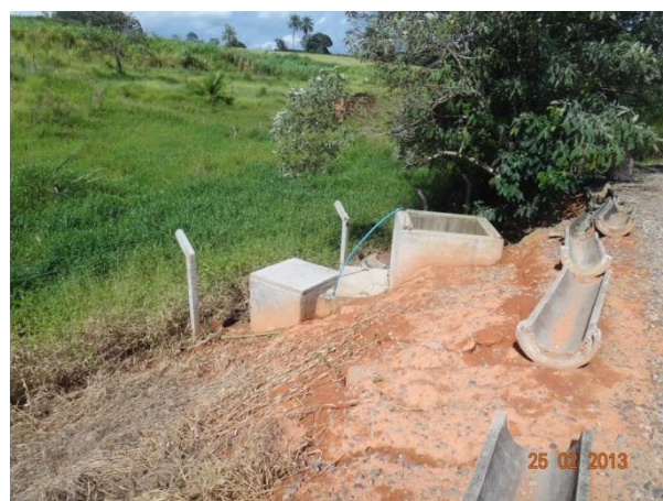
Foto 4.12 - Caixa de saída antes do emissário final
