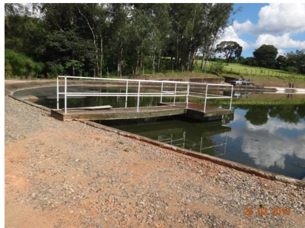
Foto 4.10 - Saída do esgoto tratado - Lagoa Facultativa
