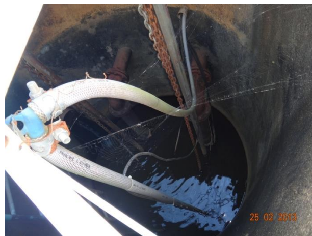
Foto 4.2- Poço de Sucção - EEAB1.
