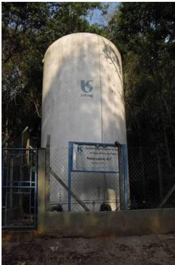
Foto 03 - Reservatório R.7 – Zona Alta.
