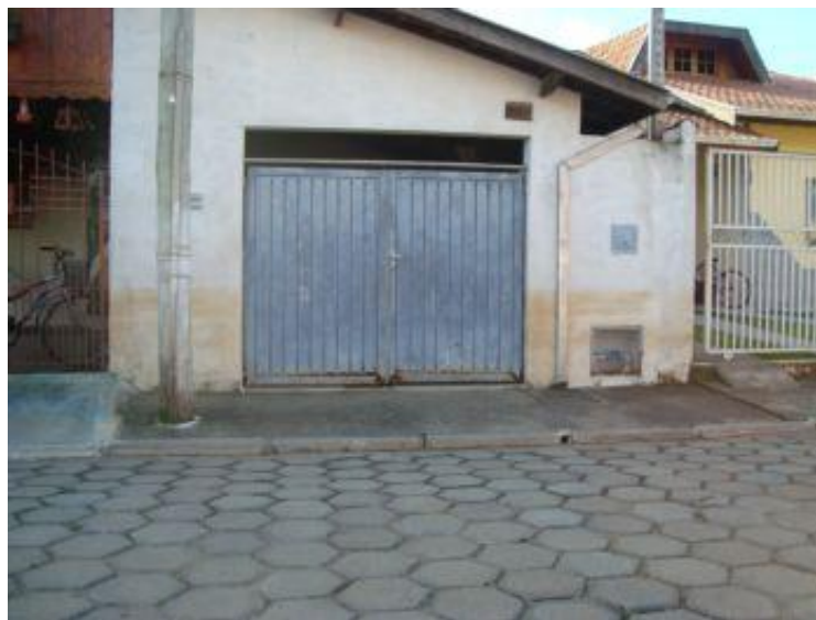
Foto 11.1-1: Marca de inundação em parede de residência na Rua Projetada 1 devido à chuva ocorrida no dia 15 de fevereiro de 2009
