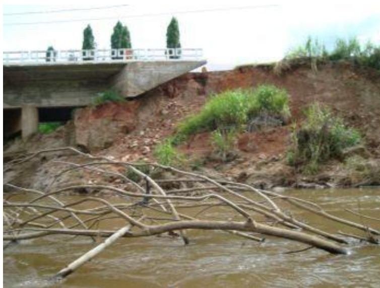
Foto 11.1-3: Erosão na margem do Rio Sapucaí-mirim junto à ponte da Rodovia Júlio da Silva com vista para jusante.
