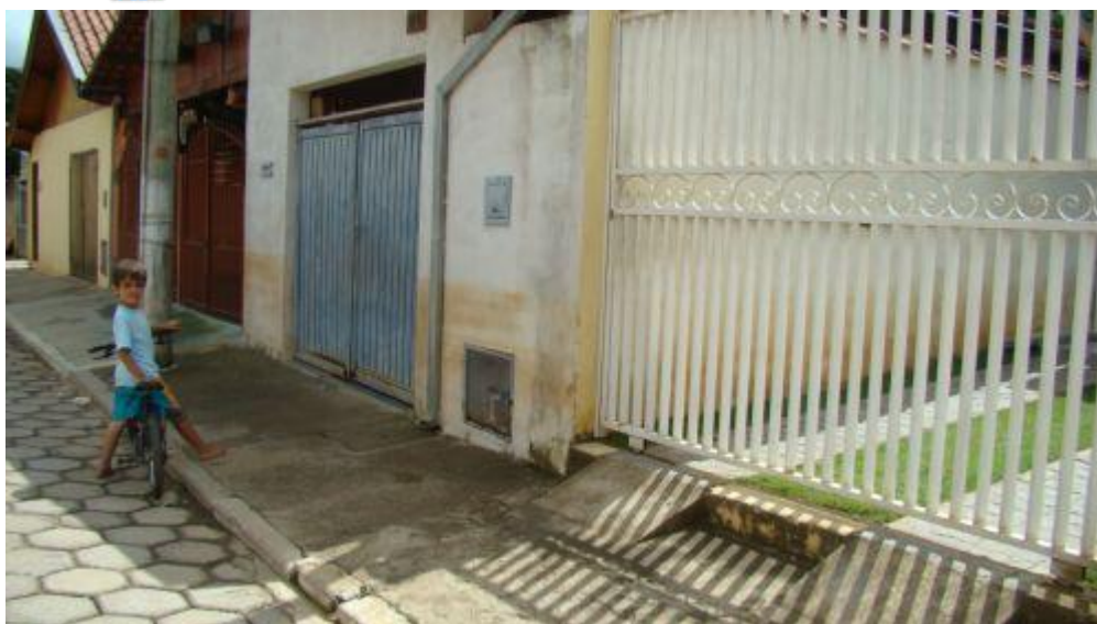
Rua projetada onde se pode ver a marca atingida pelas inundações na parede da residência
