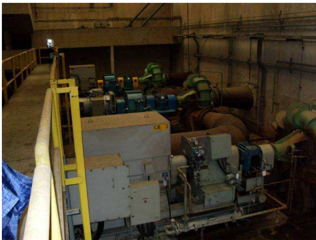
Figura 161 - Conjuntos Moto-Bomba de 950 CV
