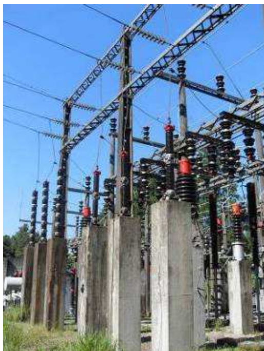
Figura 113 - Alimentação da SE – Circuito Duplo 88 kV
