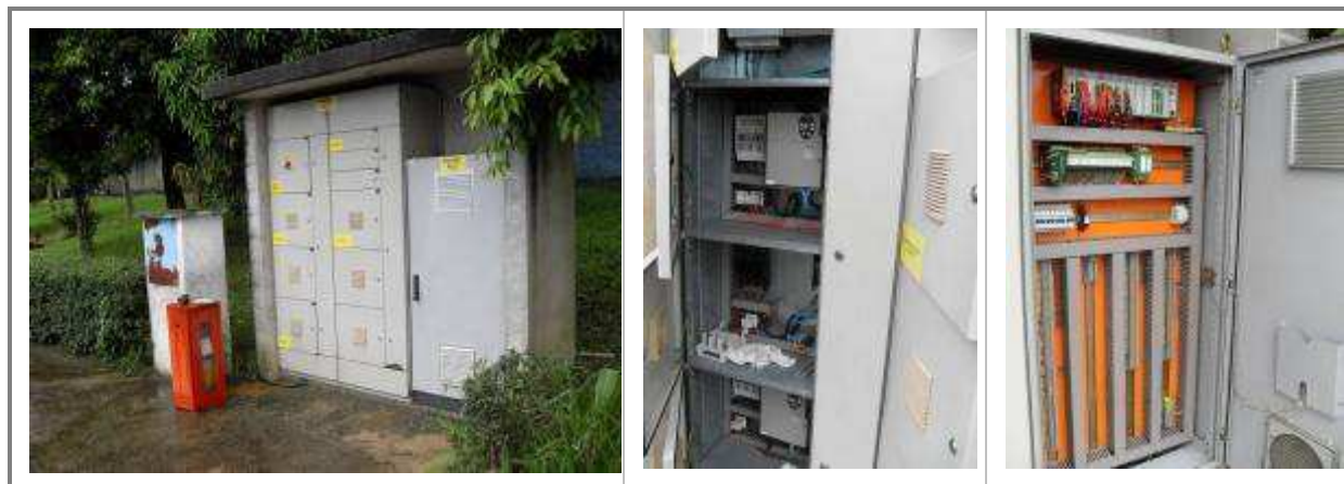
Figura 151 - CCM e Painel do CLP
