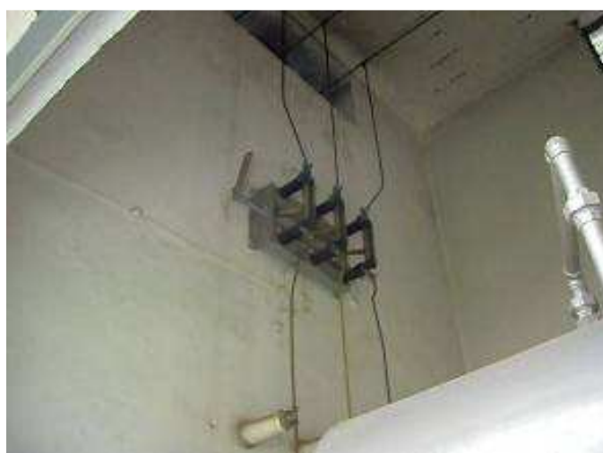
Figura 148 - Chave seccionadora sem fusíveis
