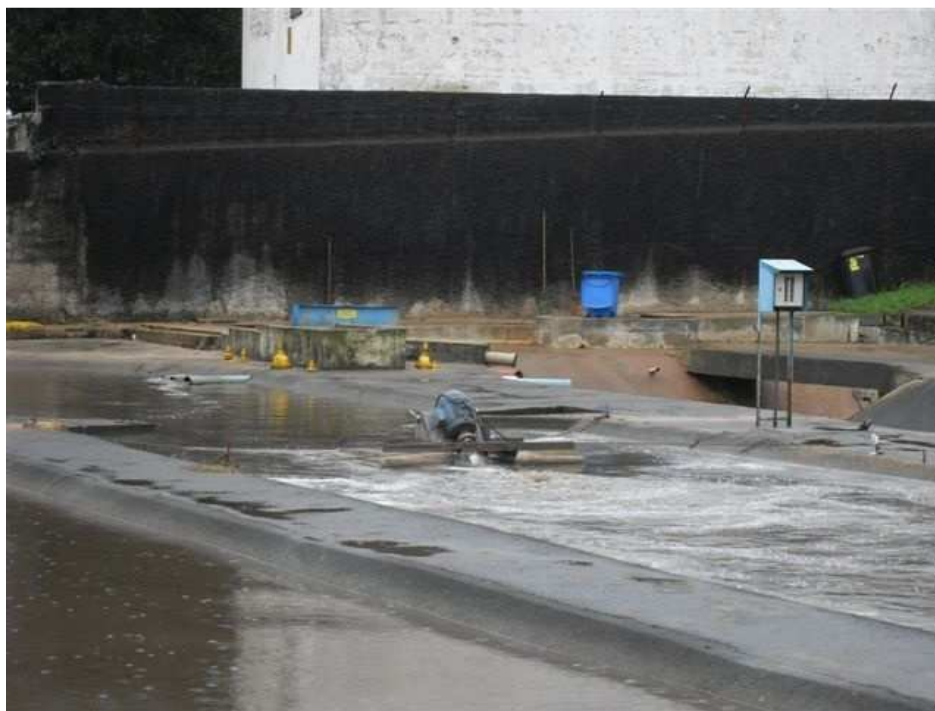
Figura 106 - Valo de oxidação da ETE Riacho Grande
