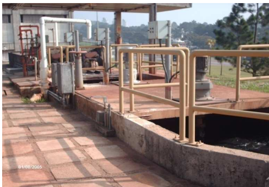
Figura 99 - Vista do sistema de floculação química do lodo digerido
