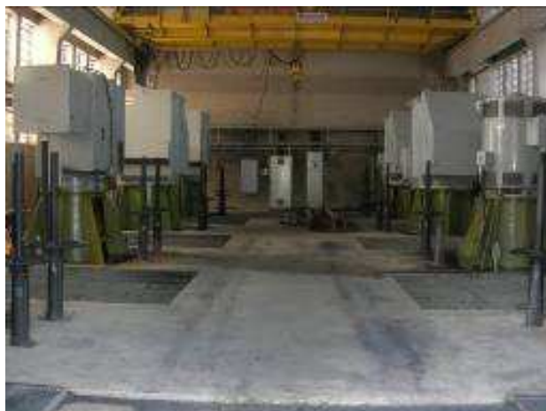
Figura 130 – Casa de bombas
