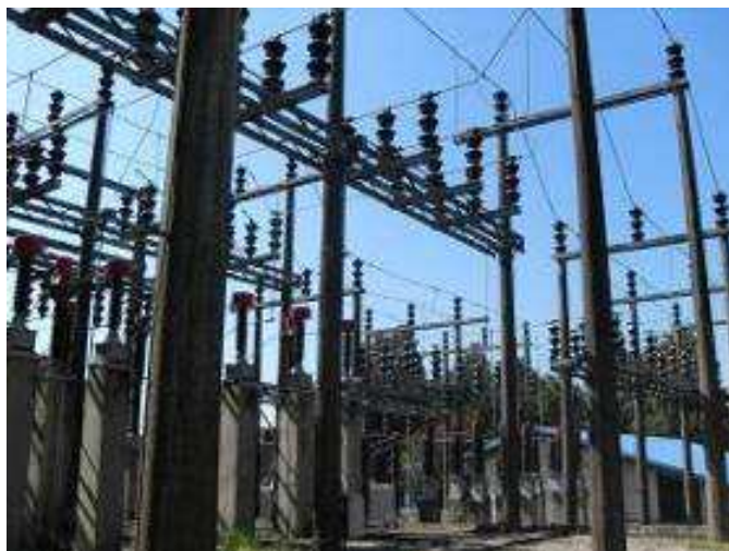
Figura 119 - Vista da SE e Sala de Controle
