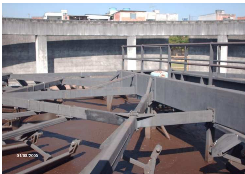
Figura 96 - Vista de um flotador da ETE ABC
