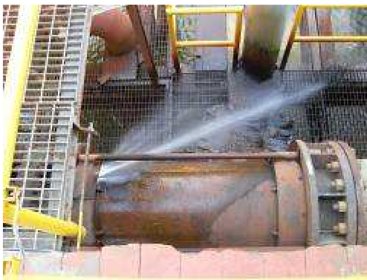
Figura 133 - Vazamento no Recalque
