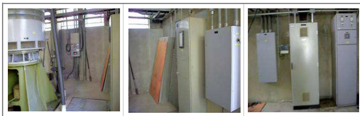
Figura 132 - Painéis da Controle, Automação e Serviços Auxiliares.
