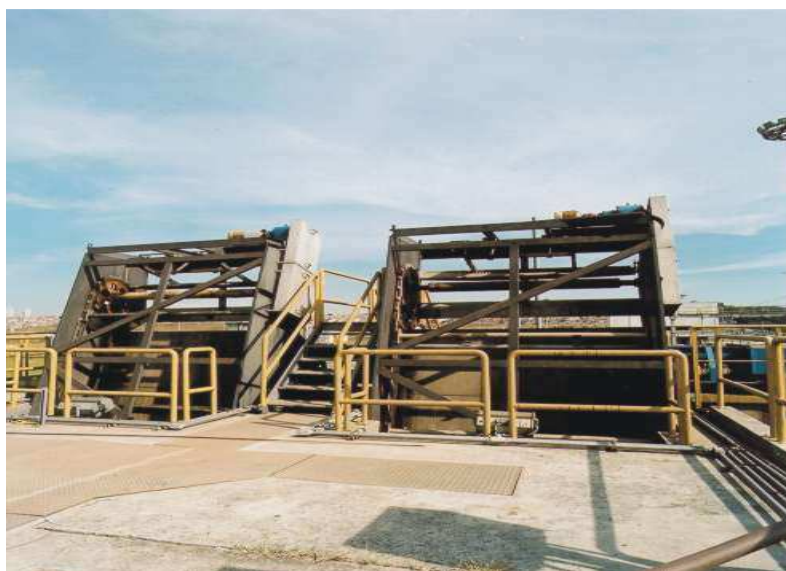
Figura 91 - Vista do gradeamento médio da ETE ABC
