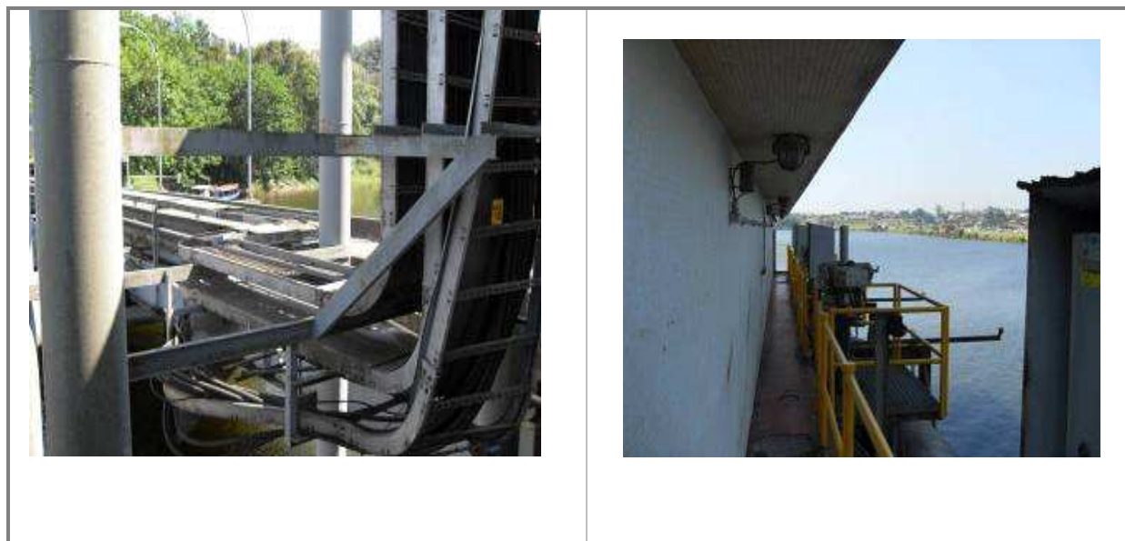
Figura 131 - Cabos de Energia na Elevatória/Casa de Bombas
