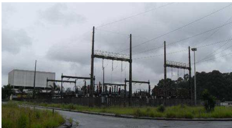
Figura 156 - Entrada da SE com Circuito Duplo
