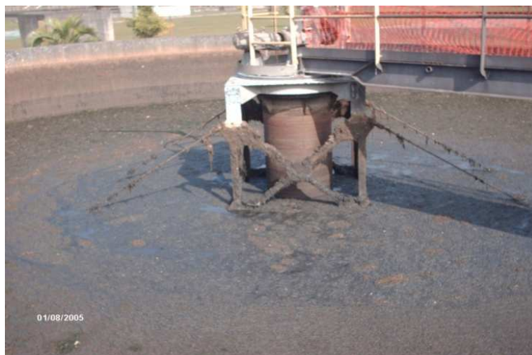
Figura 100 - Tanque de lodo condicionado
