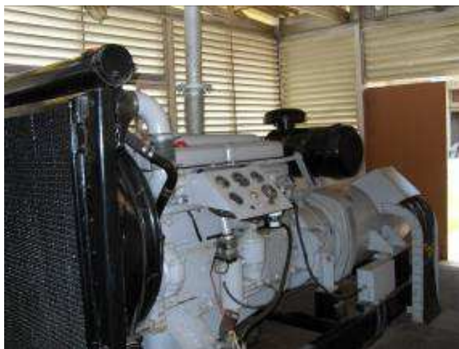
Figura 149 - Gerador de Emergência
