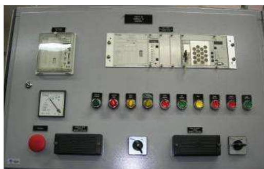
Figura 126 – Painel dos relés de proteção
