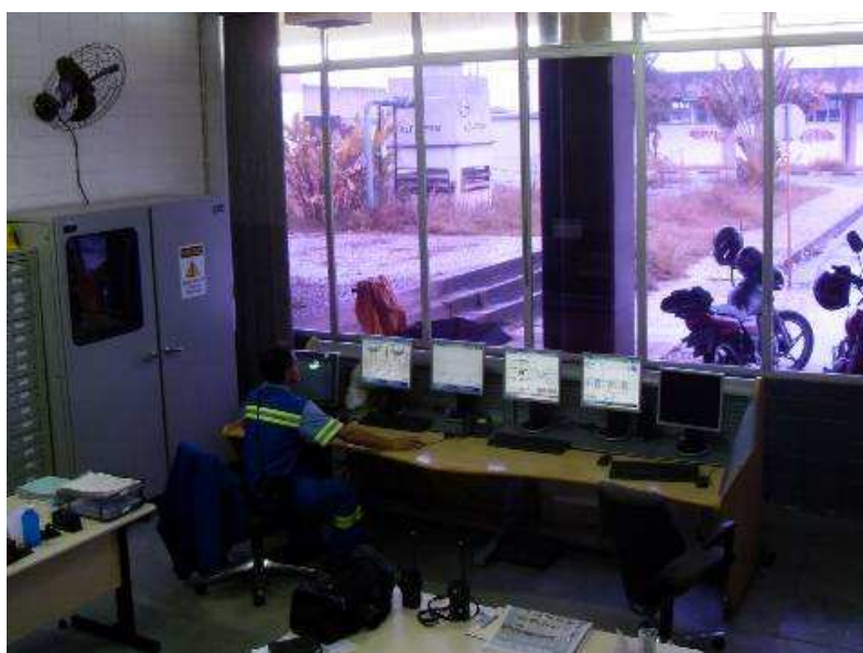
Figura 160 - Vista do SCC Local
