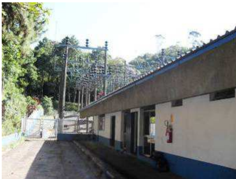
Figura 112 - Casa de Controle e Subestação
