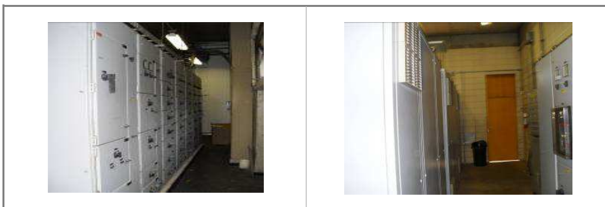
Figura 143 - Painel de Distribuição de Serviços Auxiliares
