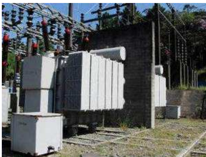
Figura 114 - Trafo e resistor de aterramento
