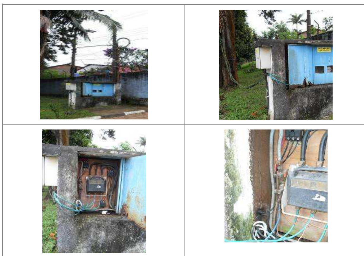
Figura 150 – Entrada de Energia
