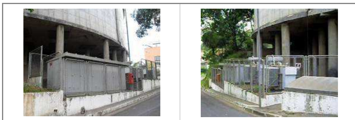
Figura 134 - SE da ETA Nova, em Cabine Blindada
