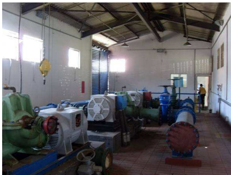
Figura 174 - Vista das Moto-Bomba de 430 CV, 1730 rpm
