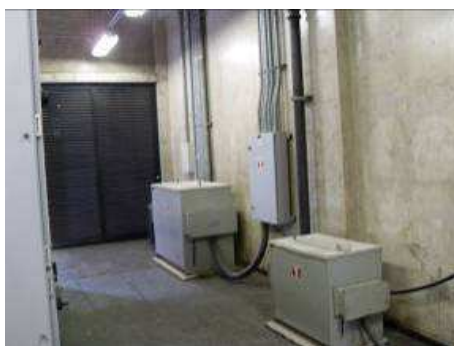
Figura 142 – Trafos da Casa de Química
