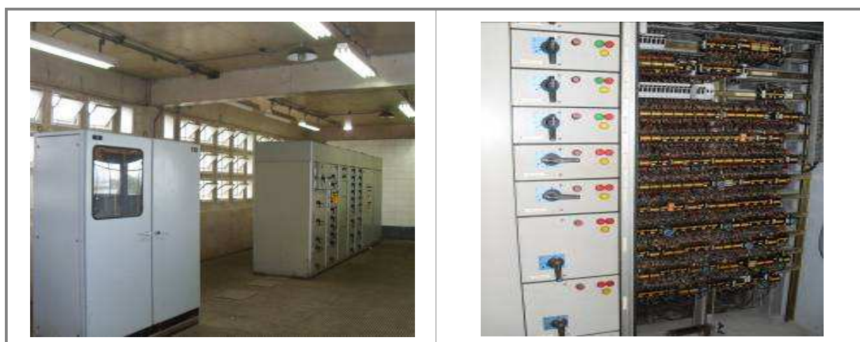
Figura 169 – Sala de Controle e Painéis
