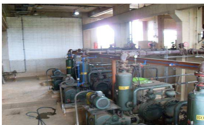
Figura 168 - Bombas com Alta Incidência de Manutenção
