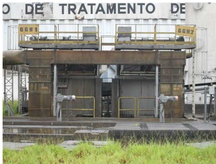
Figura 90 - Vista do gradeamento grosseiro da ETE ABC
