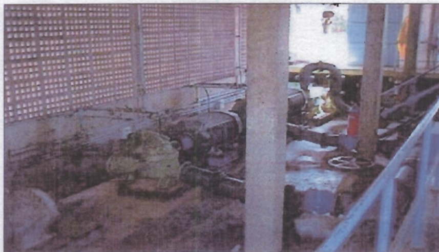
Foto 3 - Elevatória de água bruta
