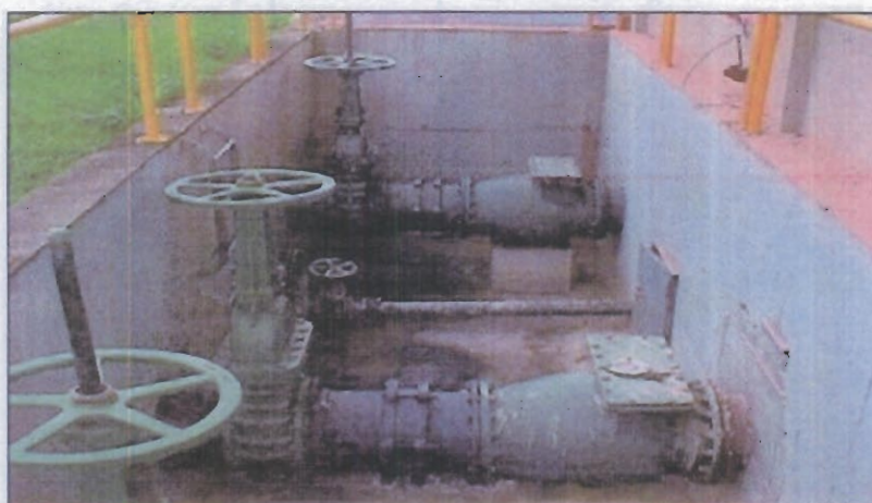
Foto 25 - EEE Final - Barrilete de recalque
