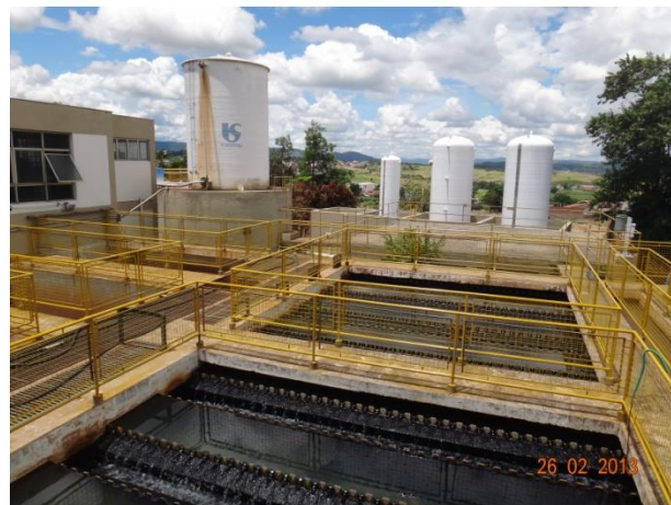
Foto 4.6 - Decantadores tubulares - ETA
