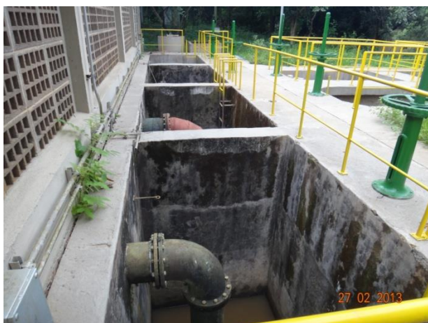
Foto 4.3 - Poço de sucção - EEAB1.
