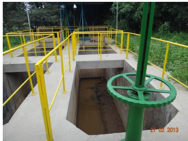
Foto 4.2 - Caixa de areia - Canal de tomada.
