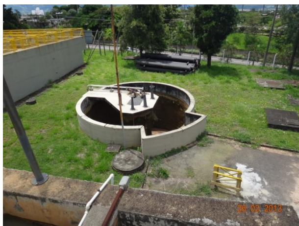
Foto 4.9 - Tanque de recuperação da água de lavagem dos filtros.
