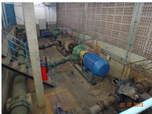
Foto 4.4 - Casa de bombas - EEAB1.
