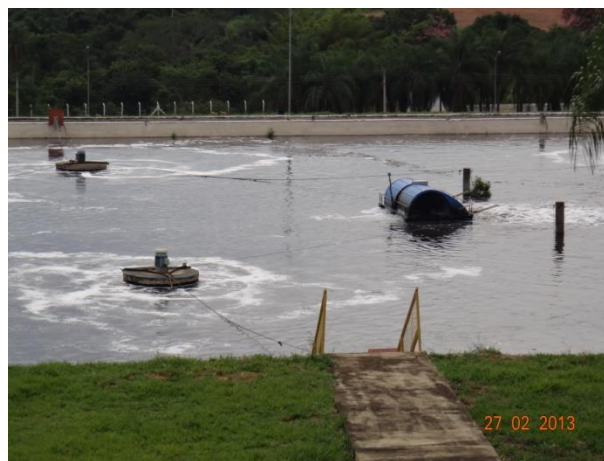
Foto 4.13 - Aeradores - Lagoa Aerada
