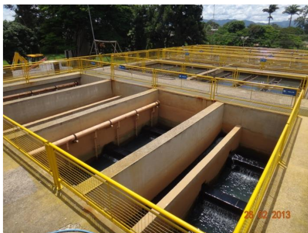
Foto 4.7 - Filtros rápidos - ETA
