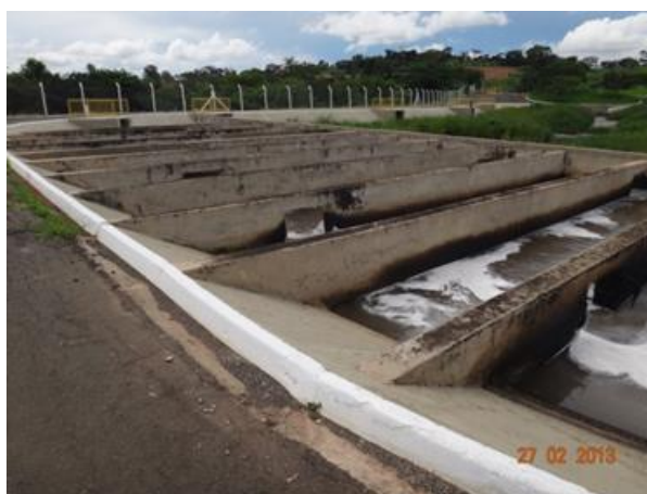
Foto 4.16 - Tanque de Contato
