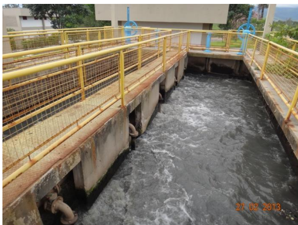
Foto 4.12 - Entrada do esgoto bruto - Caixa de Areia Aerada
