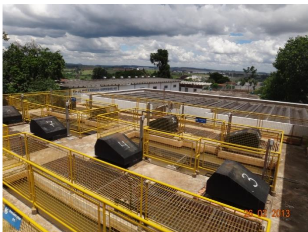
Foto 4.5 - Flocladores mecânicos - ETA
