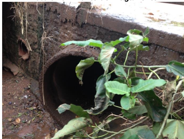
Foto 3.21 – Ponto de alagamento e caixa de passagem
