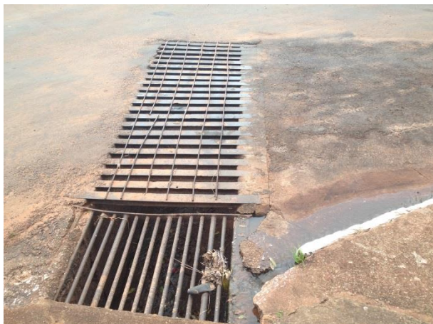
Foto 3.18 – Ponto de Alagamento
