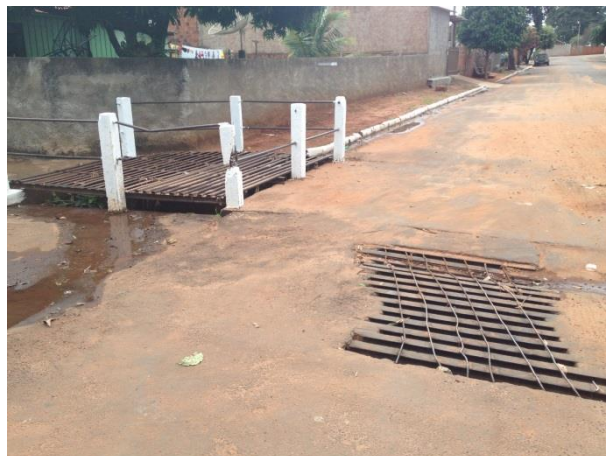
Foto 3.19 – Ponto de Alagamento
